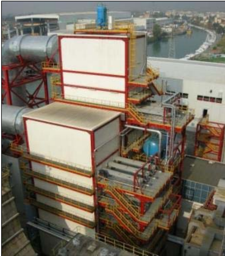
Figura 2: vista dell'impianto di desolforazione
