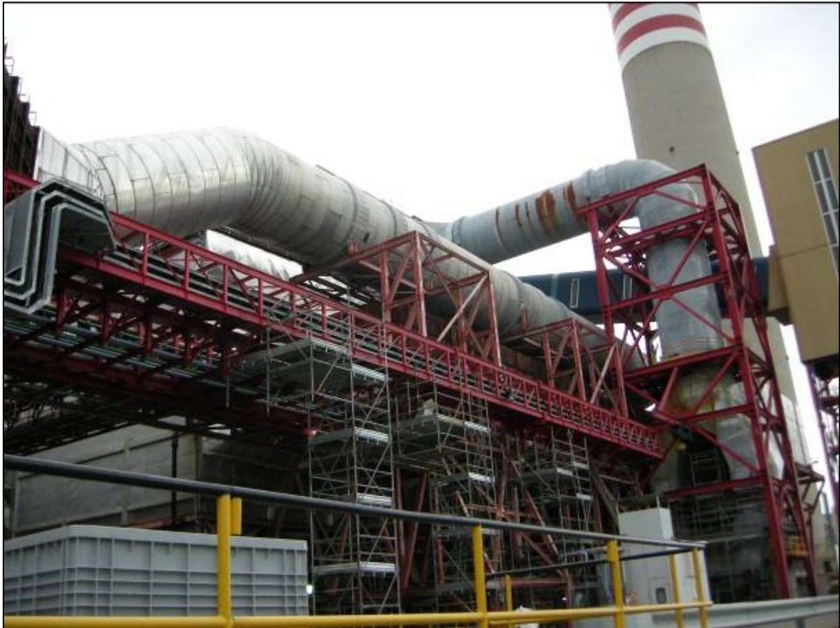
Figura 9: vista condotti DeSOx
