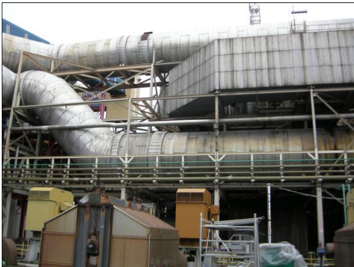
Figura 10: vista condotti DeSOx
