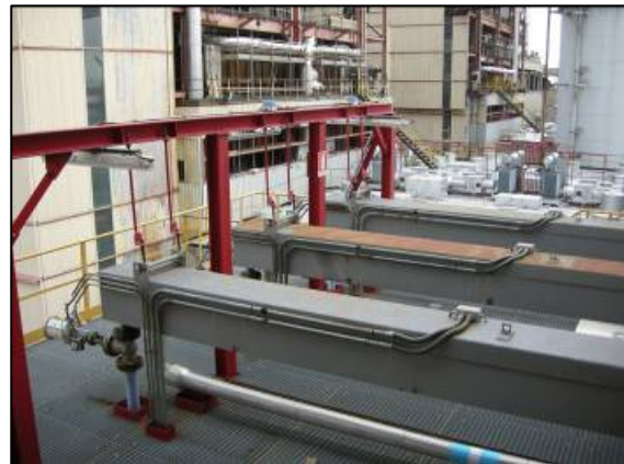
Figura 7: vista impianto soffiatura
