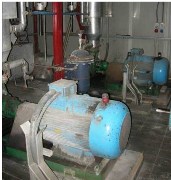
Figura 15: vista pompa scambiatori GGH
