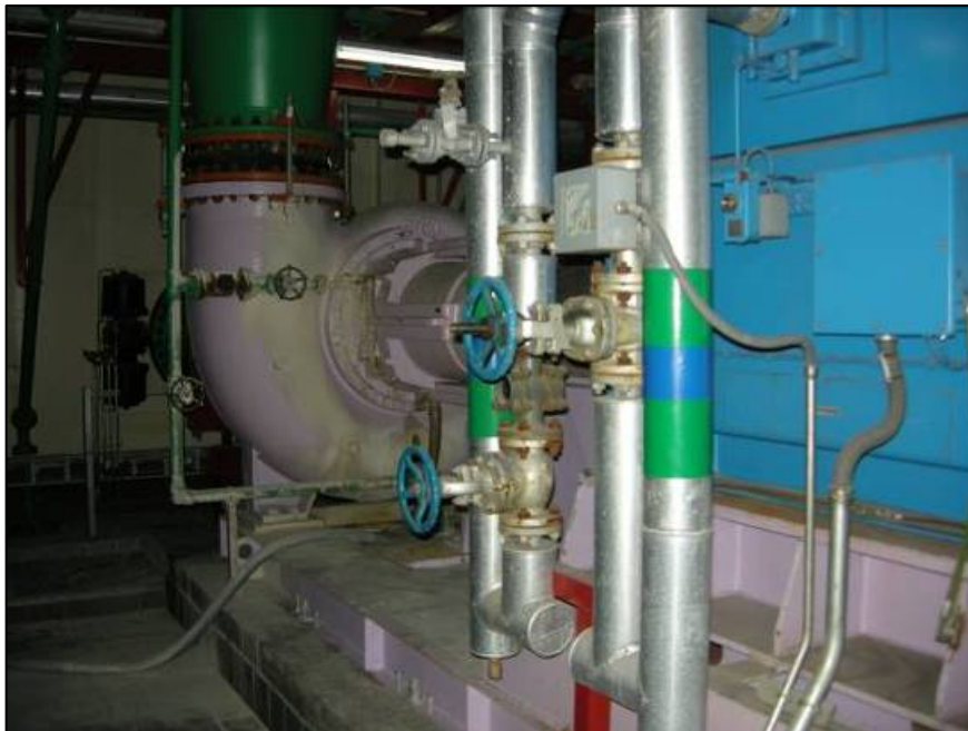
Figura 14: vista pompa ricircolo assorbitore
