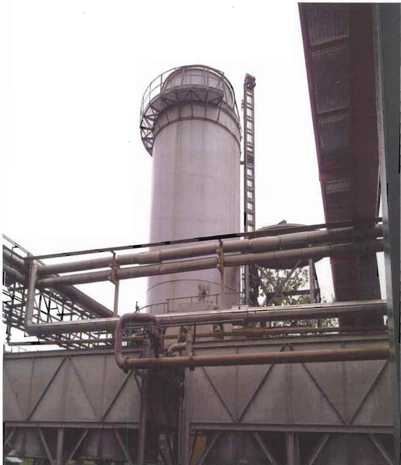
Particolare di un punto di emissione fumi in atmosfera.
