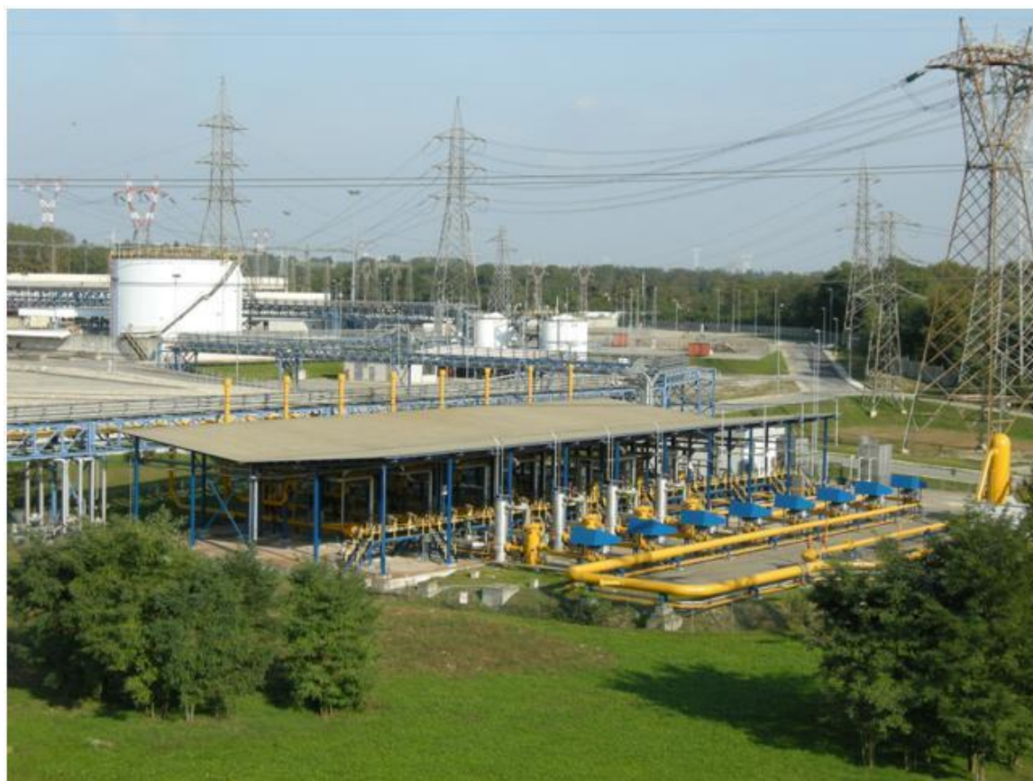
STAZIONE DI DECOMPRESIONE METANO
