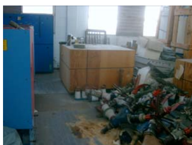
sottostazione III 30kV
