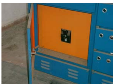
cabina 36 quadro BT tipo MCC arrivo linea sospetta presenza un interruttore SACE vedi SS III 10kv
