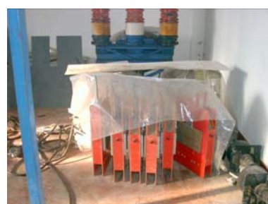
SSI10kV primo piano
