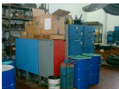
Torre di smontaggio SSI 150 KV
