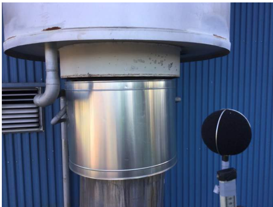
FOTO 5 – PARTICOLARE DEL RACCORDO TRA TUBO-CAMINO E SILENZIATORE (PUNTO DI MAGGIORE EMISSIONE SONORA)
