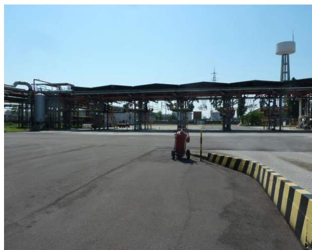
Foto 4. ZNE - Pensiline carico ATB
