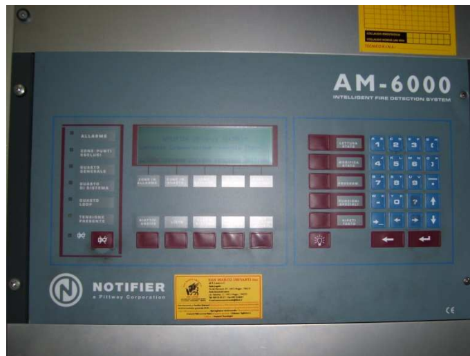
Figura 2 – quadro di controllo AM-6000
