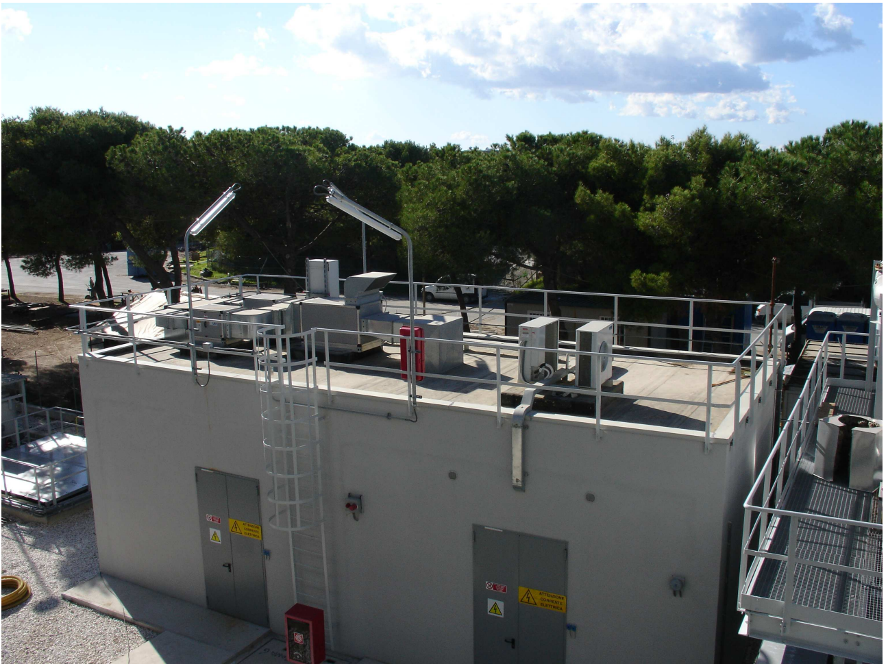
Edificio elettrico HRSG
