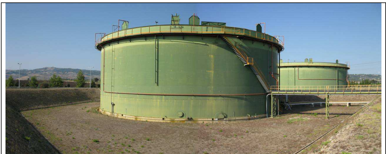
Figura 2 - Serbatoi di stoccaggio e relativo bacino di contenimento
