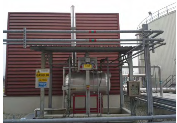
Rilievo fotografico - gasolio motopompa antincendio
