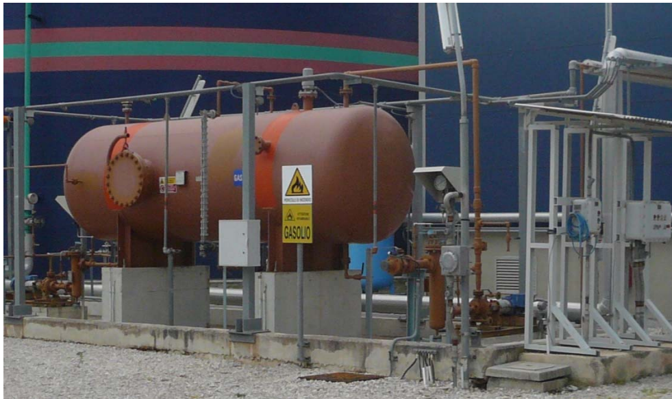
Serbatoio generale da 10 m 3
