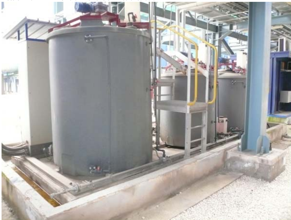
Foto 5.1.4b Skid di iniezione chimica di caldaia
