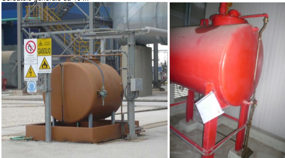
Serbatoio gruppo elettrogeno 1 m 3
