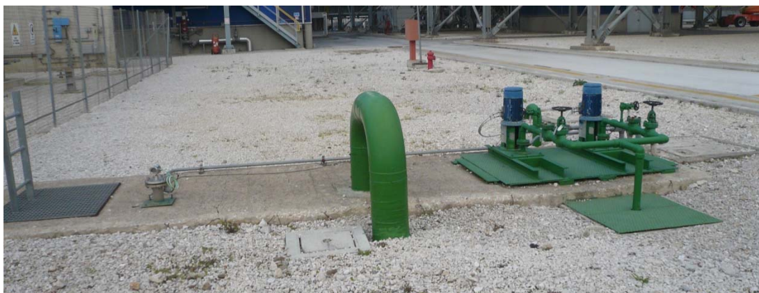
Vasca di raccolta olio trasformatori
