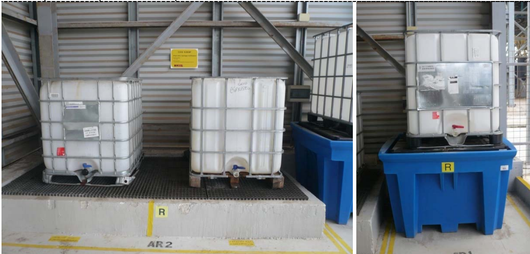
Deposito oli esausti
