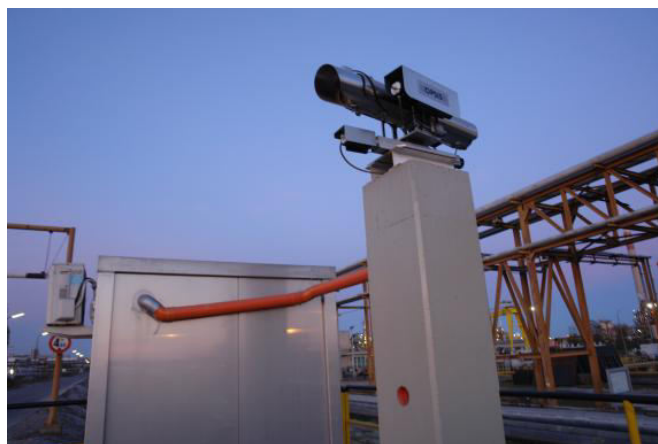
Ricevitore e cabina di alloggiamento apparecchiature
