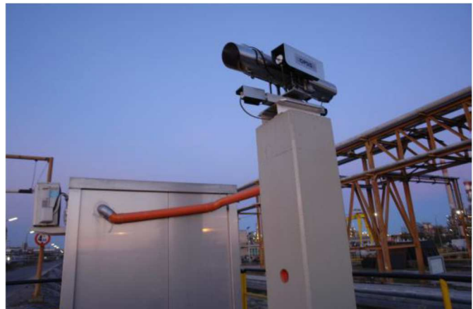
Ricevitore e cabina di alloggiamento apparecchiature
