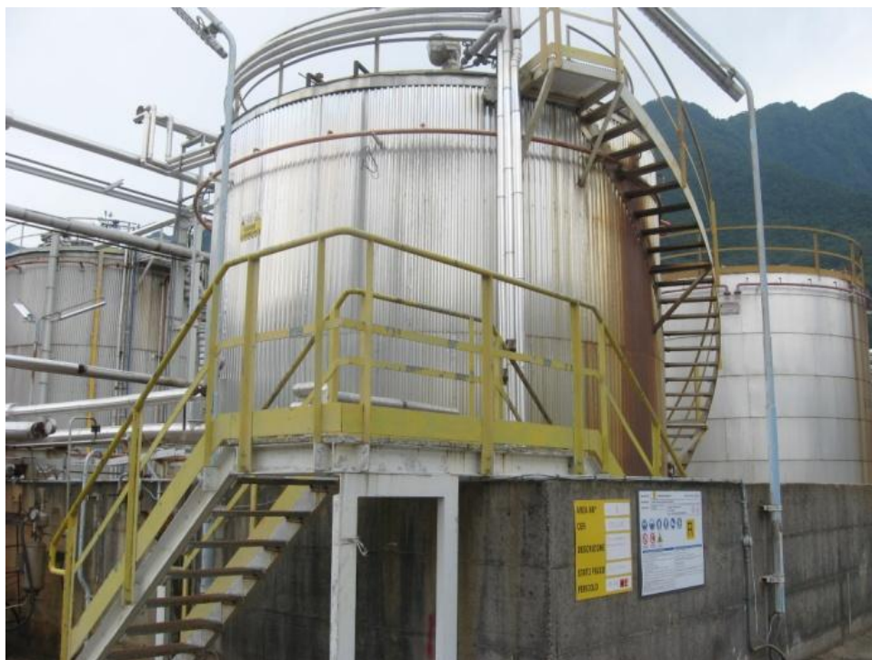
Fig. 9 Area 1 Serbatoio S254.
