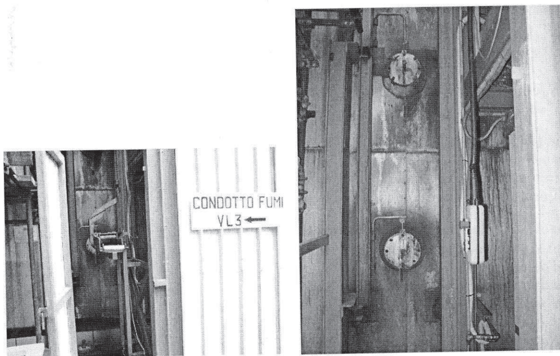
Figura 13 Carrello porta sonda e particolare bocchelli per l'inserimento della sonda di campionamento nella sezione di misura del condotto fumi VL3
