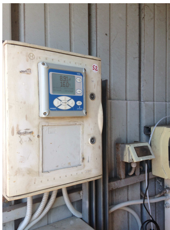
Foto 3 _ Misuratore in continuo di pH
