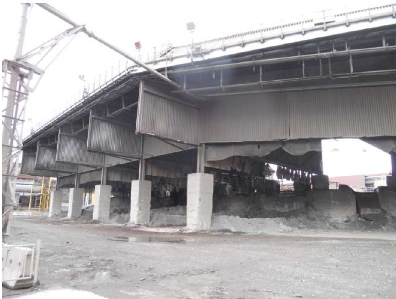
Foto 9 del 26-03-15 area “slag pit” raffreddamento delle scorie di acciaieria – presenza di residui raffreddamento scorie di acciaieria in aria di impianto senza idonea identificazione e delimitazione
