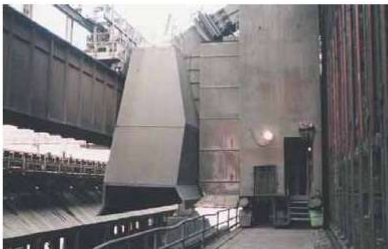
Vista sistema di captazione emissioni allo sfornamento coke
