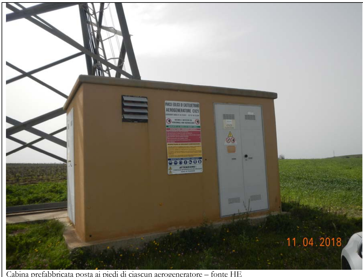
Cabina prefabbricata posta ai piedi di ciascun aerogeneratore – fonte HE
