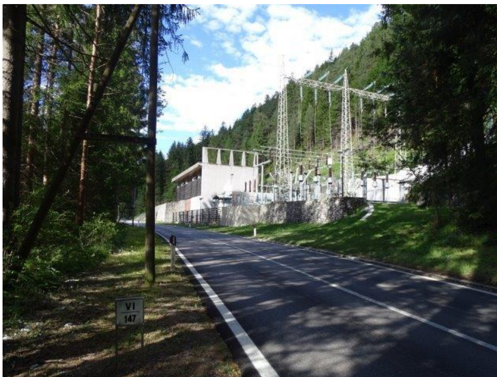
Foto 13 – Cabina Primaria Somprade
