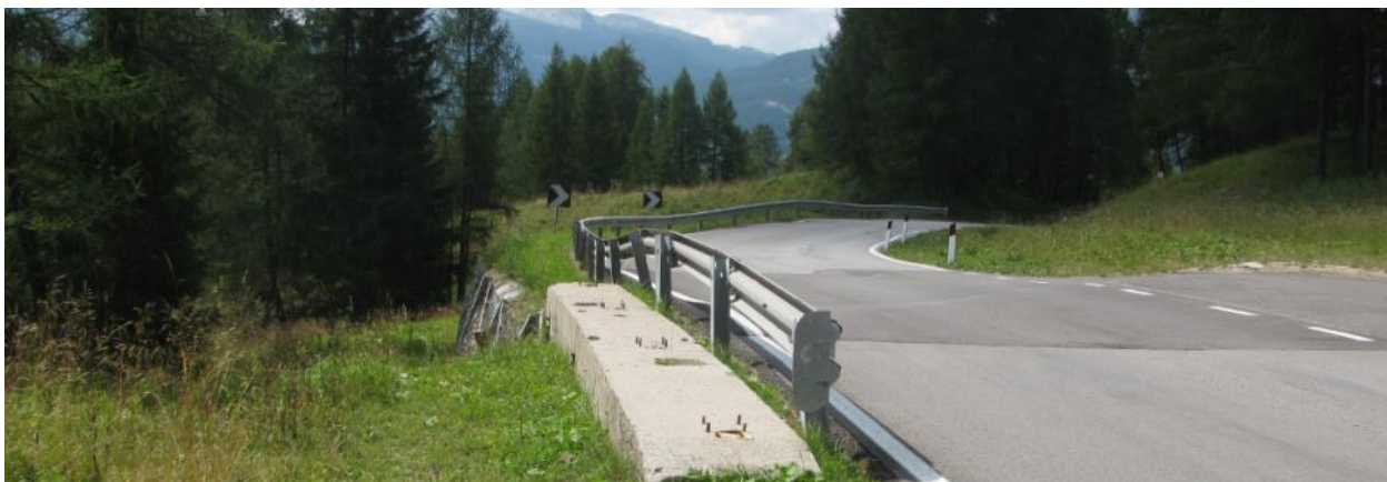
Foto 6 – dissesto geologico lungo la SS48
