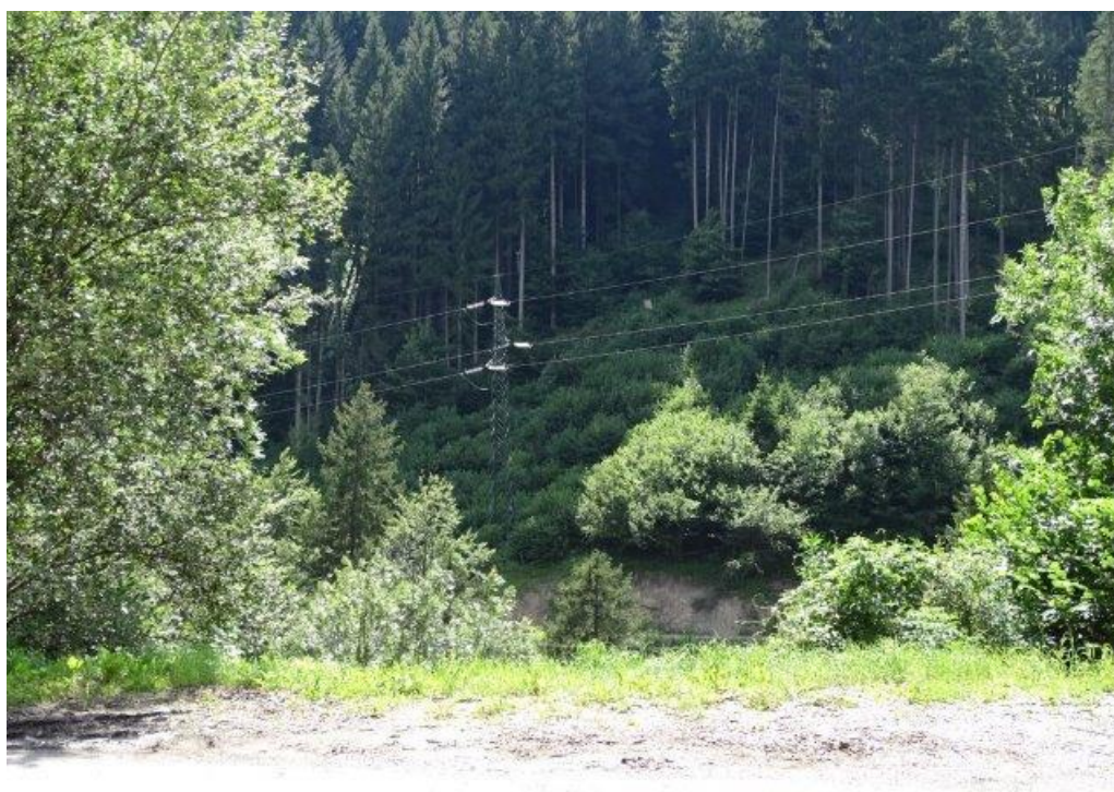
Foto 17 – Linea aerea 132 kV esistente dalla SS52 Carnica
