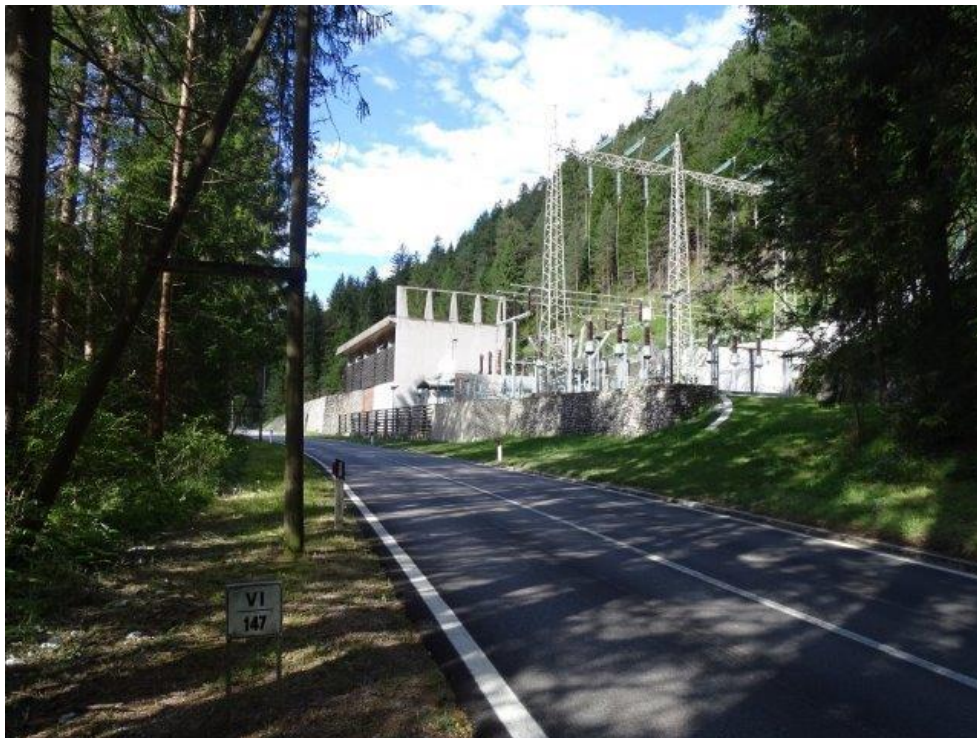
Foto 13 – Cabina Primaria Somprade
