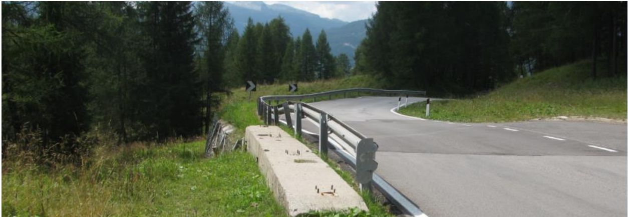
Foto 6 – dissesto geologico lungo la SS48
