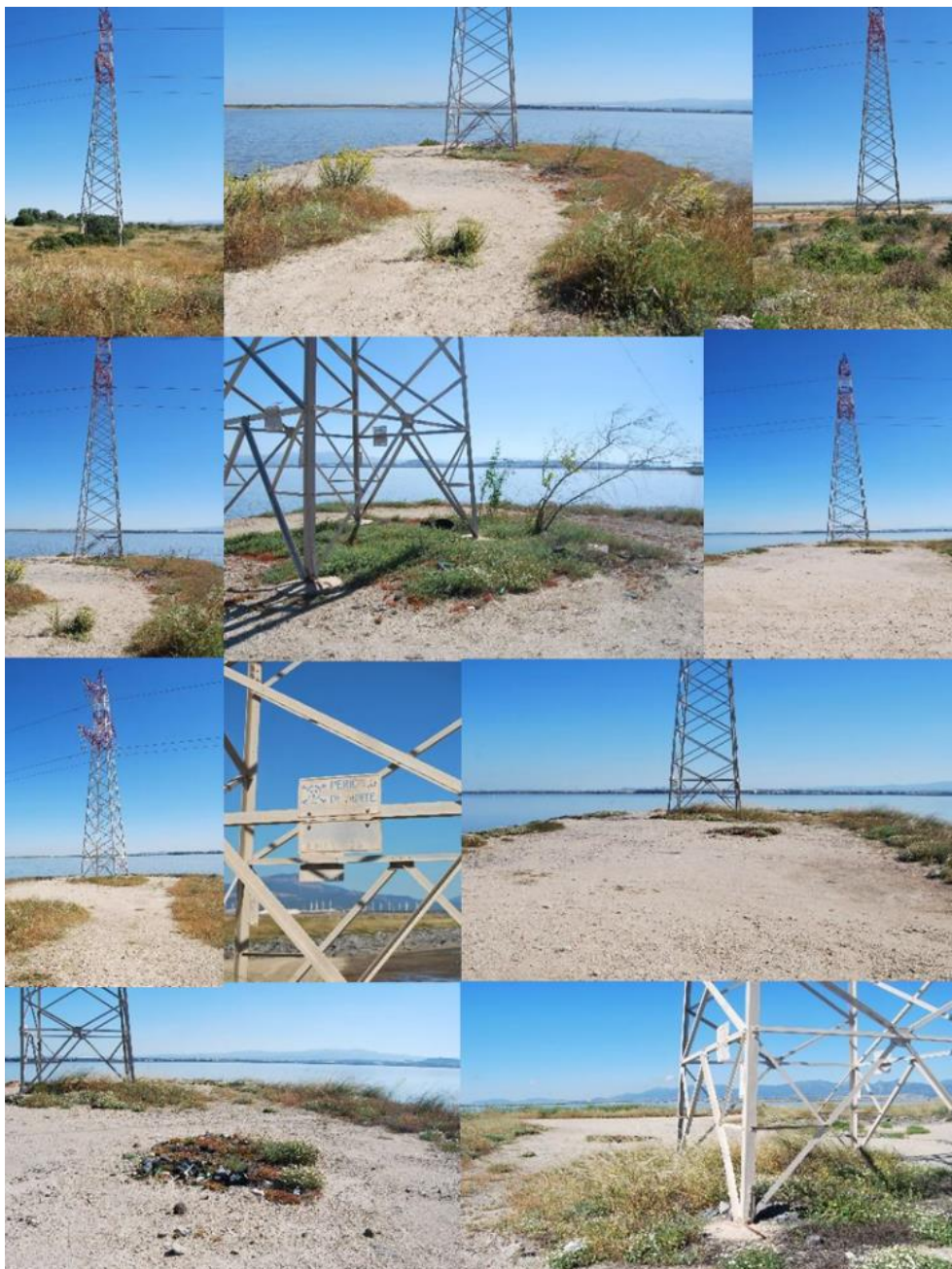
Superfici sulle quali sono stati installati i tralicci dell'alta tensione nel settore critico delle saline di Macchiareddu
