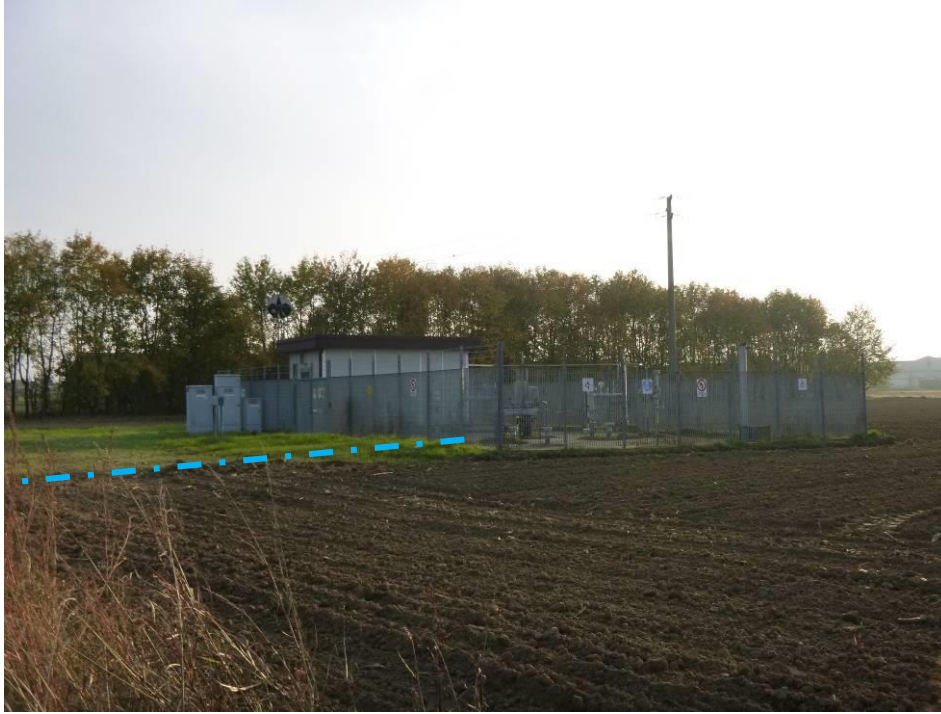
Foto n.43 – Impianto esistente n. 4500190/42 a valle esistente attraversamento SP n.16
