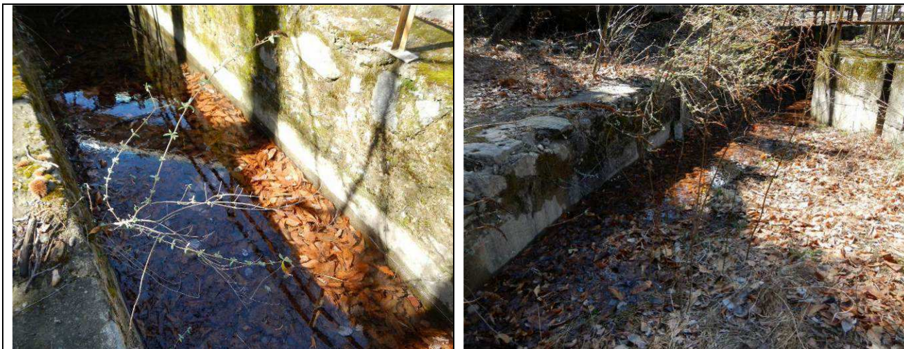
Figura 3-46: pozze d'acqua in corrispondenza del manufatto-primavera 2013.
