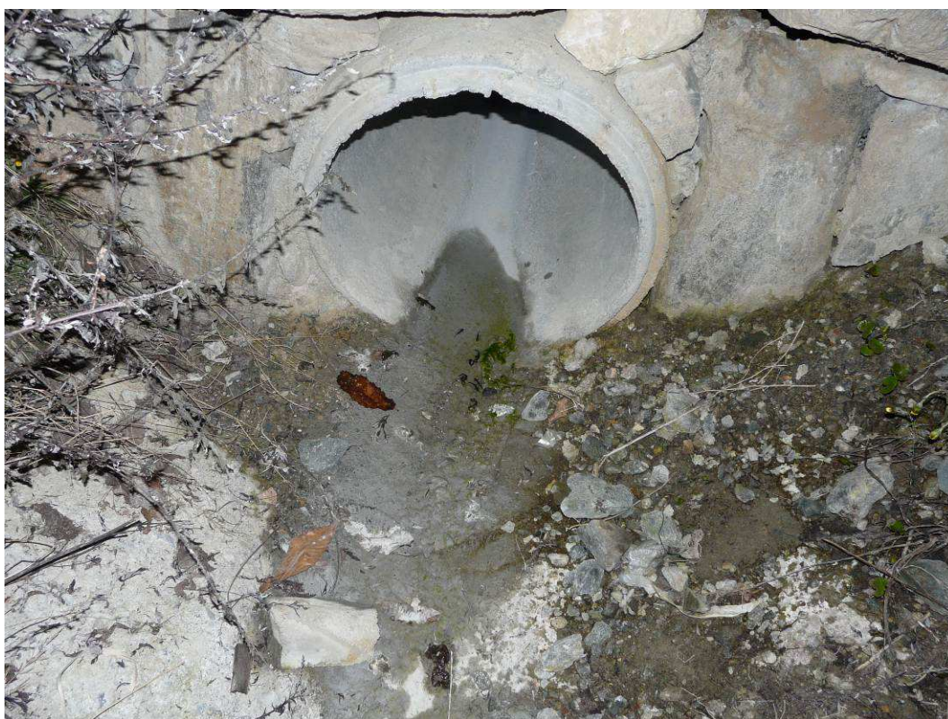
Figura 3-40: sbocco della tubazione in cemento. Si nota la piccola raccolta di acqua con larve di salamandra pezzata. Marzo 2016.
