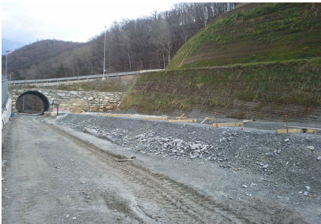
Figura 3-63: area meridionale del cantiere, che si estende fino oltre il sottopassaggio. Si nota come il versante sia isolato dal cantiere per la presenza del cumulo (primavera 2015).
