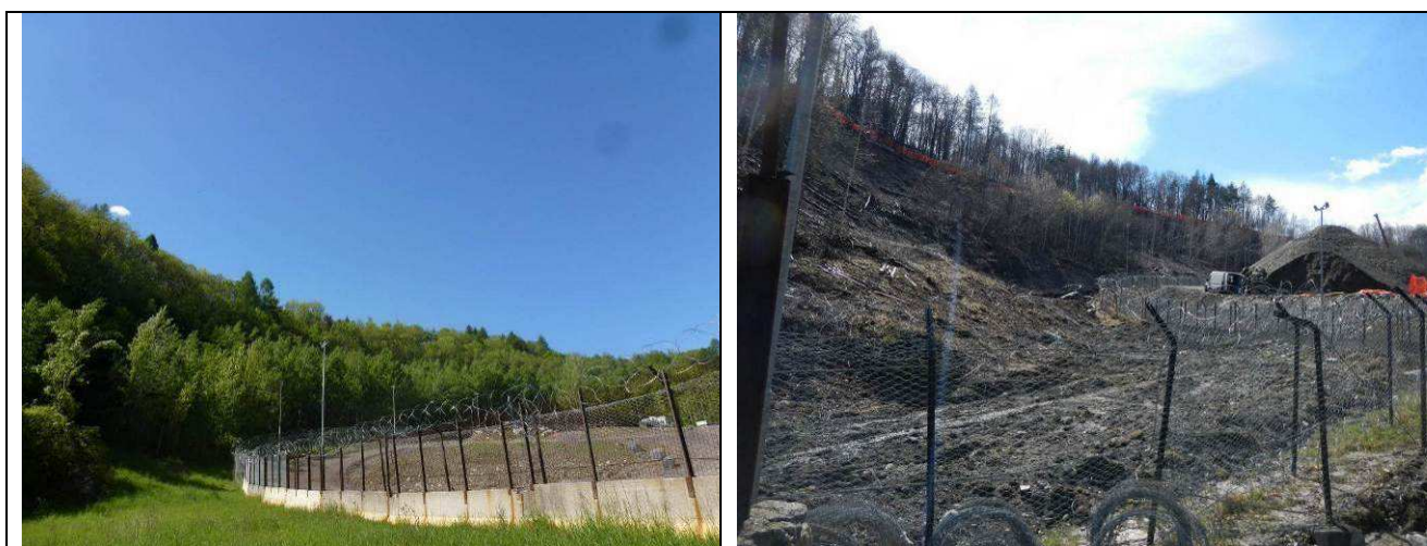
Figura 3-57: situazione del versante più prossimo al cantiere in estate 2012 (a sinistra) in confronto con la primavera 2013 (a destra) si nota la trasformazione della zona con disboscamento di una porzione di versante.
