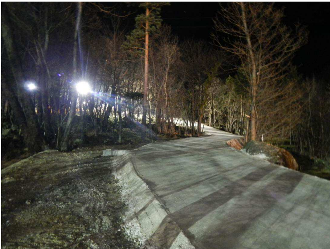
Figura 3-58: area boscata a nord del cantiere in situazione notturna (primavera 2014). Si nota la strada di servizio e la costante illuminazione dell'area.
