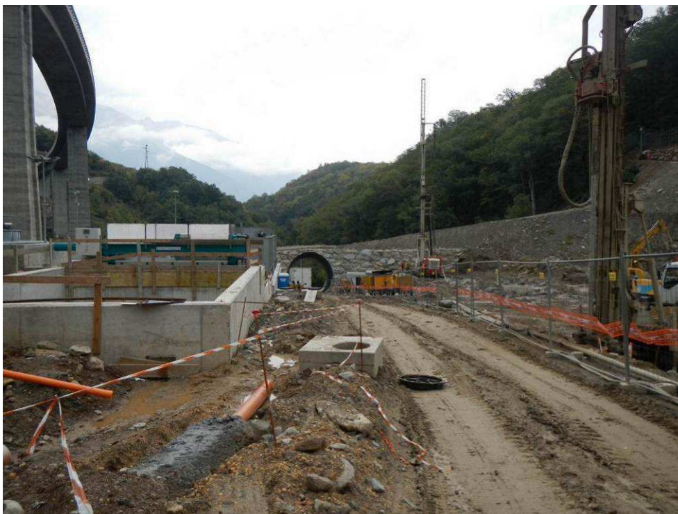
Figura 3-56: primavera 2013 - situazione dell'area di cantiere dove era presente l'impluvio colonizzabile dalla fauna anfibia in fase di AO.
