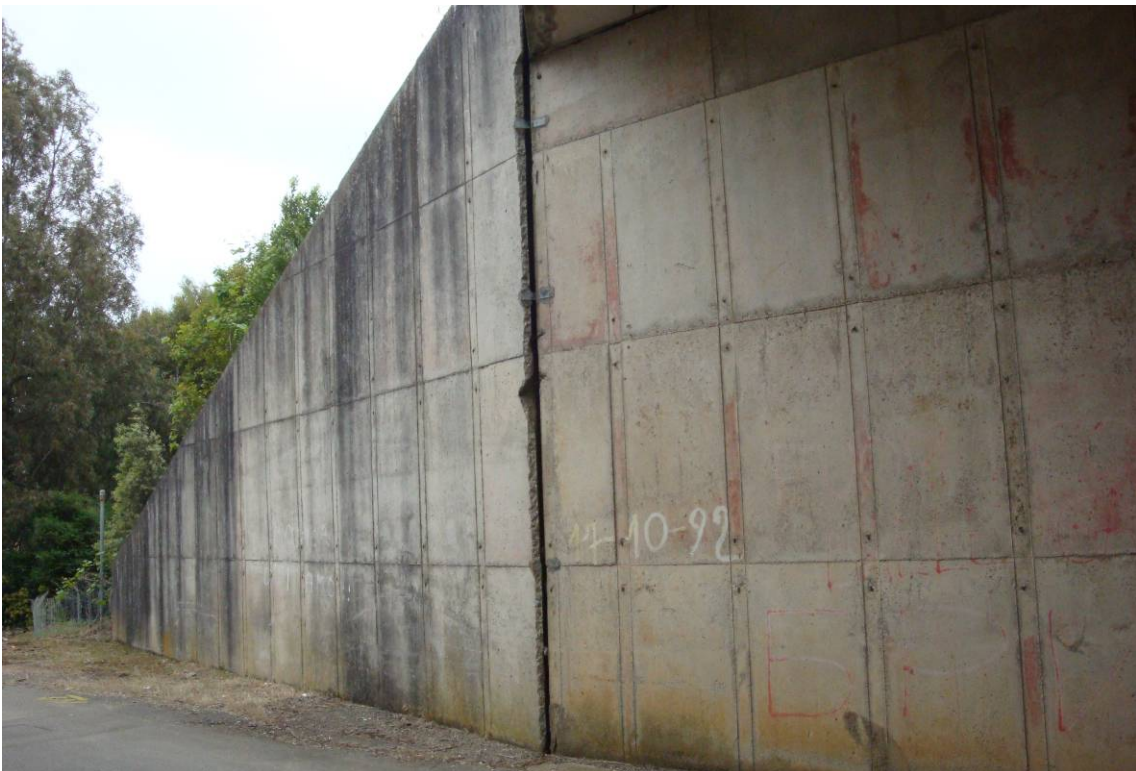
Foto 8 – Rotazione del muro d'ala
