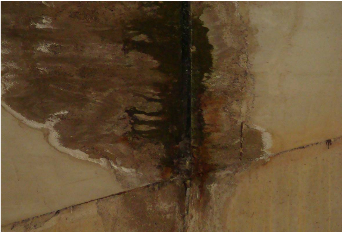
Foto 7– Particolare giunto solettone, infiltrazioni
