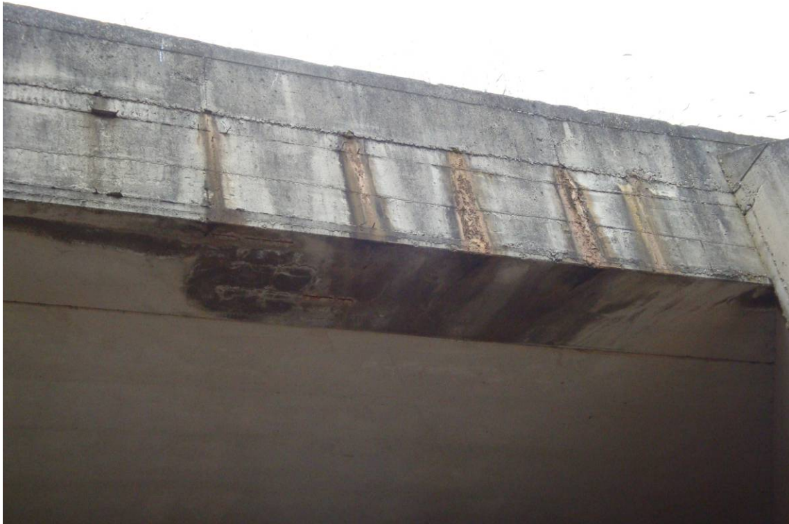
Foto 3 – Vista intradosso – infiltrazioni e dilavamento cls.
