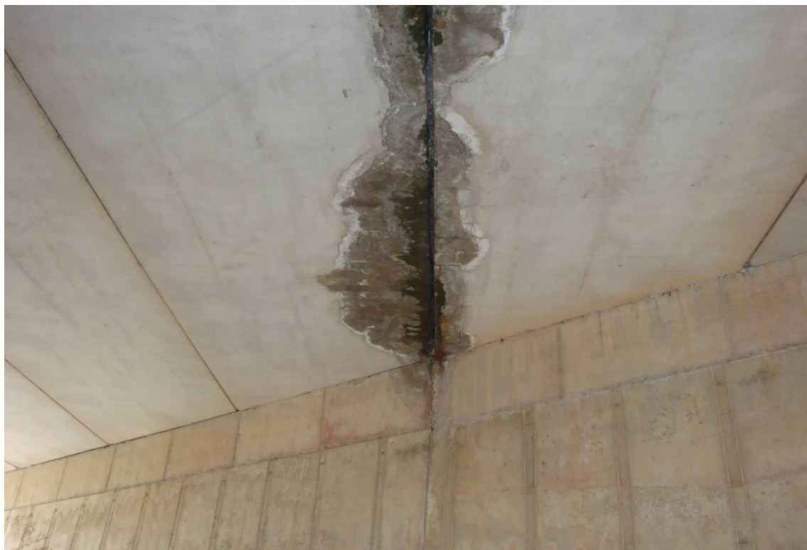
Foto 5 – Vista intradosso – particolare giunto, infiltrazioni
