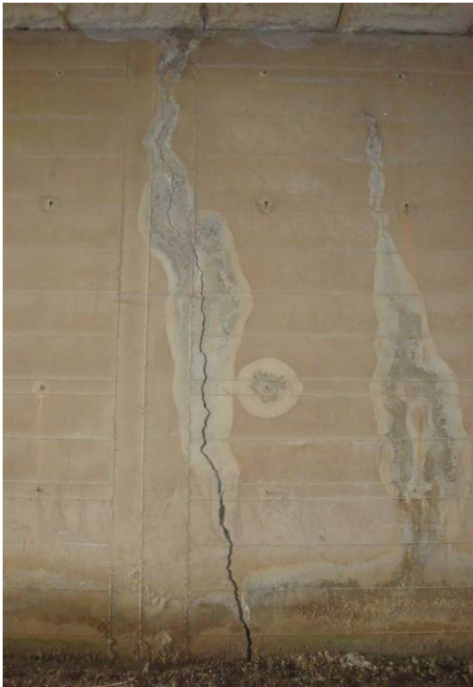
Foto 5 – Vista muro frontale-lesione
