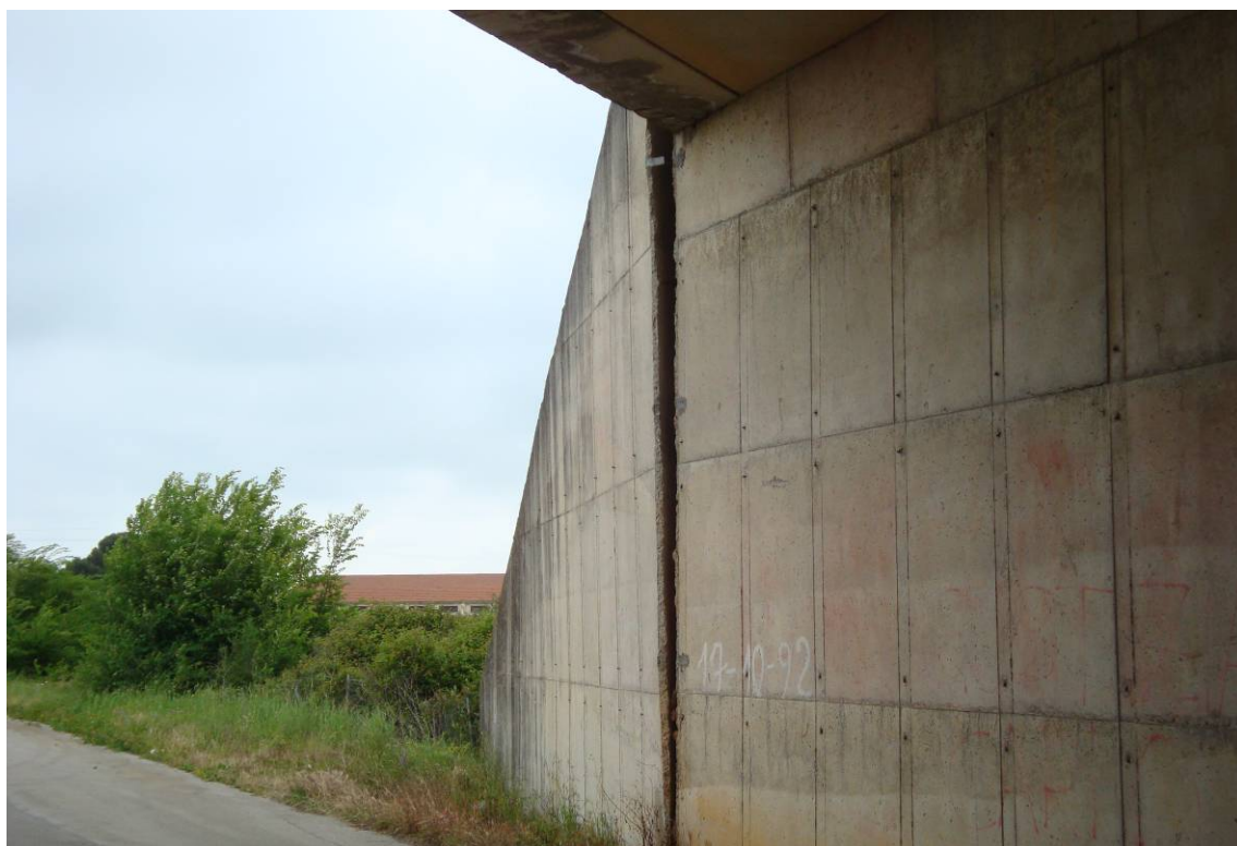
Foto 9 – Rotazione del muro d'ala
