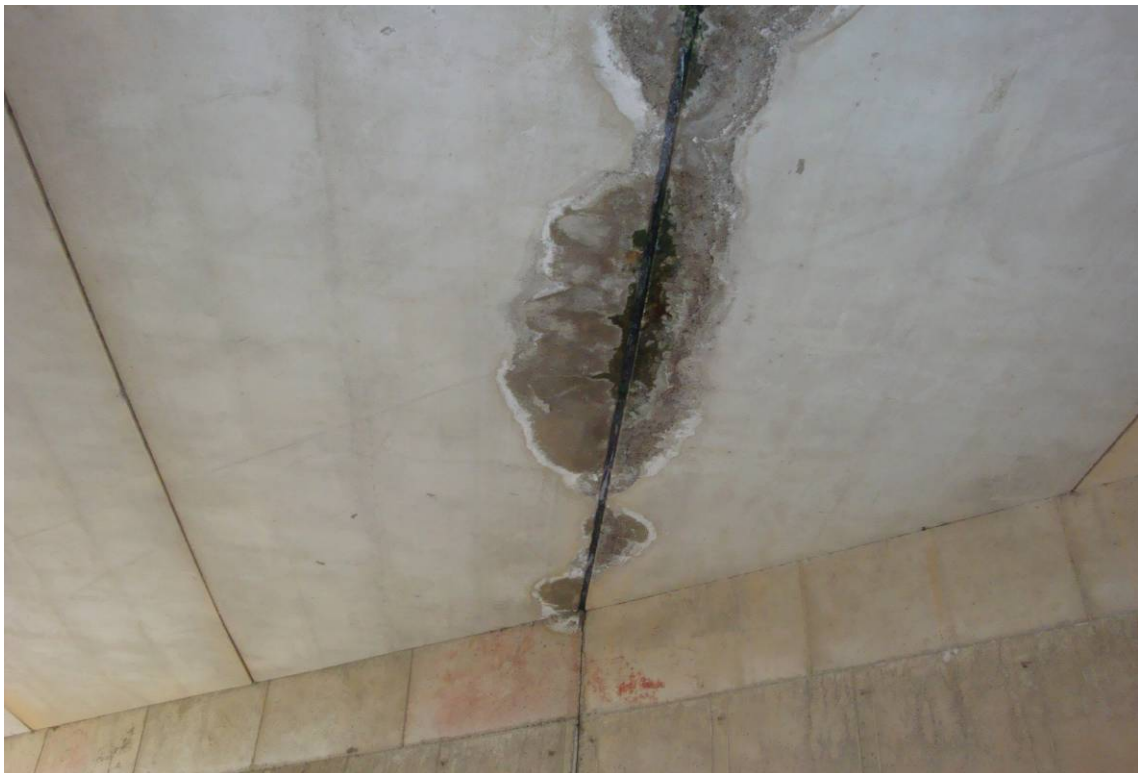
Foto 4 – Vista intradosso – particolare giunto, infiltrazioni
