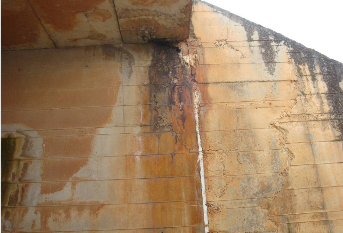
Foto 8 – Vista muro d'ala e spalla - degrado
