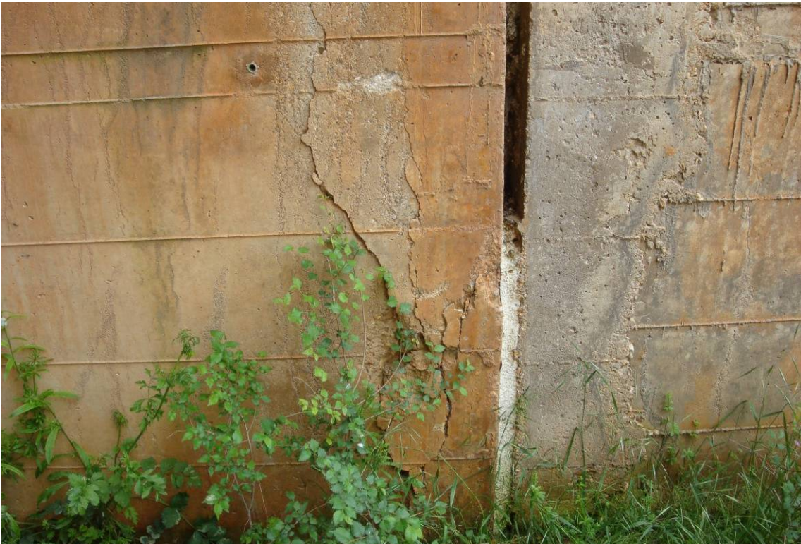
Foto 9 – Particolare degrado muro d'ala e spalla
