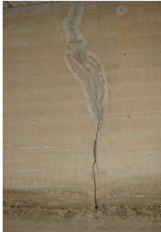
Foto 6 - Vista muro frontale-lesione
