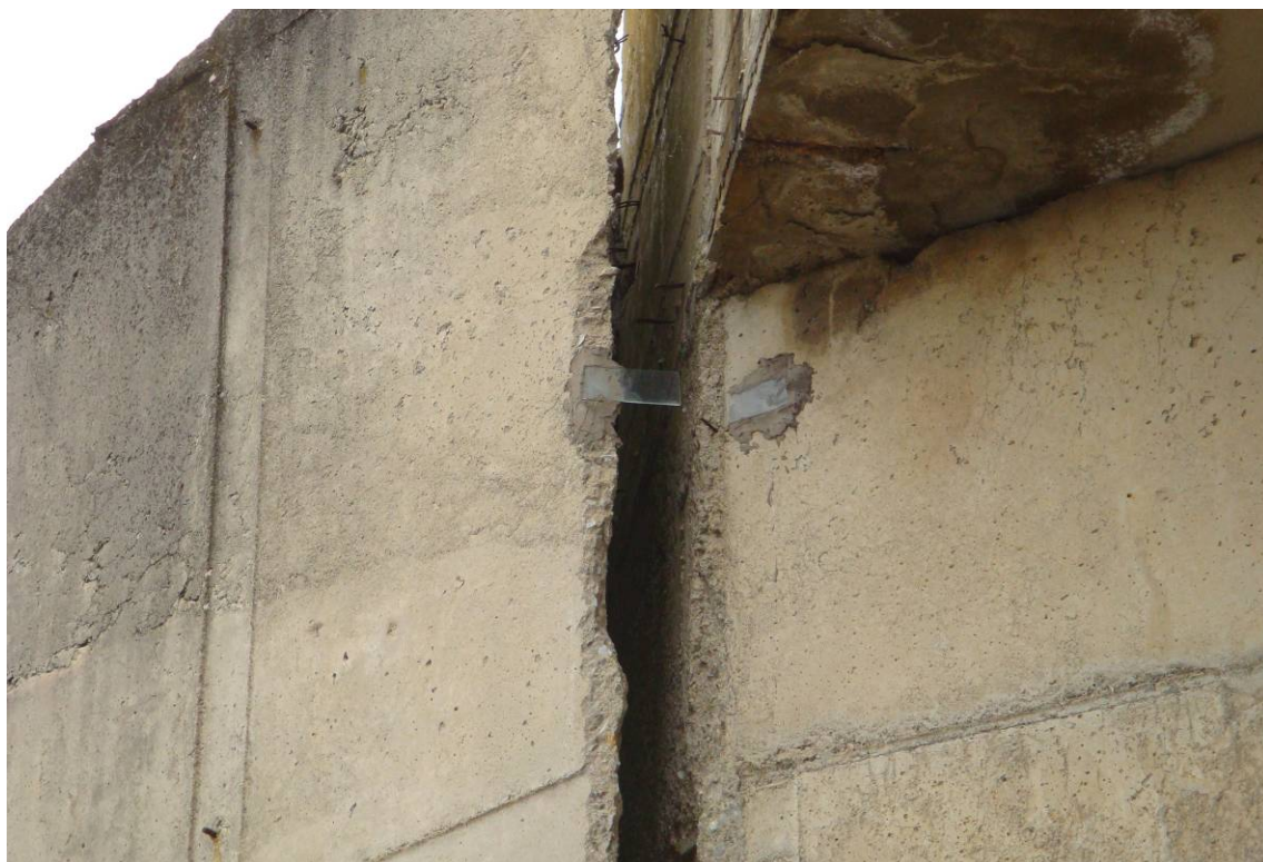
Foto 10 – Particolare rottura biffa tra muro d'ala e spalla
