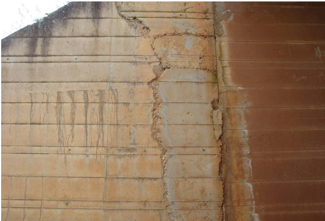
Foto 7- Vista muro d'ala – segregazione calcestruzzo
