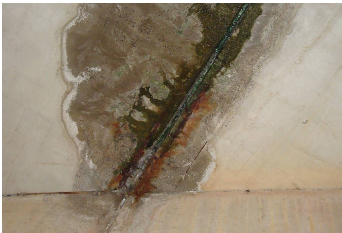
Foto 6 – Particolare giunto solettone, infiltrazioni
