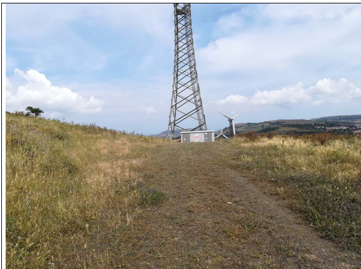
Cabina prefabbricata posta ai piedi di ciascun aerogeneratore – fonte HE
