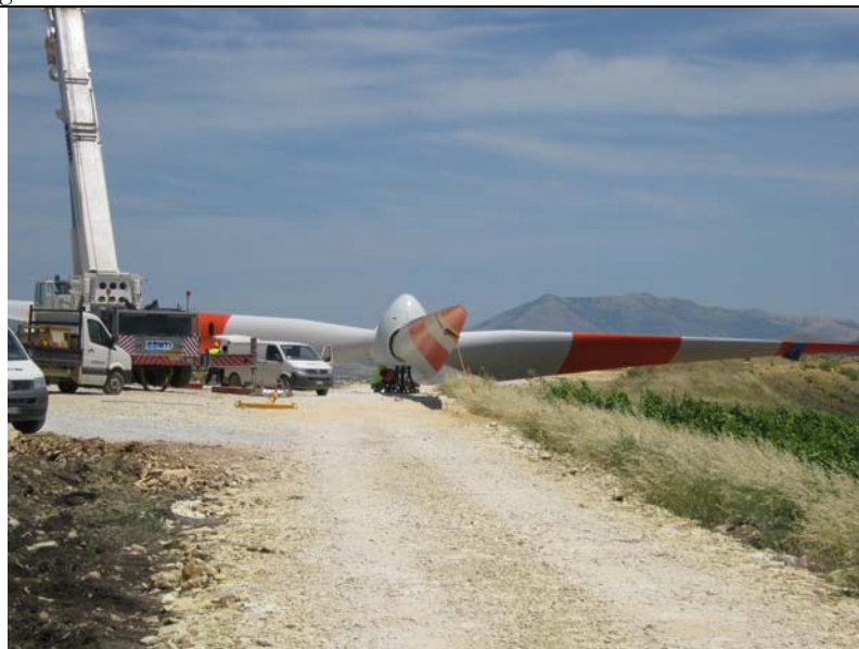
Particolare del supporto in acciaio su cui è collocato il rotore – Fonte HE
