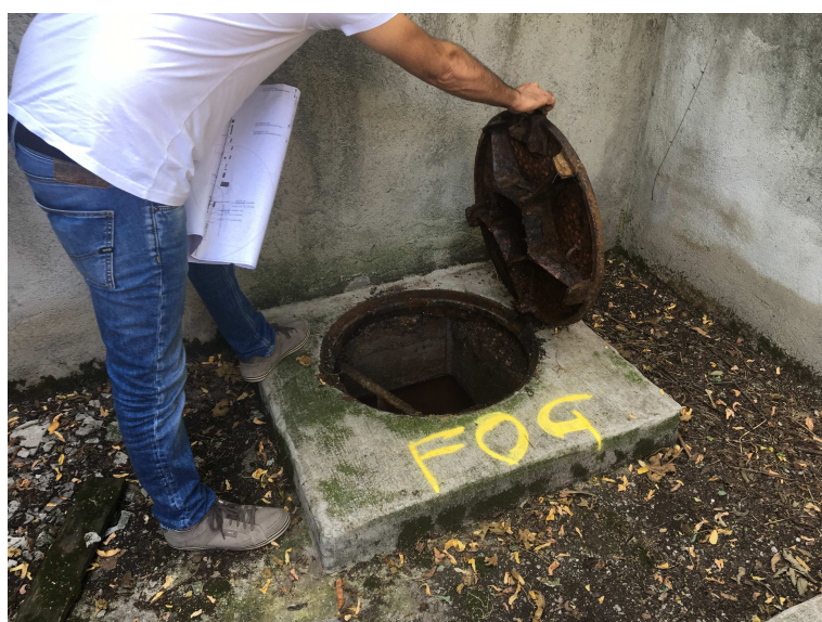
Figura 5 – Fogna mista BA15 pk AV 15+980 (81+462.08 BP) lato nord
