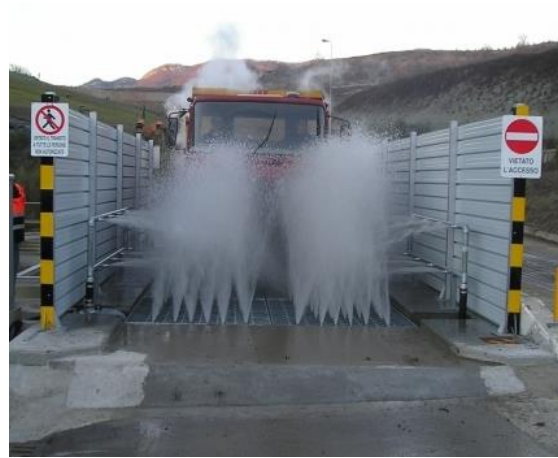
Impianto di lavaggio ruote per i mezzi pesanti
