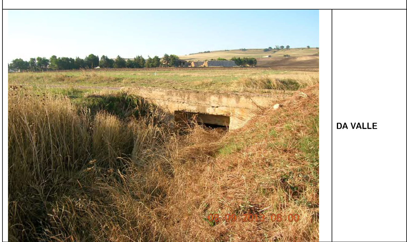
PARTICOLARE REALIZZATIVO DELL'ATTRAVERSAMENTO STAFFAGGIO A PONTE (LATO DI VALLE) ELABORATO 8 Particolare N. 4
