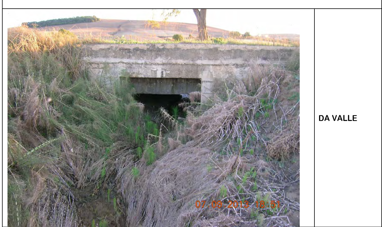
PARTICOLARE REALIZZATIVO DELL'ATTRAVERSAMENTO STAFFAGGIO A PONTE (LATO DI VALLE) ELABORATO 8 Particolare N. 5
