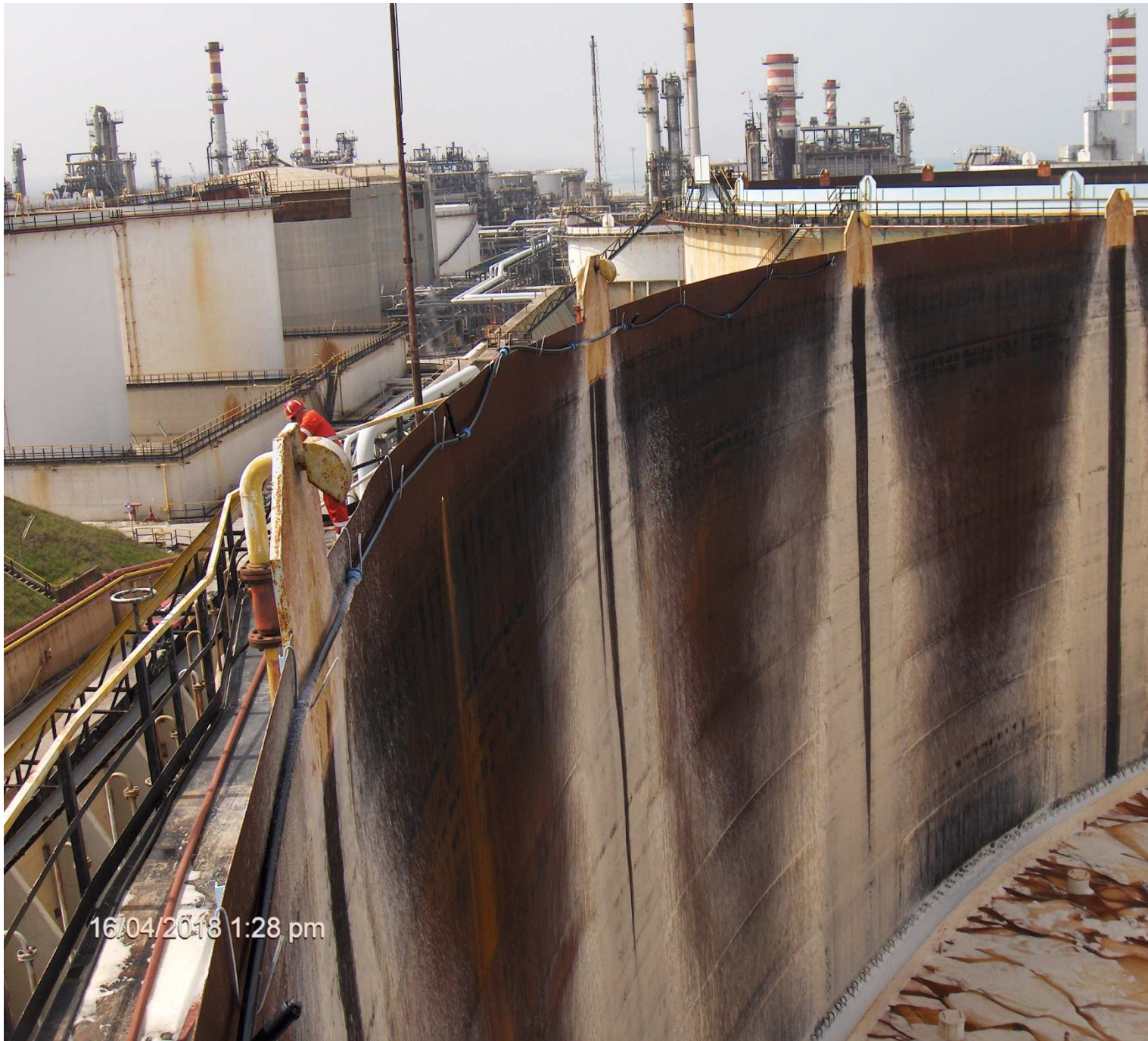
Figura 15 particolare del circuito di spruzzamento sostanze sequestranti lato monte/Senigallia
