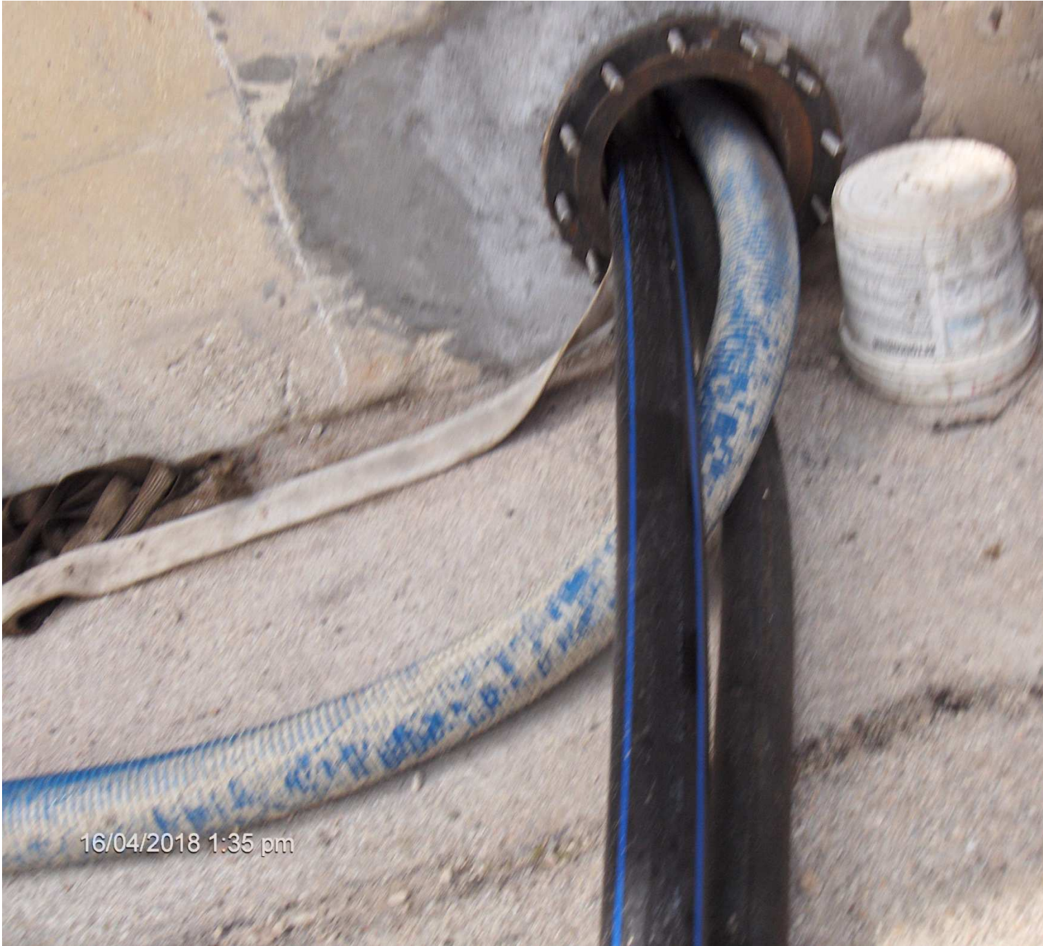
Figura 8 vista tubo uscita bacino verso pompa per drenaggio del tetto
