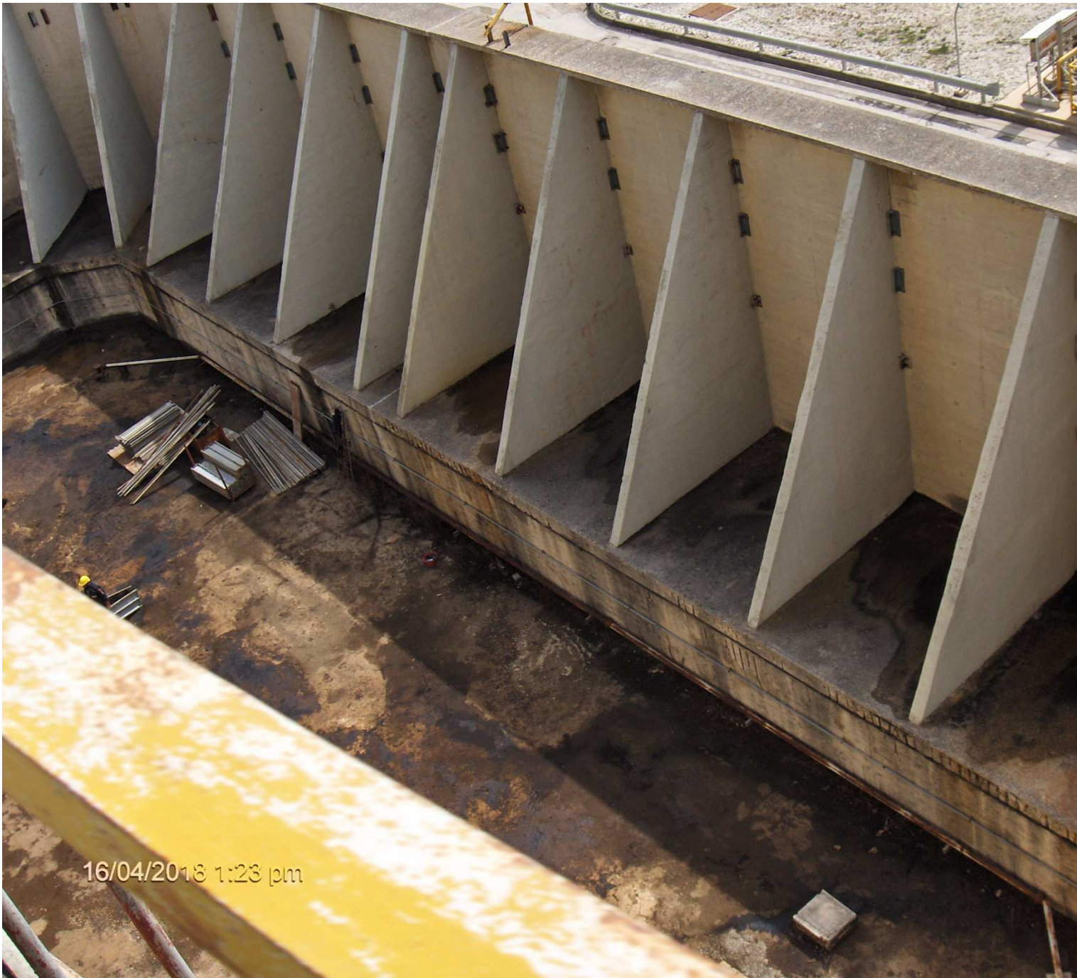
Figura 5 bacino di contenimento tk 61
