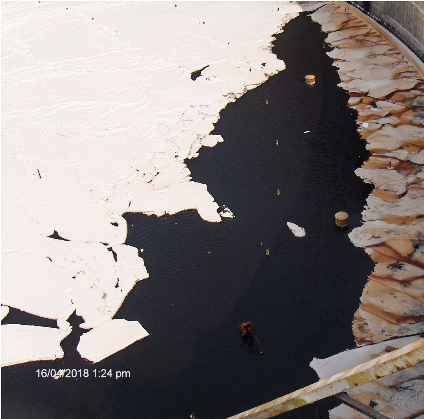
Figura 2tetto tk 61 con prodotto parzialmente sotto letto di schiuma
