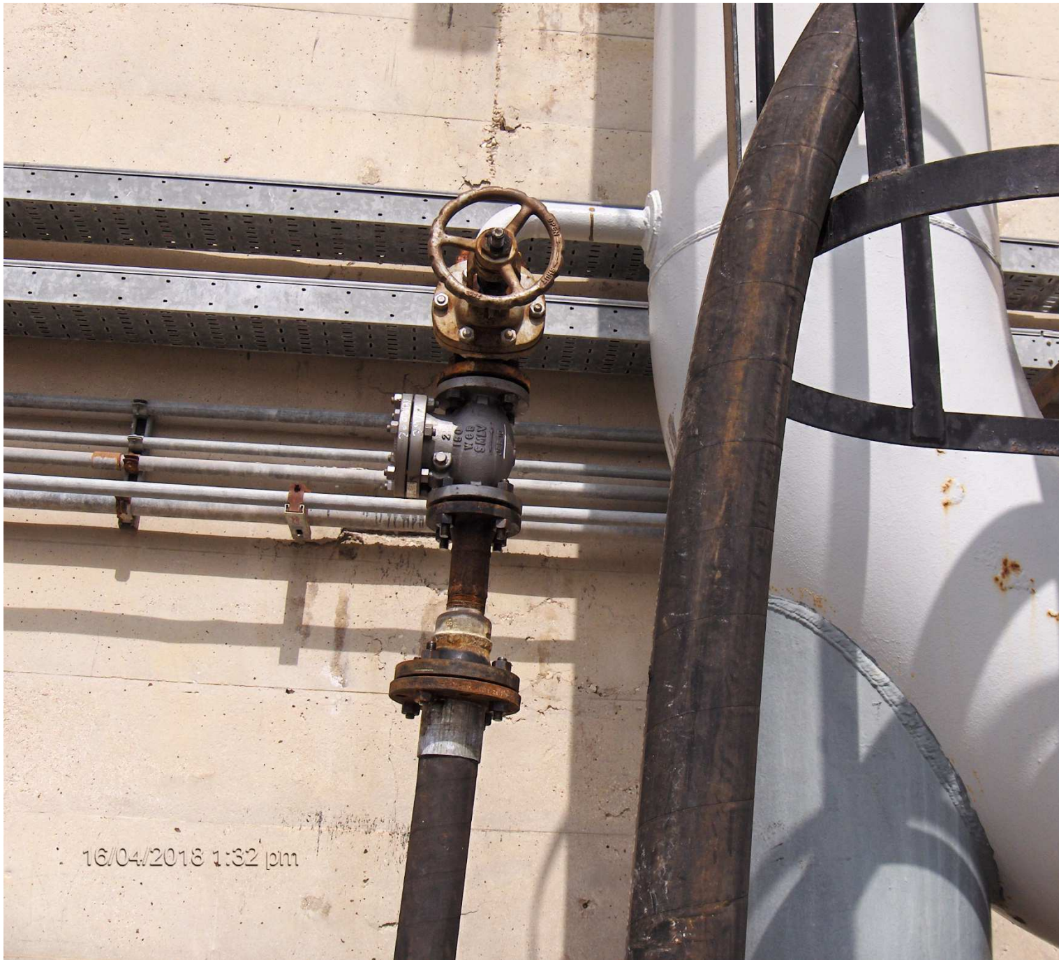
Figura 10 tubo di mandata della pompa di aspirazione prodotto da tetto tk 61 che invia il prodotto al serbatoio di stoccaggio greggio
