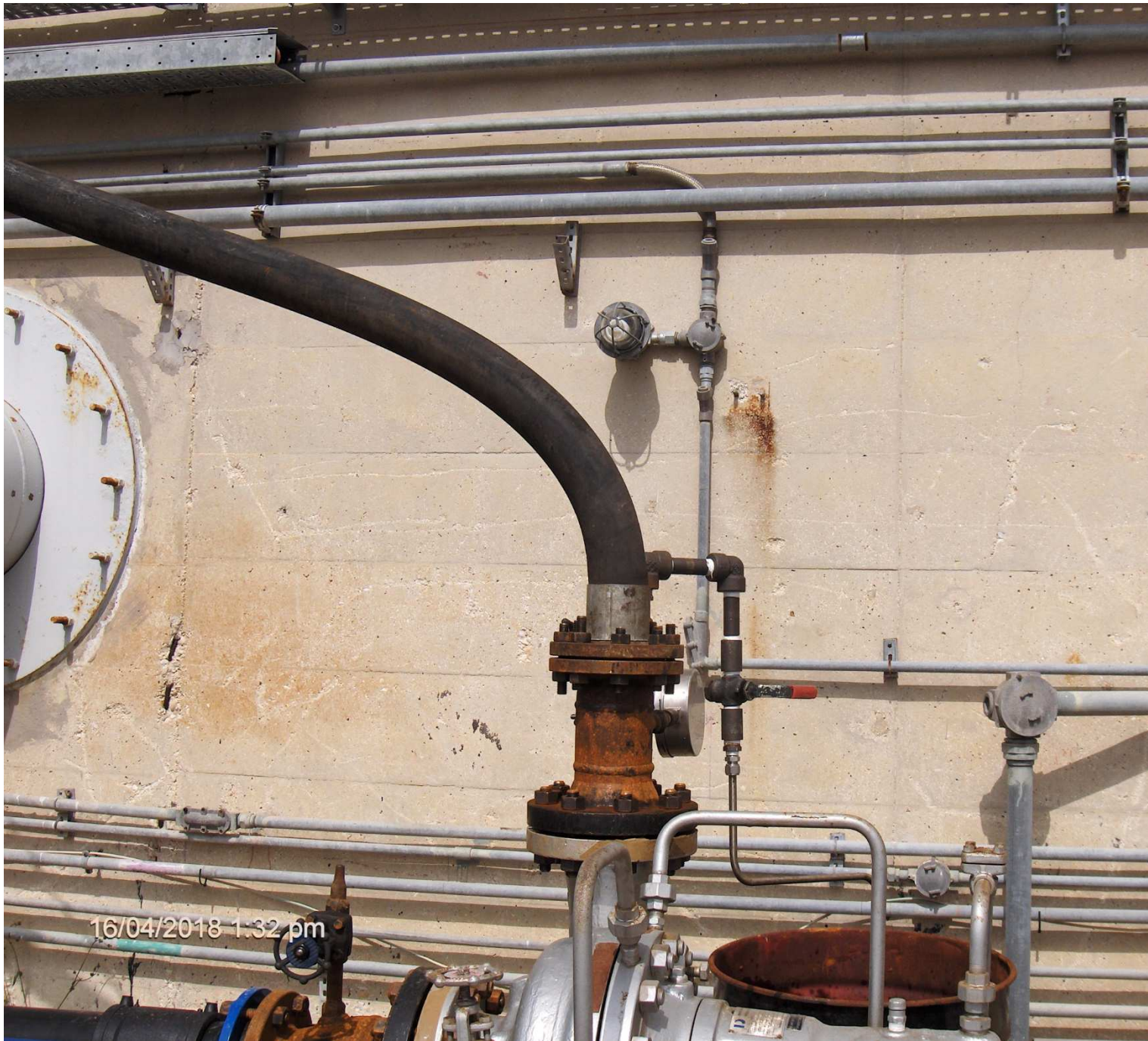
Figura 11 mandata pompa di aspirazione del prodotto idrocarburico dal tetto di tk 61
