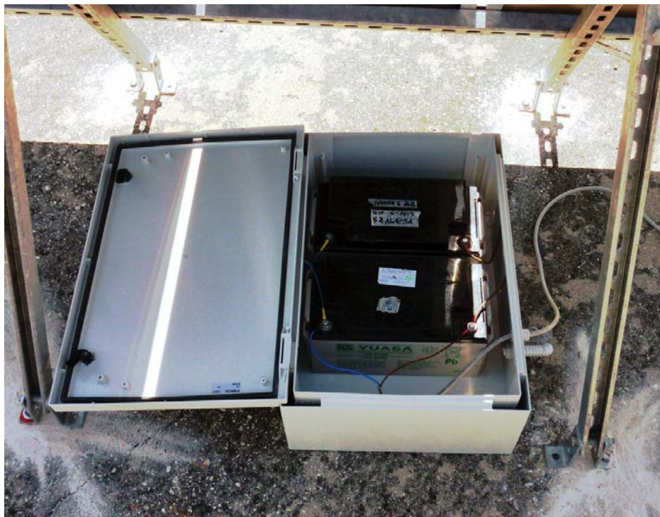
Figura 4 Batterie tampone da 65 Ah.
