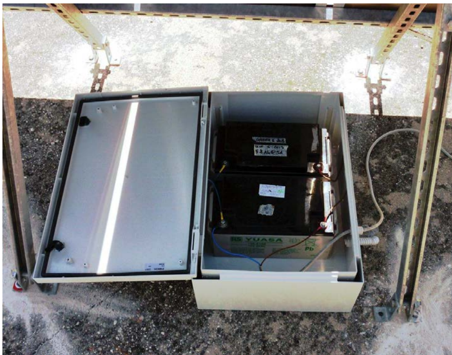
Figura 3 Batterie tampone da 65 Ah.
