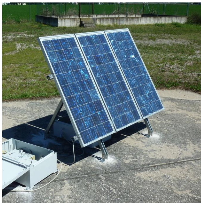
Figura 5 Apparato di alimentazione.
