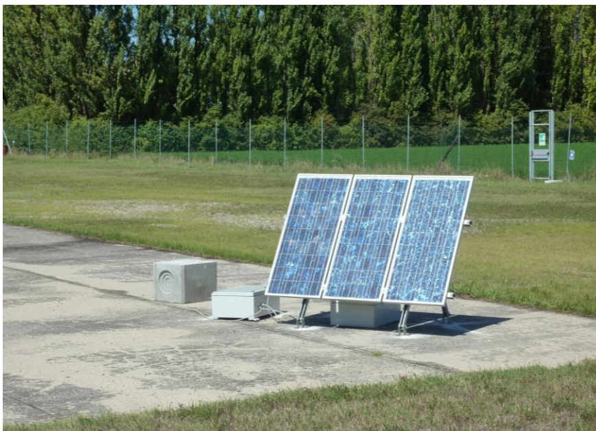
Figura 1 Stazione sismica SM1N completa di apparato di alimentazione con pannelli fotovoltaici .
