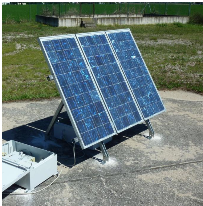
Figura 5 Apparato di alimentazione.
