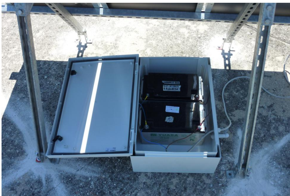
Figura 4 Particolari dell'installazione: Batterie da 65 Ah.
