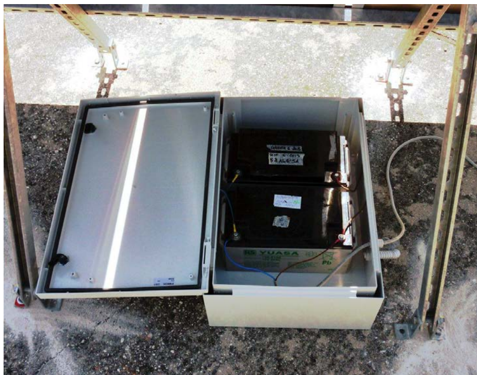
Figura 4 Batterie tampone da 65 Ah.
