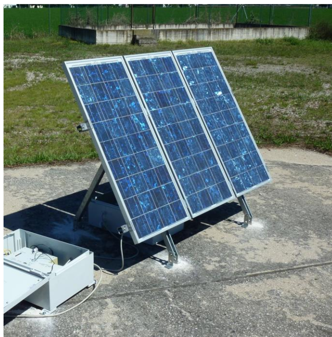
Figura 4 Apparato di alimentazione.
