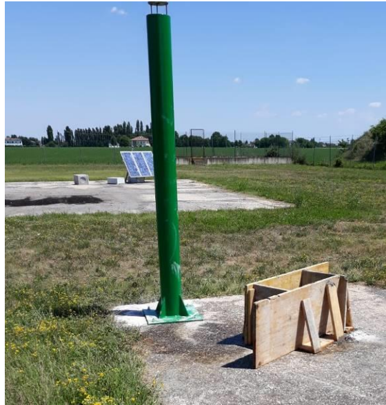
Figura 2: pilastro in acciaio predisposto dalla Committenza per l'installazione della stazione GNSS e basamento in cemento armato realizzato per l'installazione dell'armadietto tecnologico.
