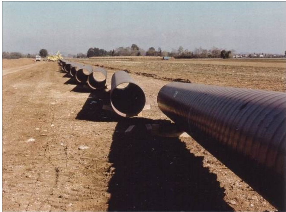
Fig. 3.1.C: Esempio di sfilamento tubazioni
