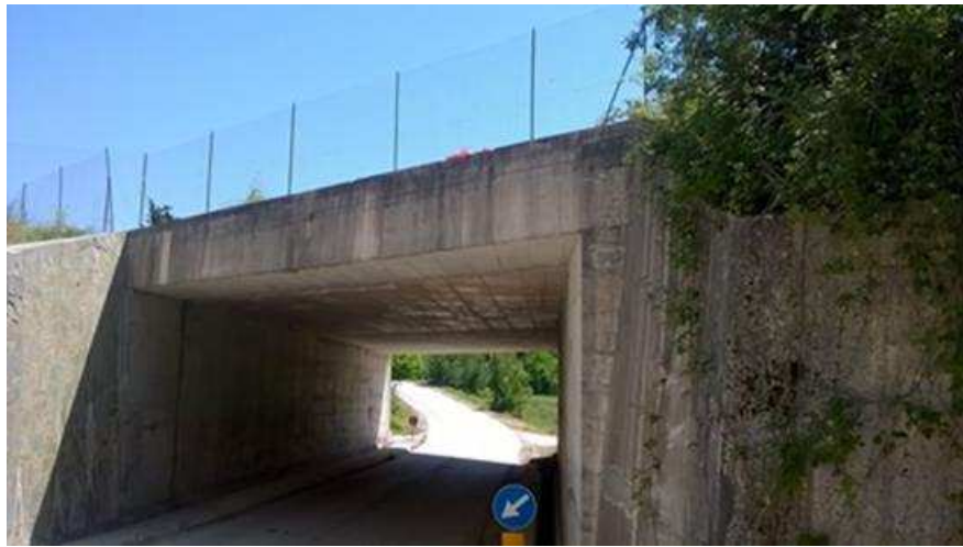
Foto 31 - Sottovia scatolare comunale
