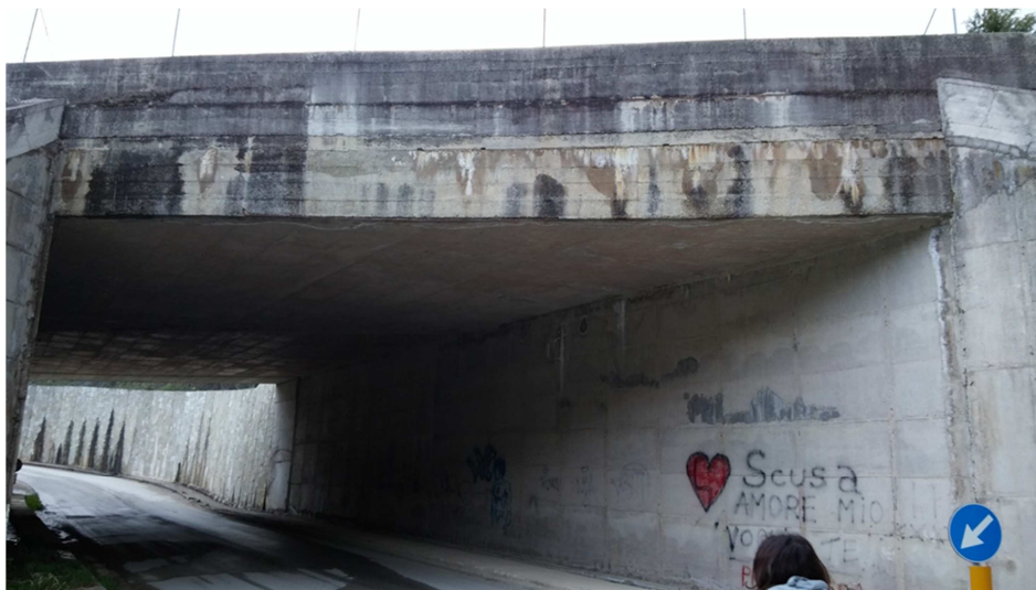
Foto 32 - Sottovia scatolare comunale
