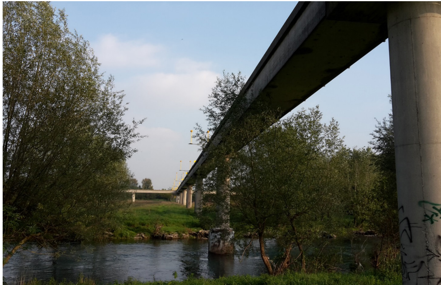
L'attuale sentiero luminoso è alloggiato sopra un viadotto che attraversa il fiume Serio
