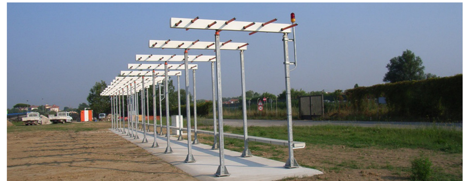
Esempio di impianto ILS Localizzatore – fonte: http://www.pimarsrl.it/it/impianti-ilsdme/
