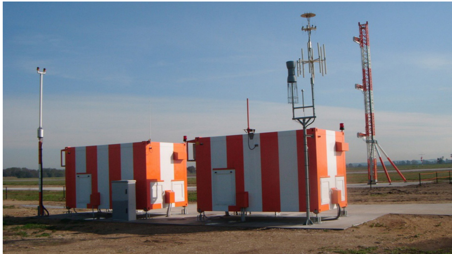
Esempio di impianto ILS Guida planata – fonte: http://www.pimarsrl.it/it/impianti-ilsdme/
