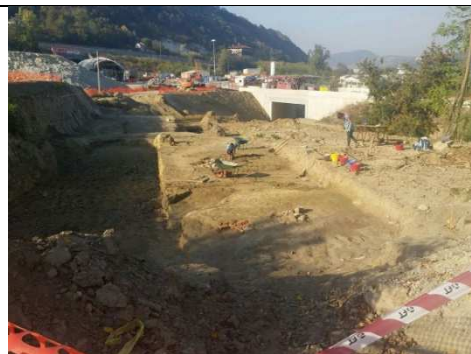
Figura 2 Rifacimento strada di accesso ai cantieri COP4 e COP5 in Arquata Scrivia (fig 2)
