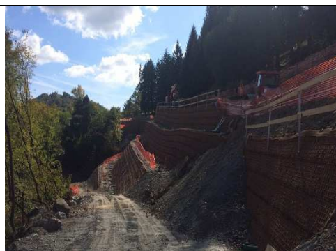
Figura 4 - Frana Carbonasca - S.P.163 della Castagnola (foto 2)
