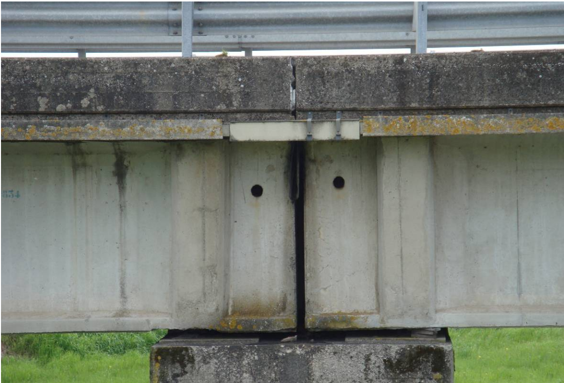
Foto 9 – Particolare zona di appoggio delle travi – cls. dilavato sui cordoli, sulle testate delle travi e sui pulvini
