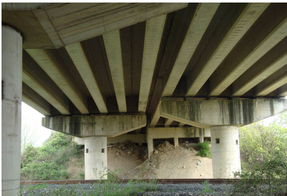
Foto 2 – Vista intradosso, campata centrale – scolature sui pulvini
