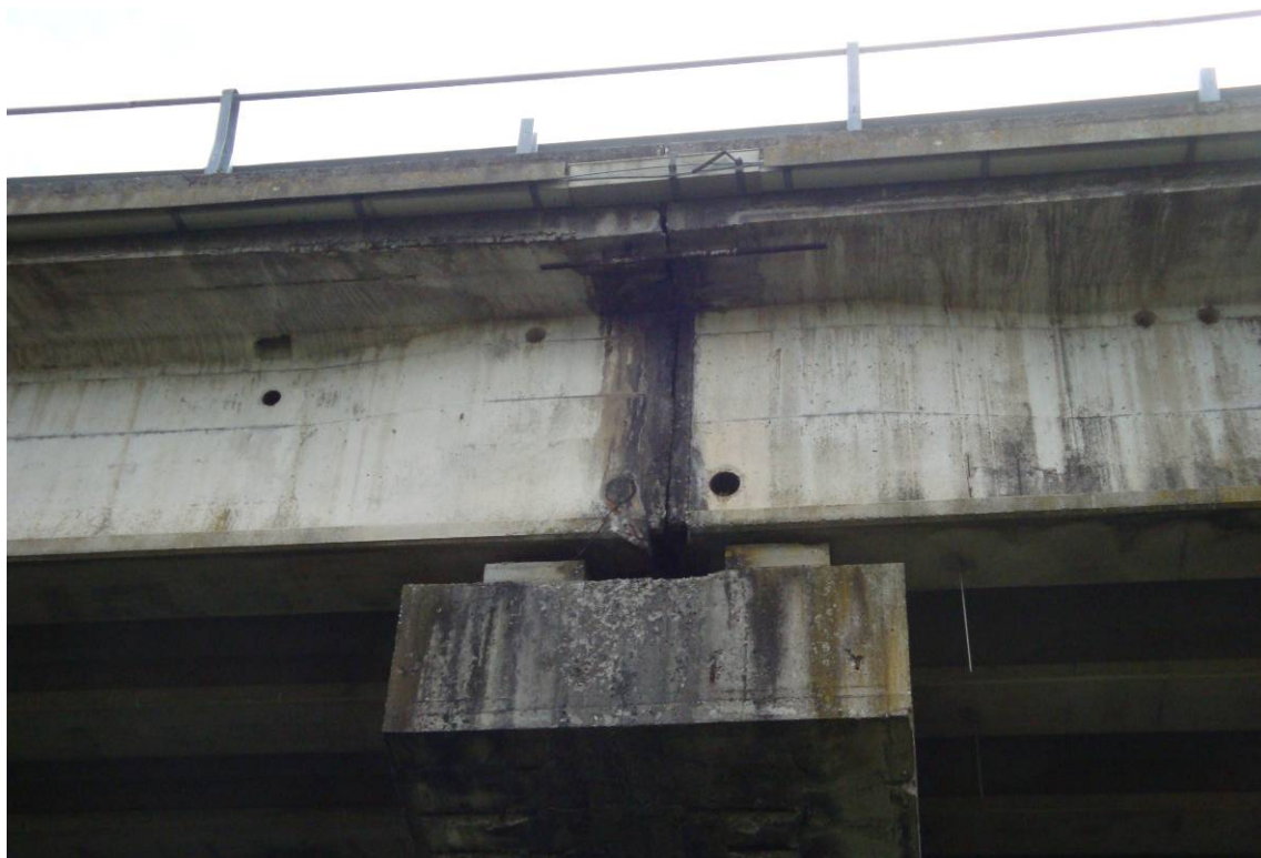
Foto 11– Cls. umido e dilavato su cordoli, travi e pulvino
