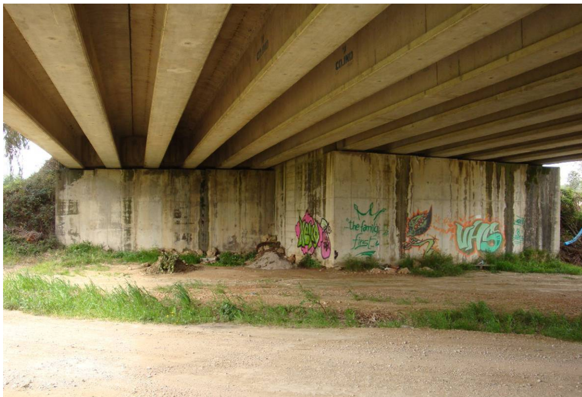
Foto 5 – Vista intradosso – scolature sul muro frontale delle spalle
