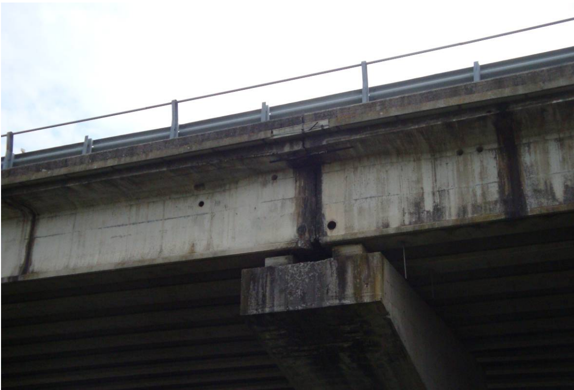
Foto 10 – Cls. umido e dilavato su cordoli, travi e pulvino
