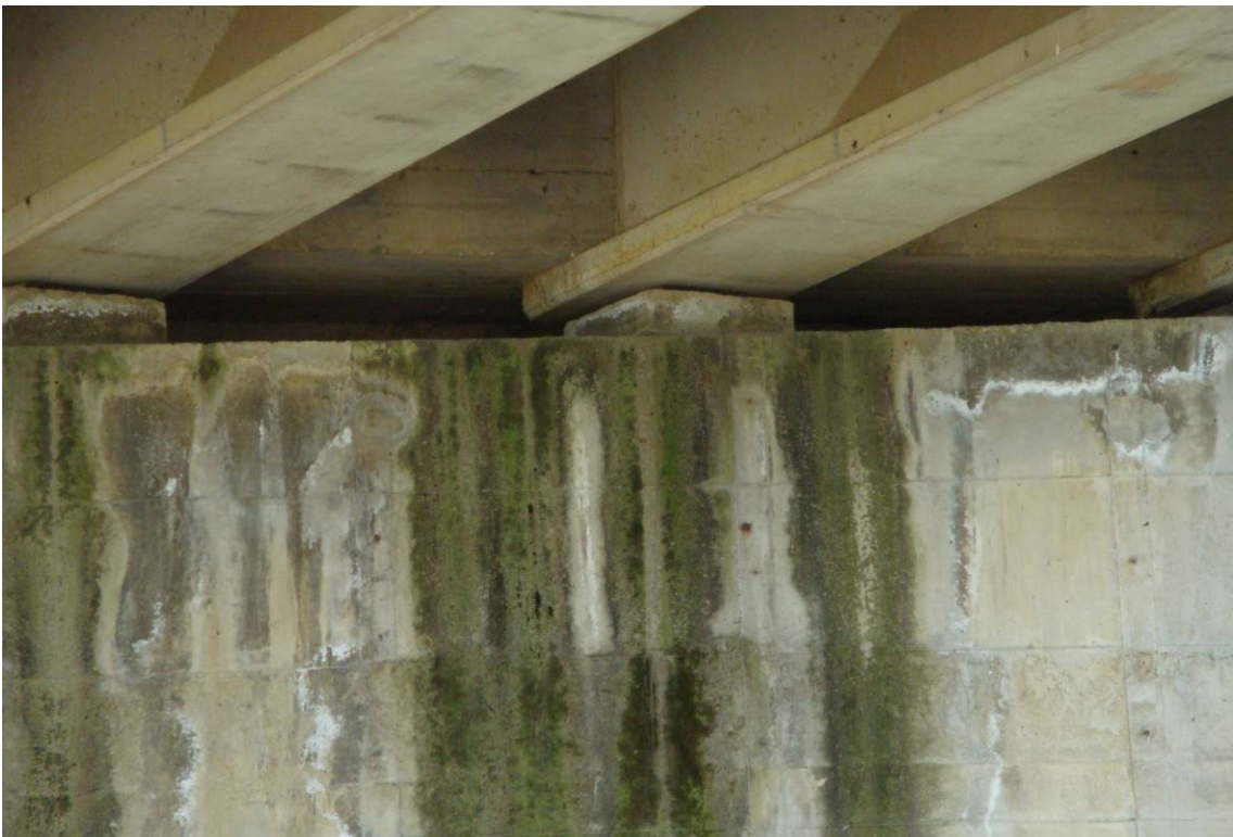
Foto 4 – Scolature, umidità e dilavamento del cls. sul muro frontale della spalla
