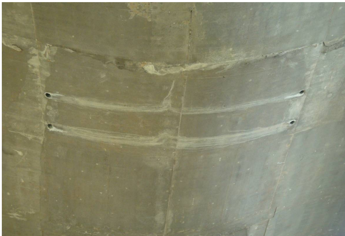
Foto 21 – Vista intradosso – scolature dai pluviali
