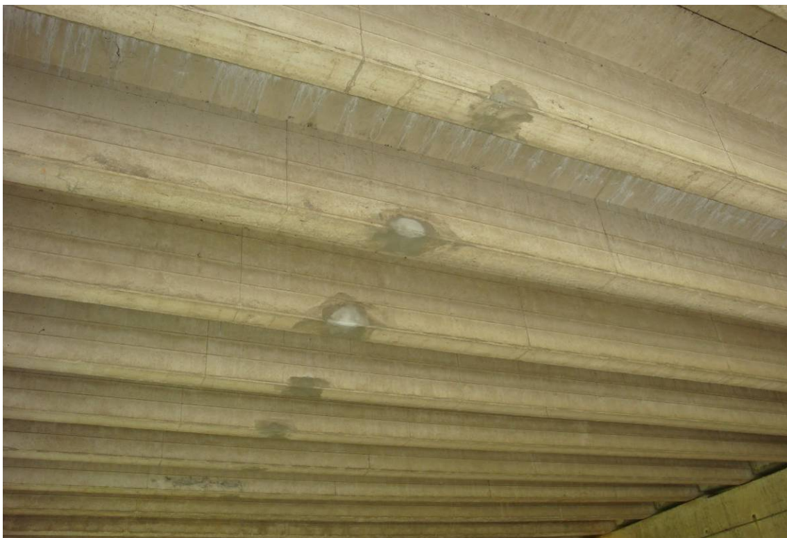
Foto 6 – Vista intradosso – cls. ripristinato sulle travi in seguito ad un urto di autoveicolo
