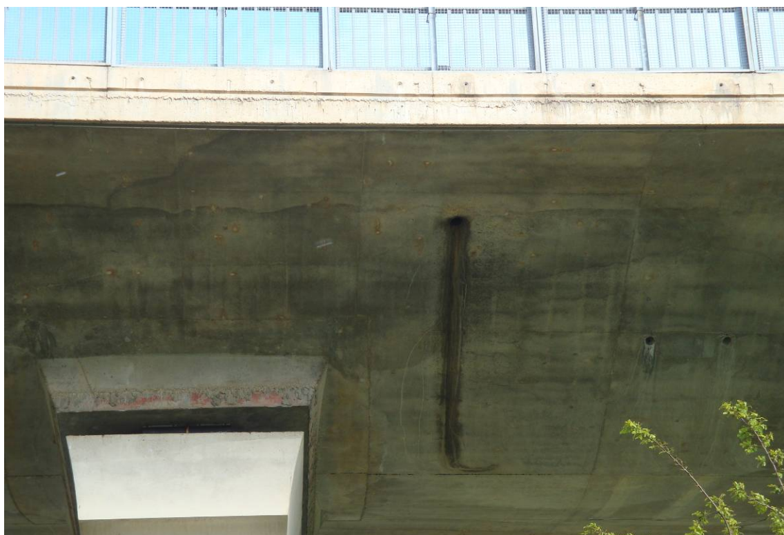
Foto 23 – Vista intradosso – scolature dai pluviali
