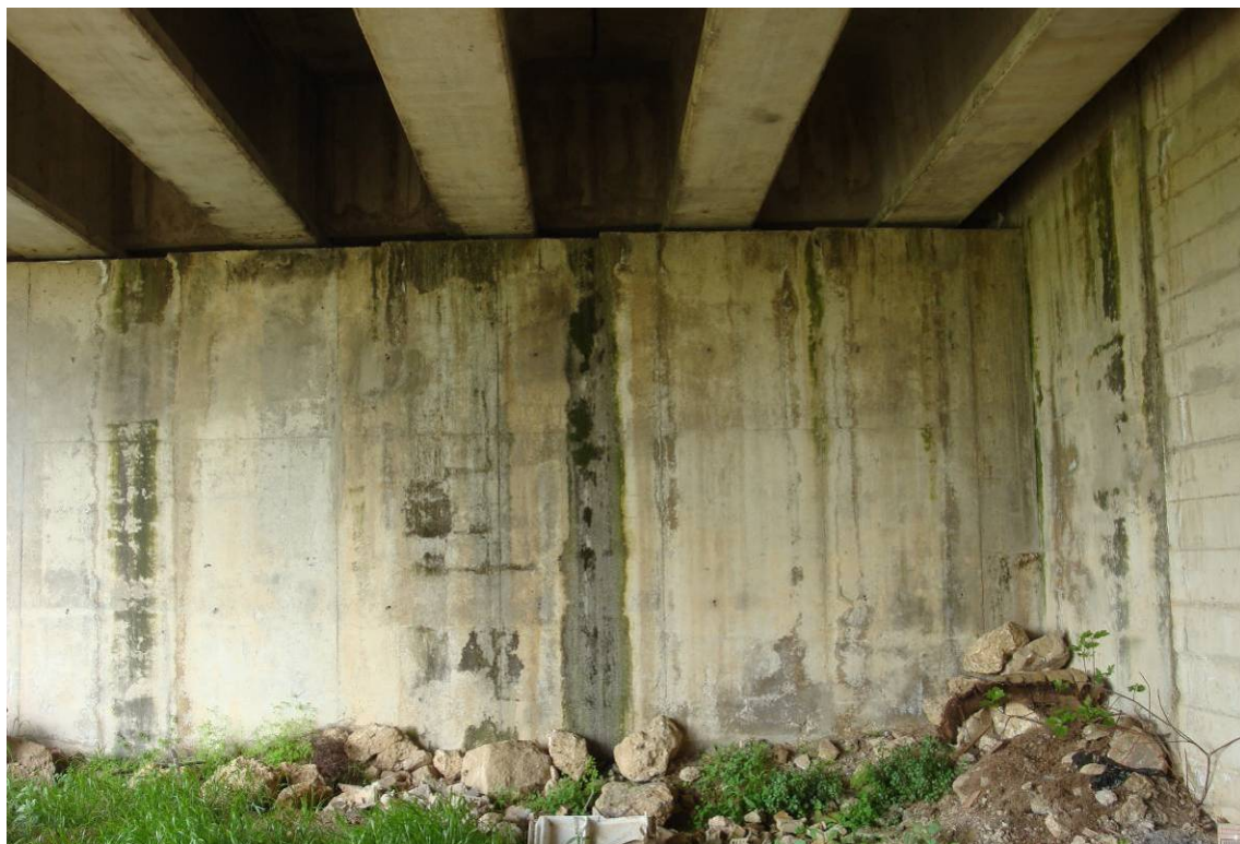
Foto 11– Scolature sulla spalla – cls. dilavato
