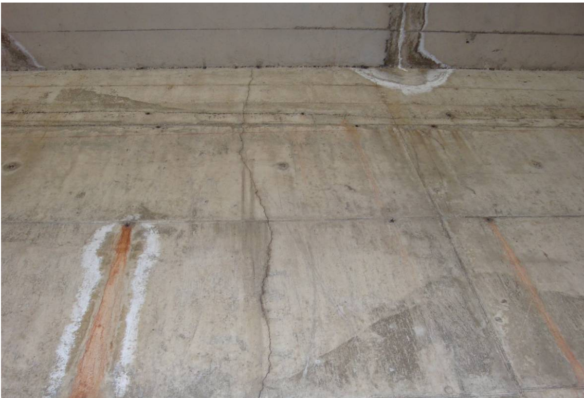
Foto 9 – Lesione verticale sulla spalla
