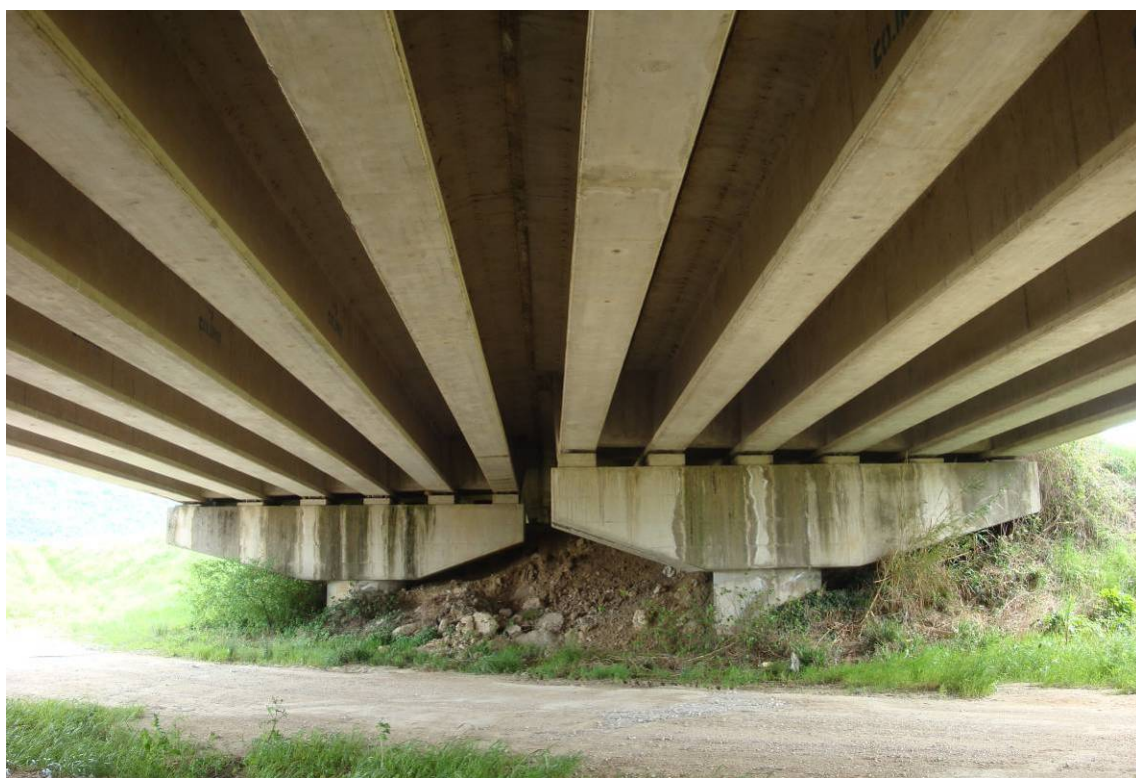
Foto 4 – Vista intradosso – scolature sui pulvini
