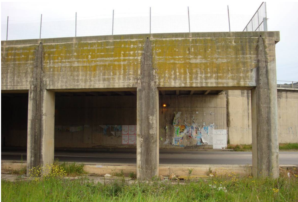
Foto 2 – Vista esterna della porte terminale sfinestrata della spalla – scolature e cls. dilavato
