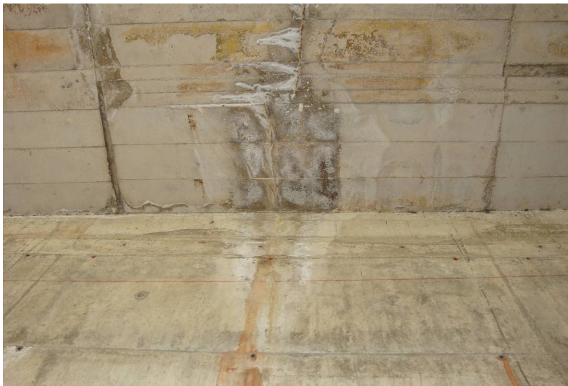
Foto 6 – Vista intradosso solettone – infiltrazioni e efflorescenze
