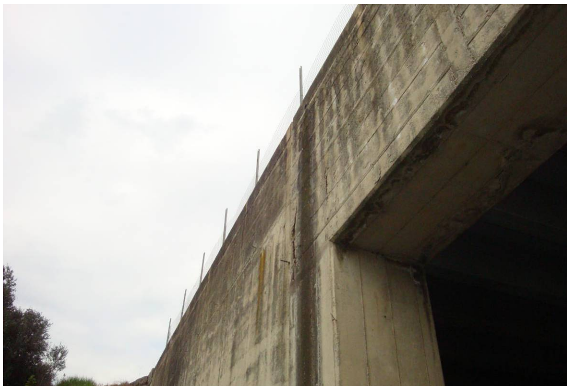
Foto 8 – Degrado muro, cls dilavato
