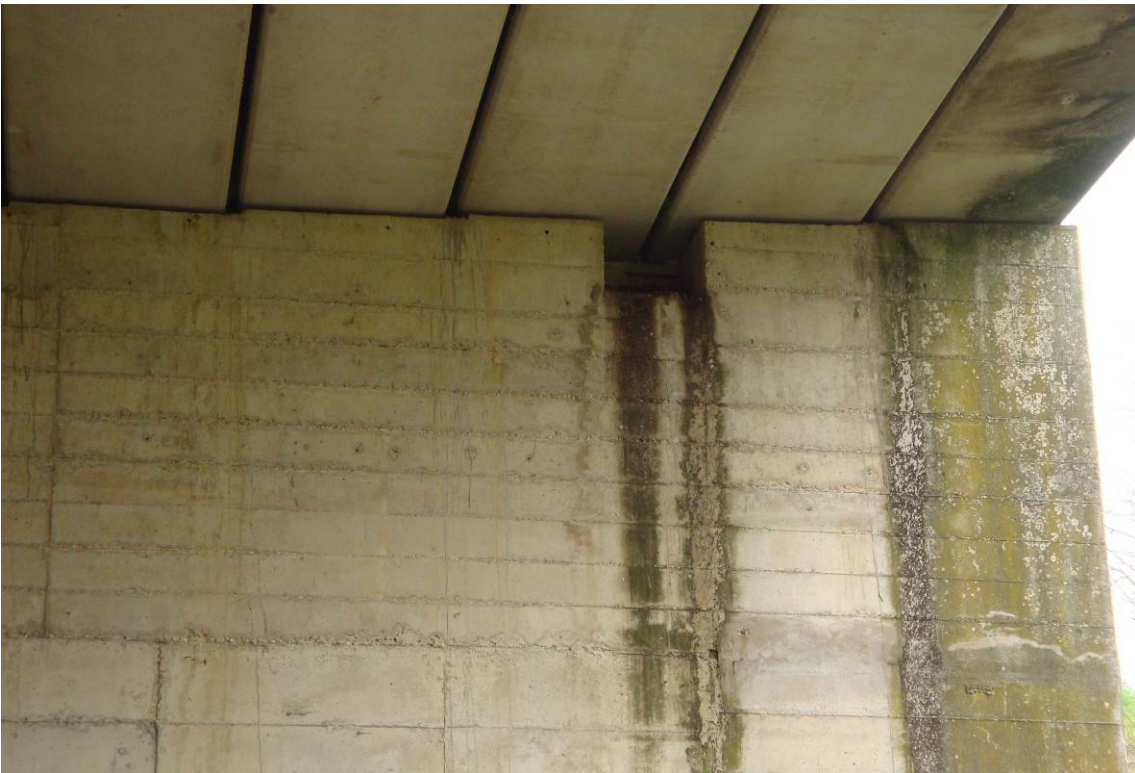
Foto 6 – Particolare infiltrazioni spalle
