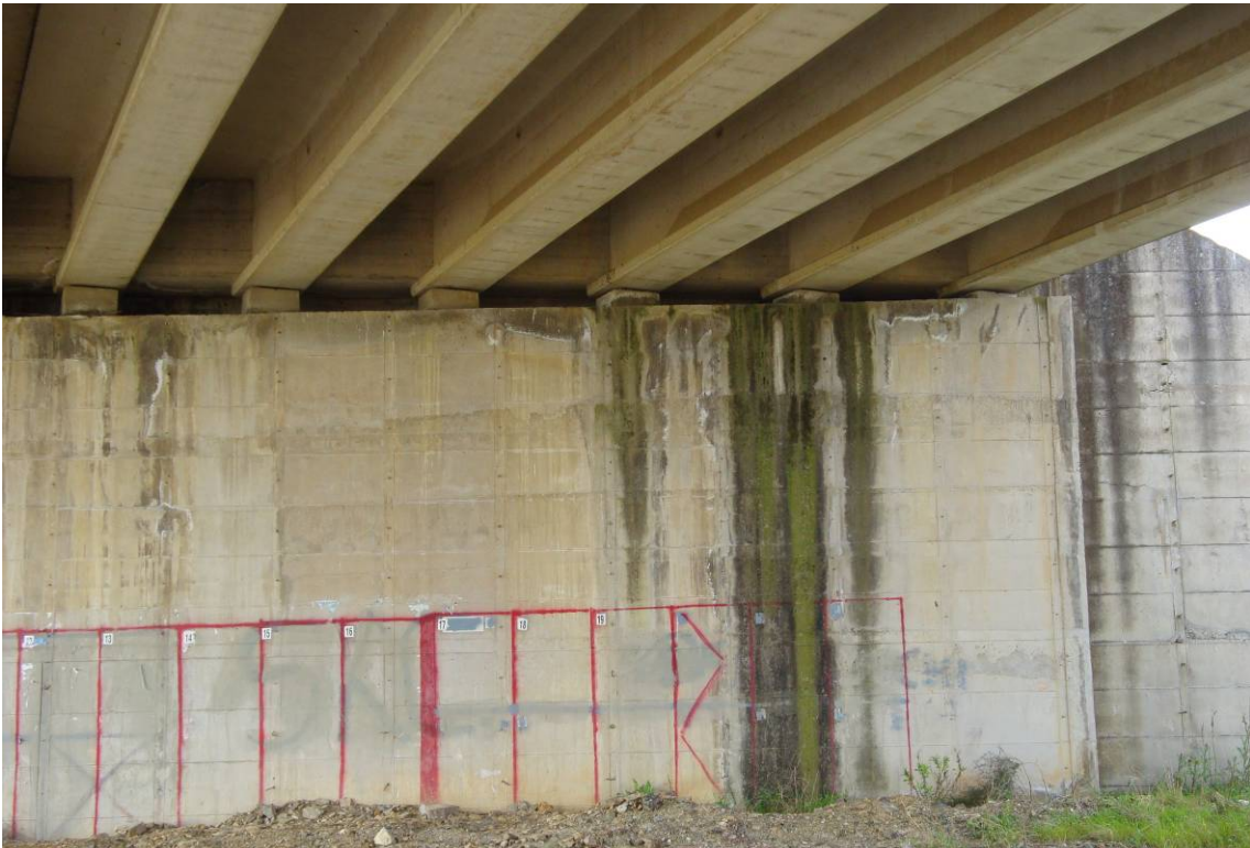
Foto 3 – Scolature, umidità e dilavamento del cls. sul muro frontale della spalla
