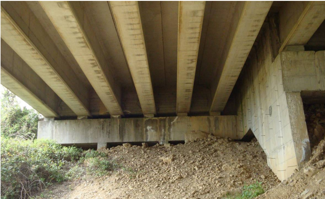
Foto 4 – Particolare spalla a rilevato passante – umidità e scoloriture sulla trave cuscino e sull'intradosso delle travi
