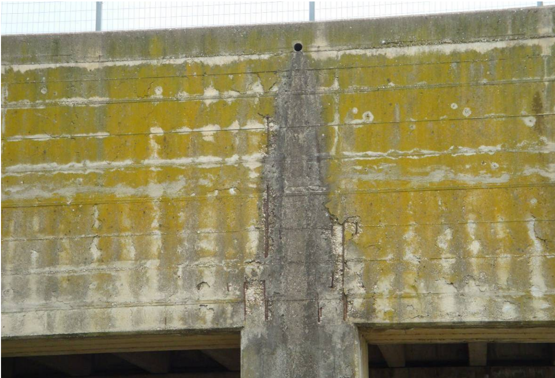
Foto 3 – Esterno della parte terminale sfinestrata della spalla – scolature, cls. dilavato armature scoperte e ossidate
