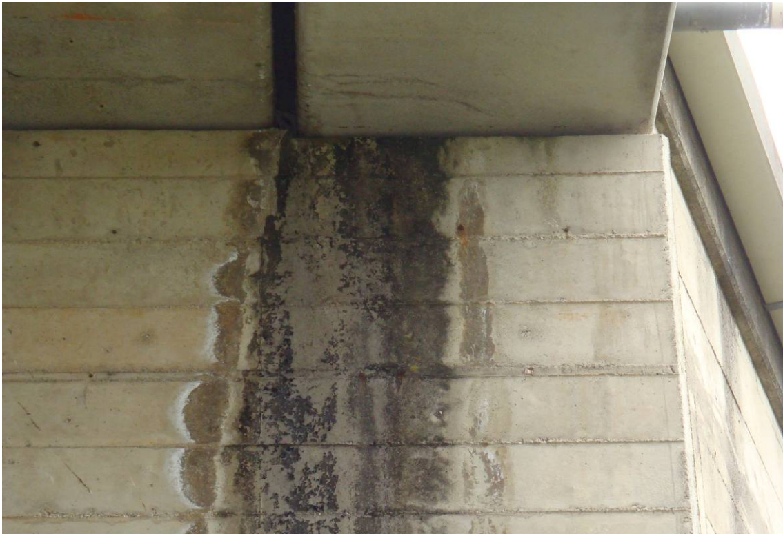
Foto 5 – Particolare infiltrazioni spalle
