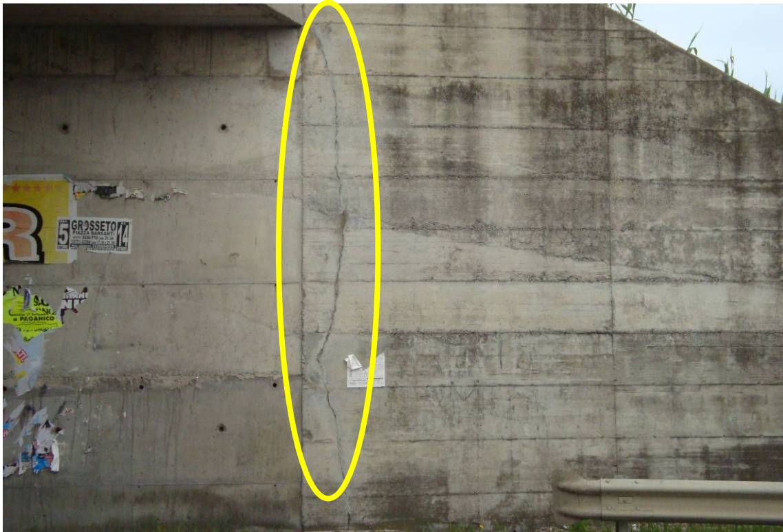
Foto 3 – Vista muro d'ala - lesione
