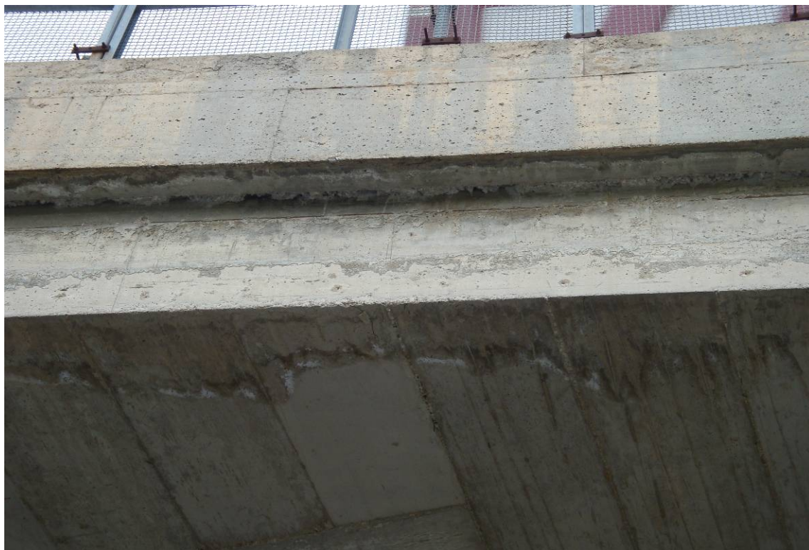
Foto 3 – Umidità e efflorescenze sull'intradosso del solettone
