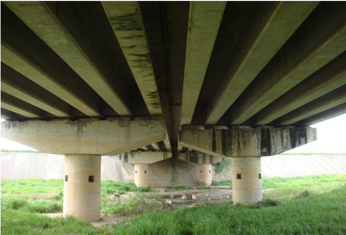
Foto 3 – Vista intradosso – scolature sui pulvini e intradosso trave di bordo
