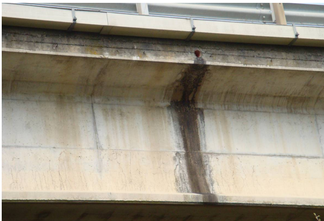
Foto 12 – scolature sul fianco della trave
