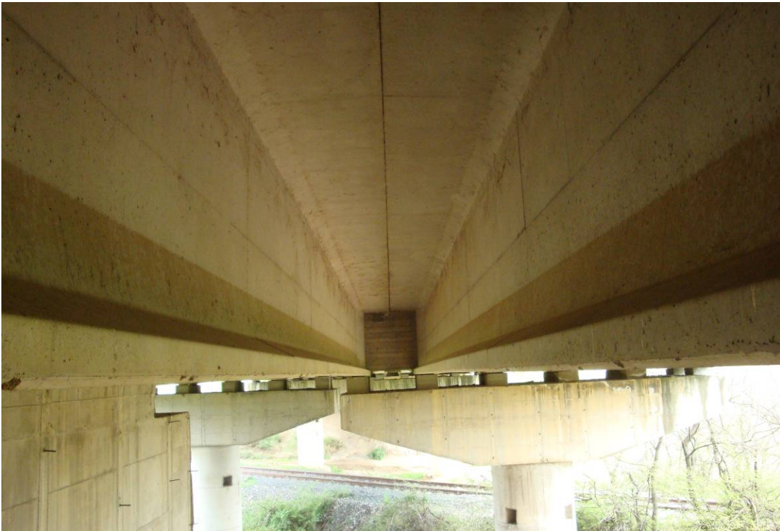
Foto 9 – Particolare del giunto longitudinale tra 2 travi
