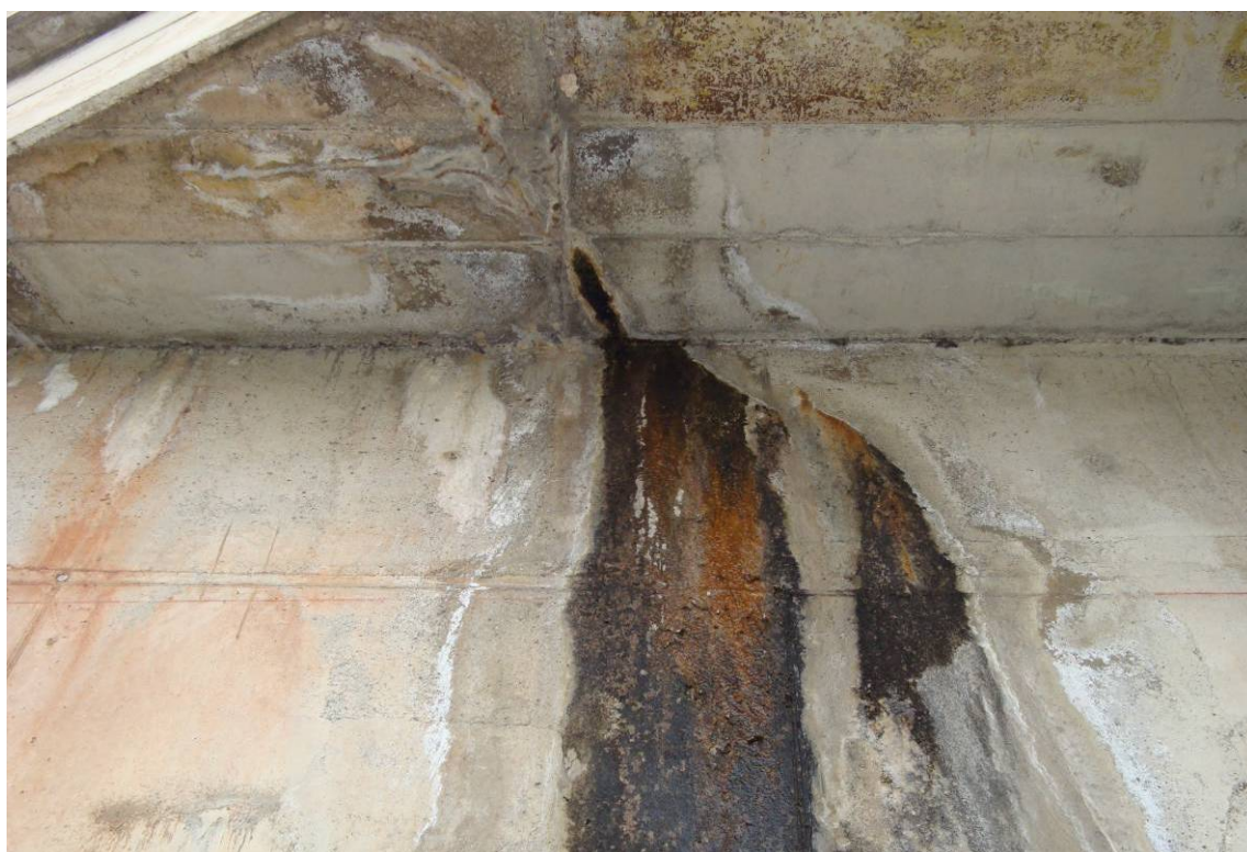
Foto 7 – infiltrazioni e efflorescenze sull'intradosso del solettone e sulla spalla
