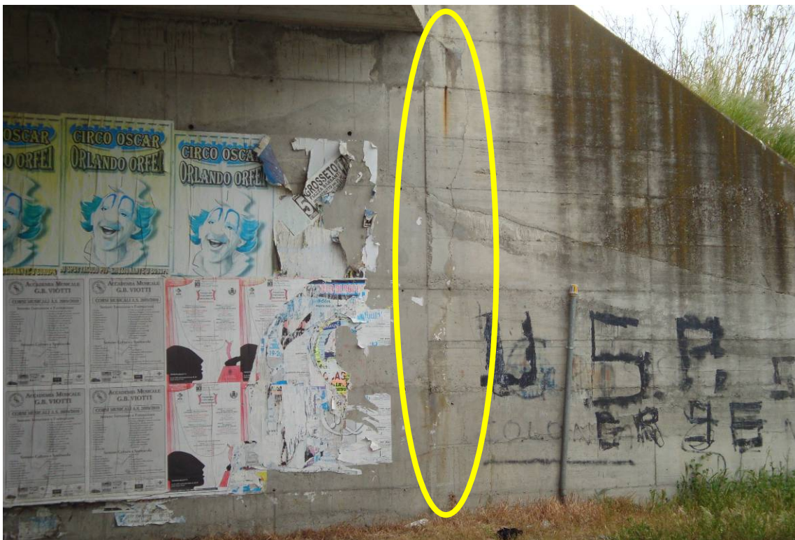
Foto 4 – Vista muro d'ala - lesione
