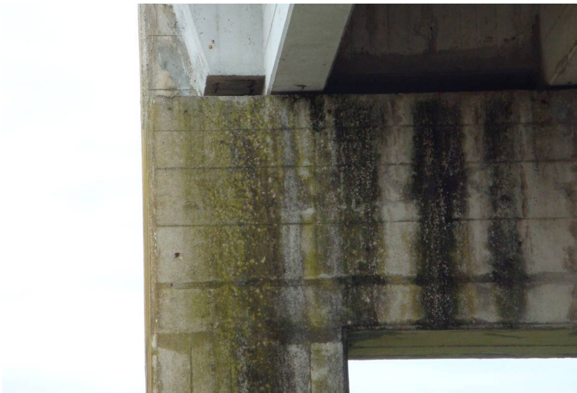
Foto 5 – Interno della parte terminale sfinestrata della spalla – scolature, cls. dilavato
