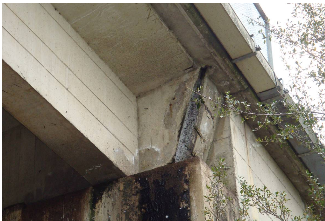
Foto 4 – Cls. umido e dilavato sui traversi e sul muro frontale della spalla
