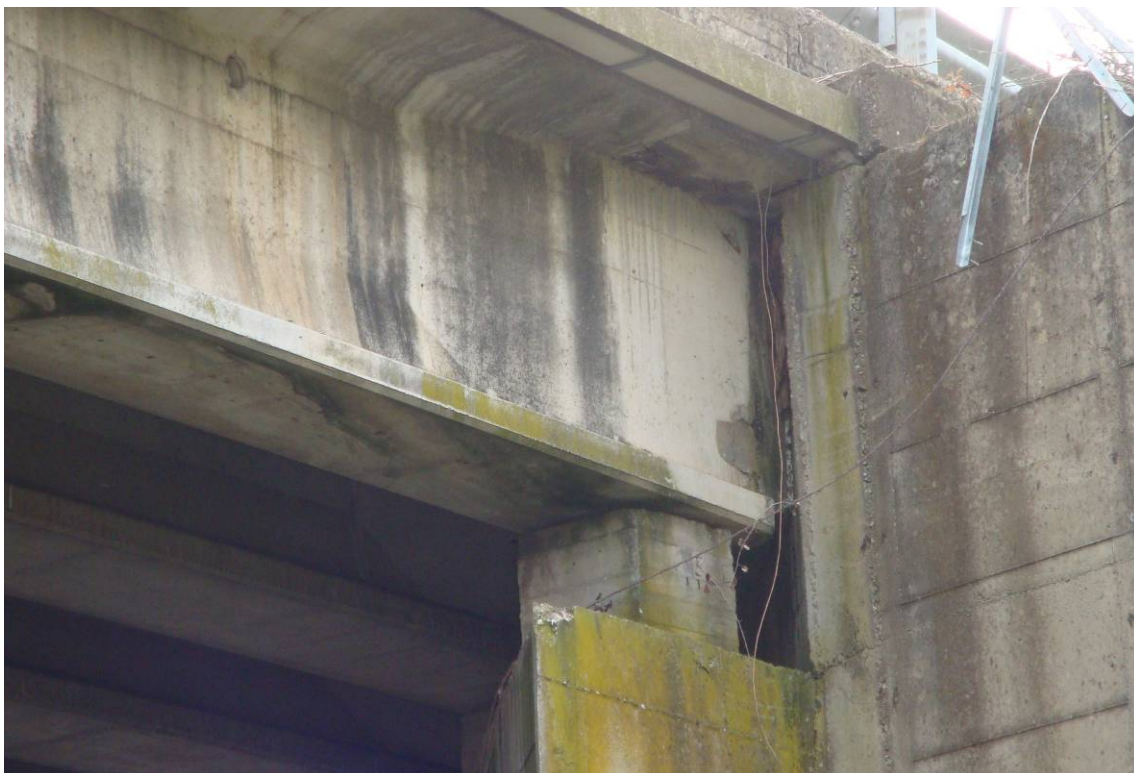
Foto 5 – Dilavamento del cls. nelle zone esposte agli agenti atmosferici
