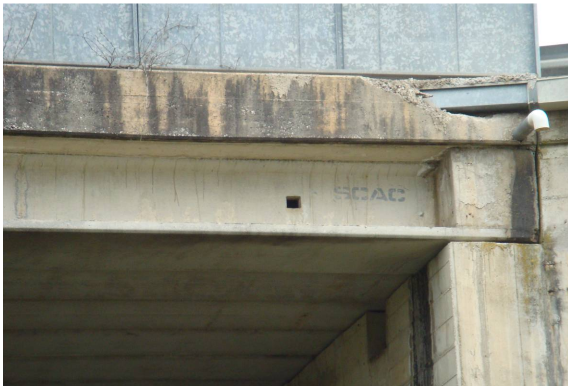
Foto 3 – Appoggio delle travi sulla spalla – dilavamento del cls. dei cordoli
