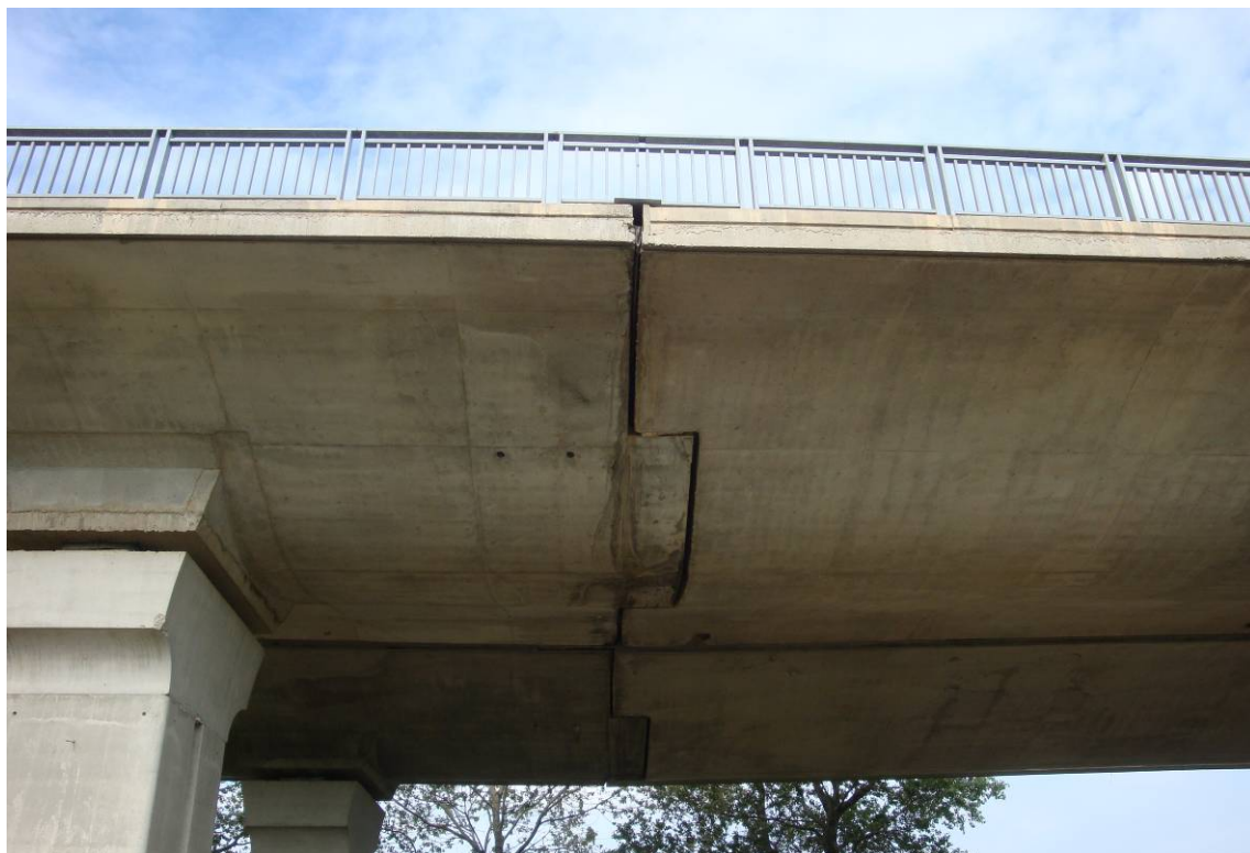
Foto 15 – Vista intradosso – particolare della seggiola Gerber
