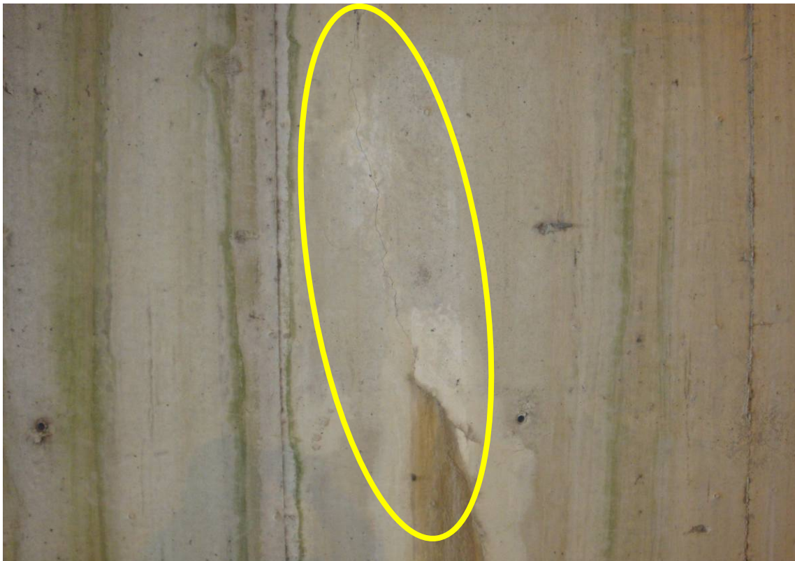
Foto 10 – Lesione verticale sul muro frontale della spalla
