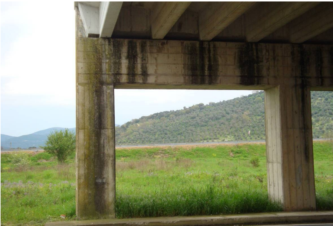
Foto 4 – Vista interna della parte terminale sfinestrata della spalla – scolature e cls. dilavato
