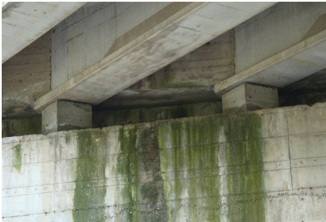
Foto 7 – Dilavamento del cls. della spalla
