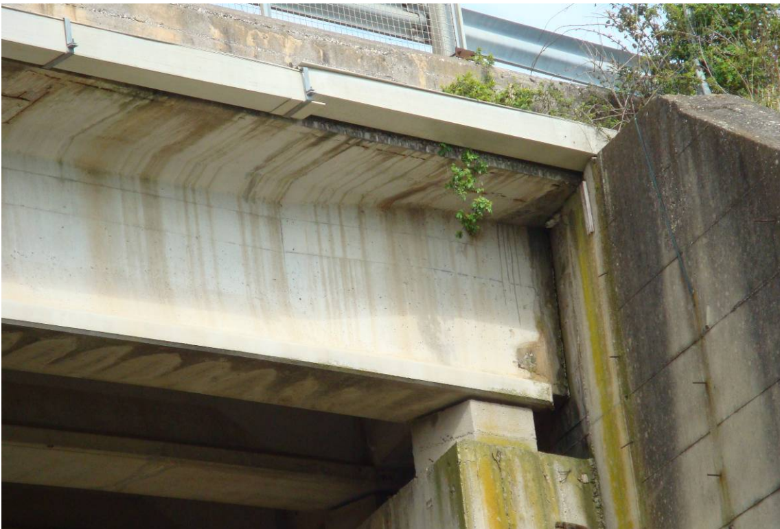
Foto 6 – Particolare degrado della trave e del muro d'ala della spalla
