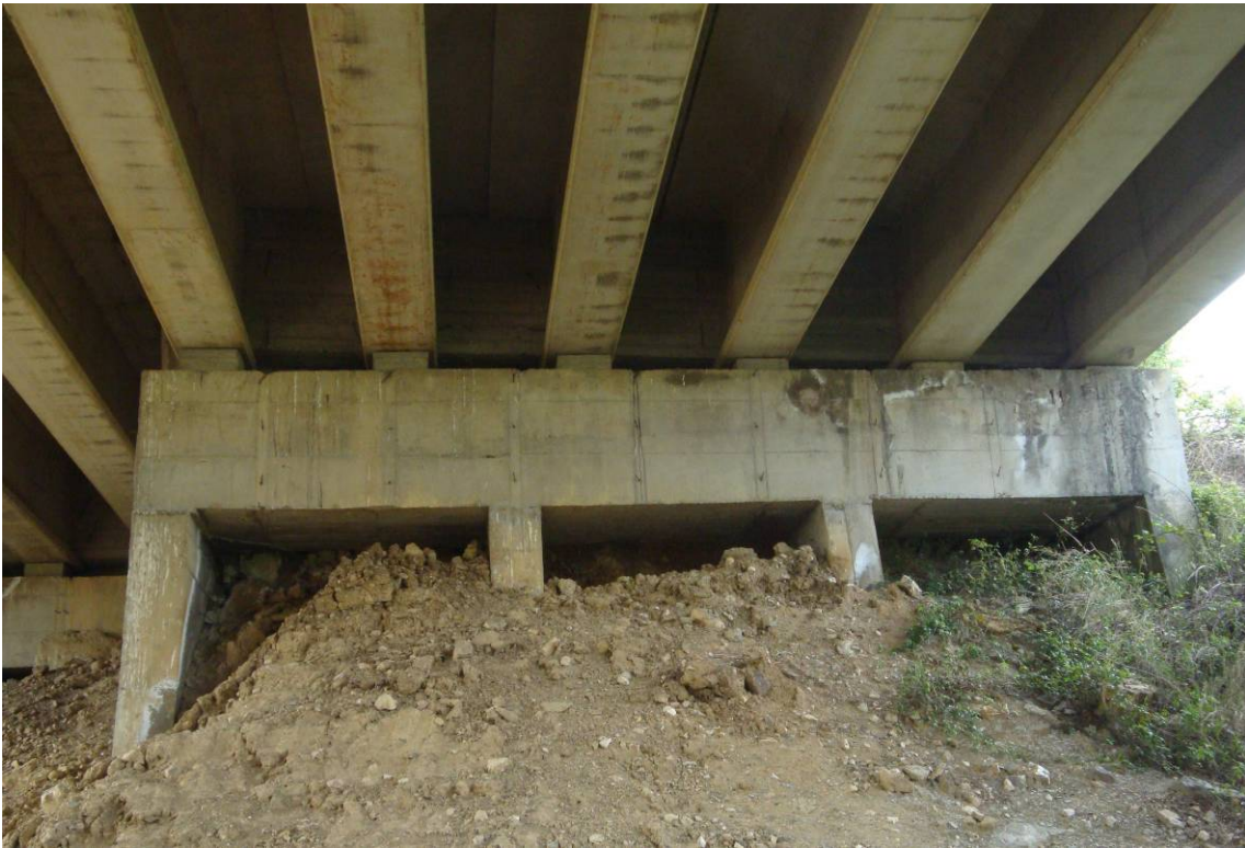
Foto 3 – Particolare spalla a rilevato passante – umidità e scoloriture sulla trave cuscino e sull'intradosso delle travi
