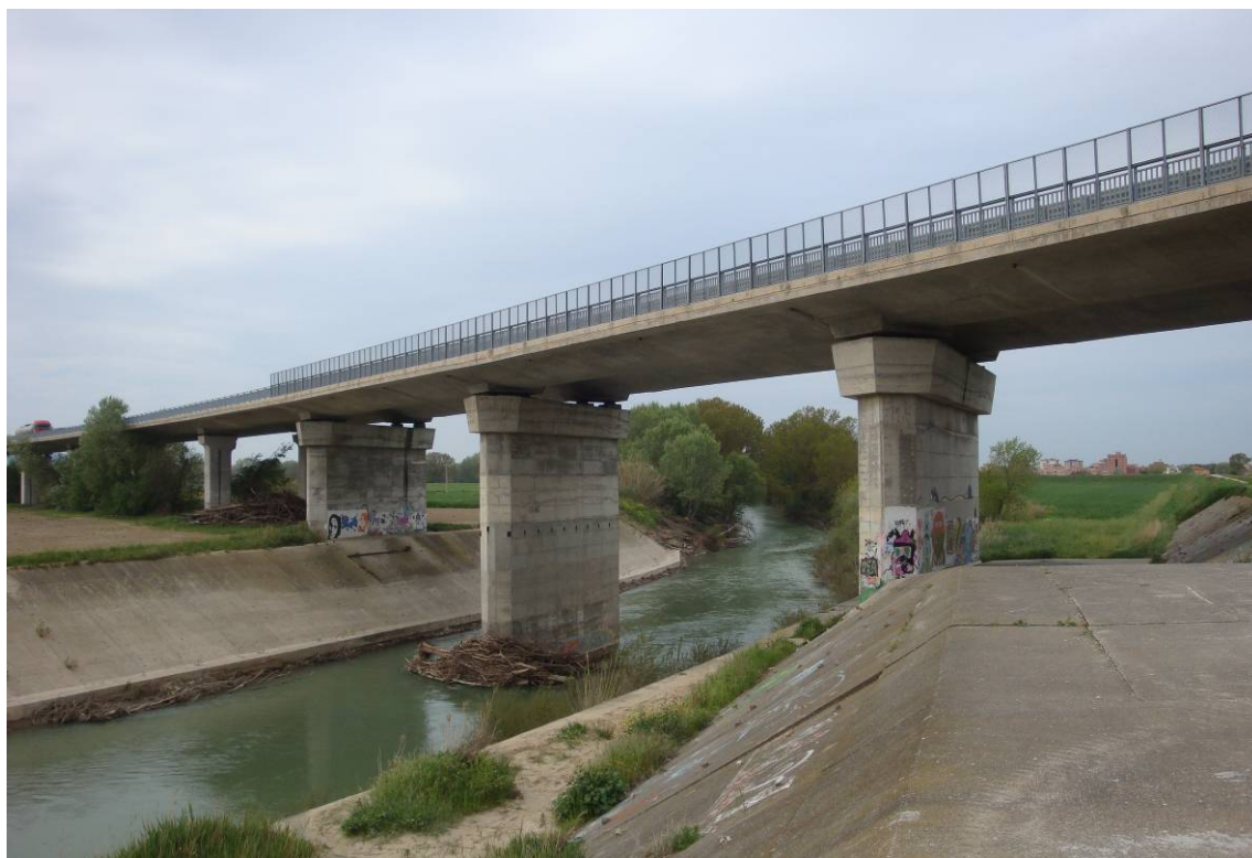
Foto 4 – Vista laterale delle campate sul fiume Ombrone – pile a setto in c.a.
