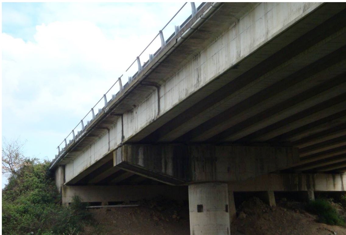
Foto 5 – Vista laterale – scolature sulla trave di bordo e sul pulvino
