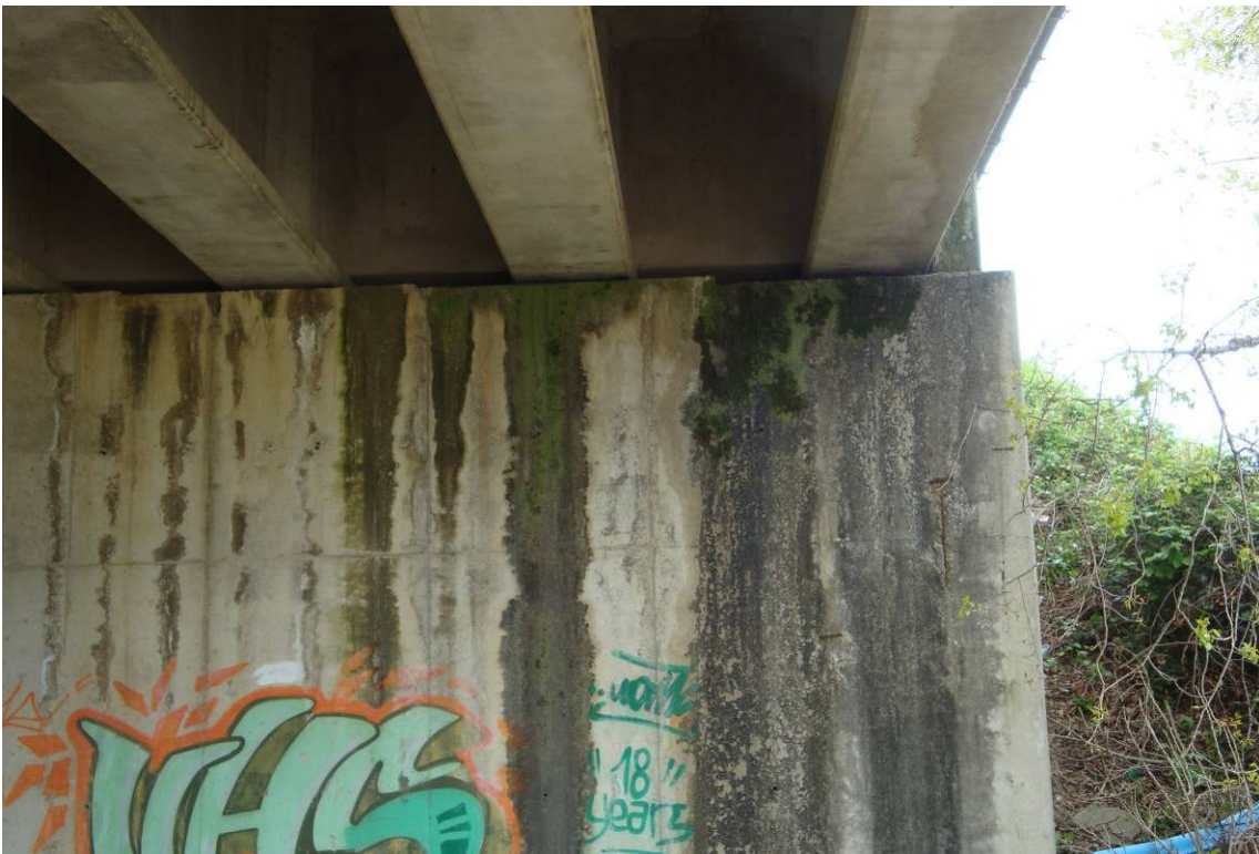
Foto 10 – Scolature sulla spalla – cls. dilavato
