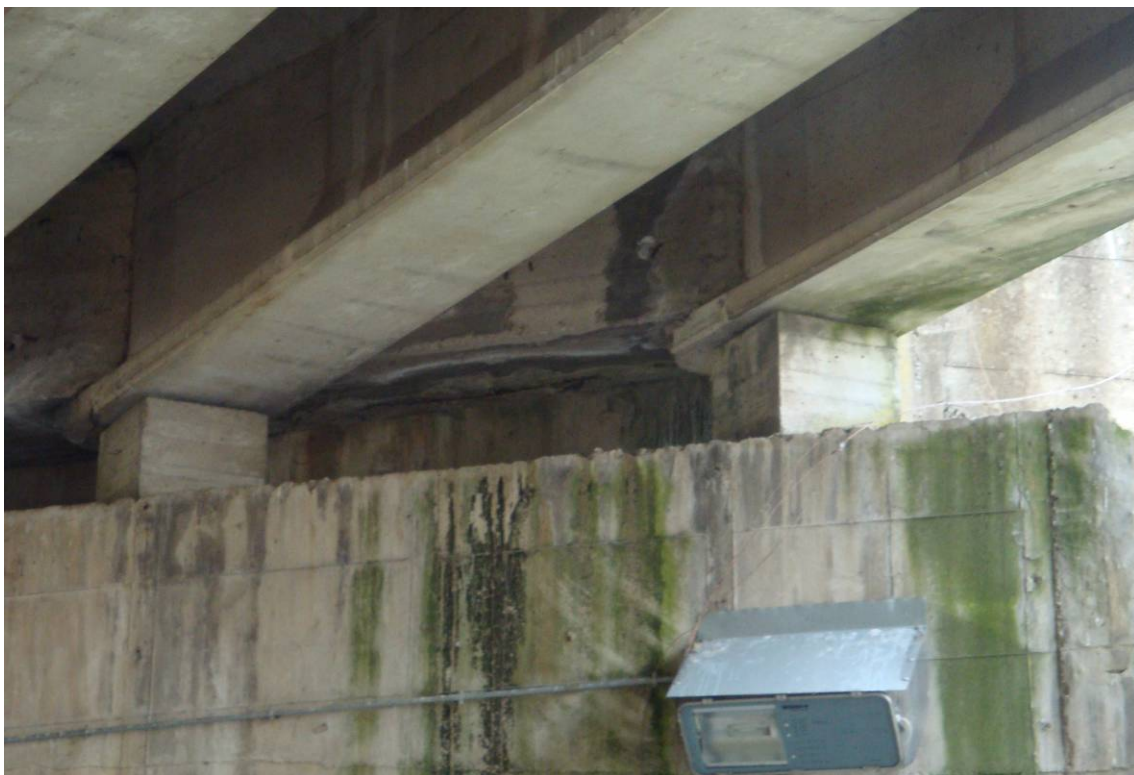
Foto 6 – Dilavamento del cls. della spalla
