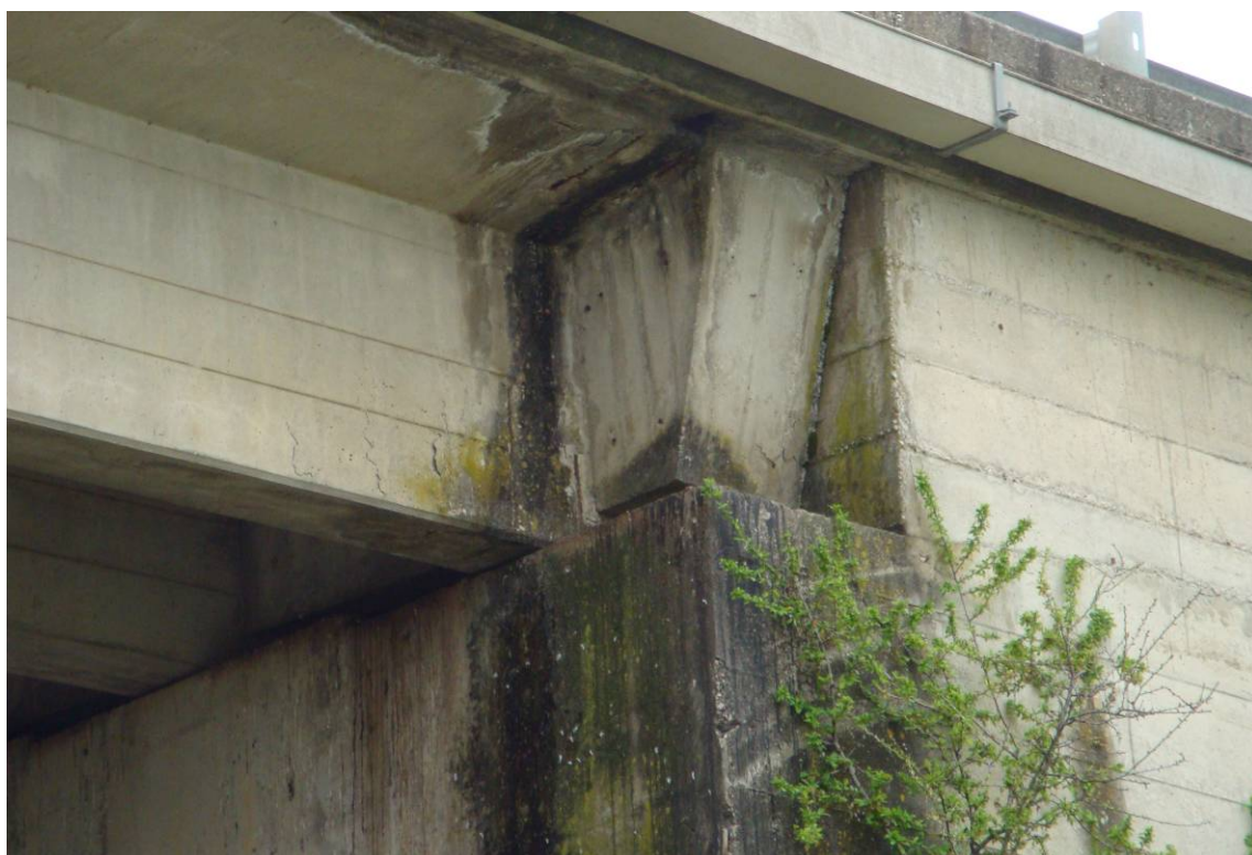
Foto 4 – Cls umido e dilavato sulla testata della trave e del traverso e sulla spalla
