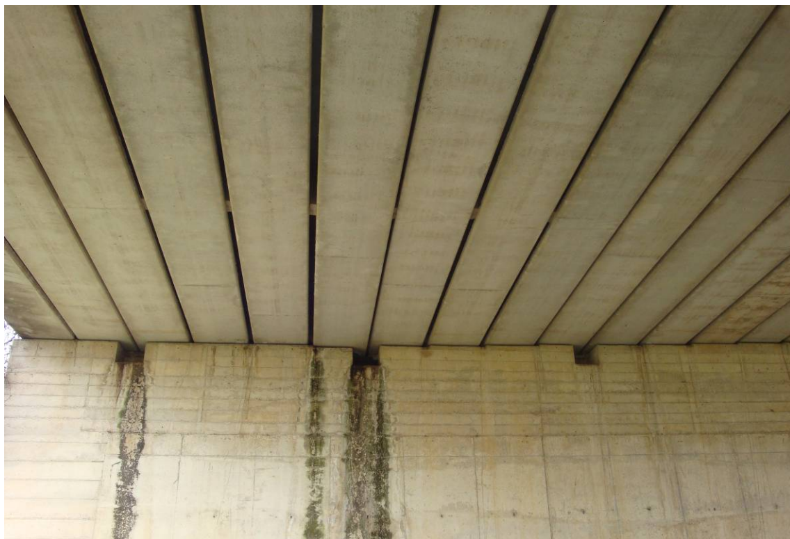
Foto 2 – Vista intradosso – scolature sulla spalla
