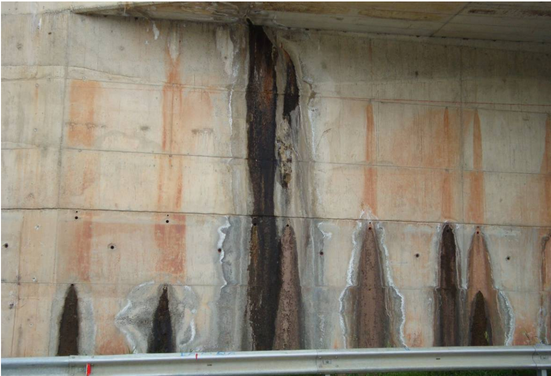
Foto 3 – Scolature, umidità e efflorescenze sulla spalla
