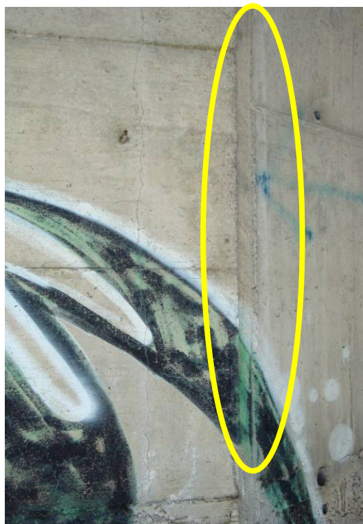
Foto 4 – Vista muro d'ala - lesione
