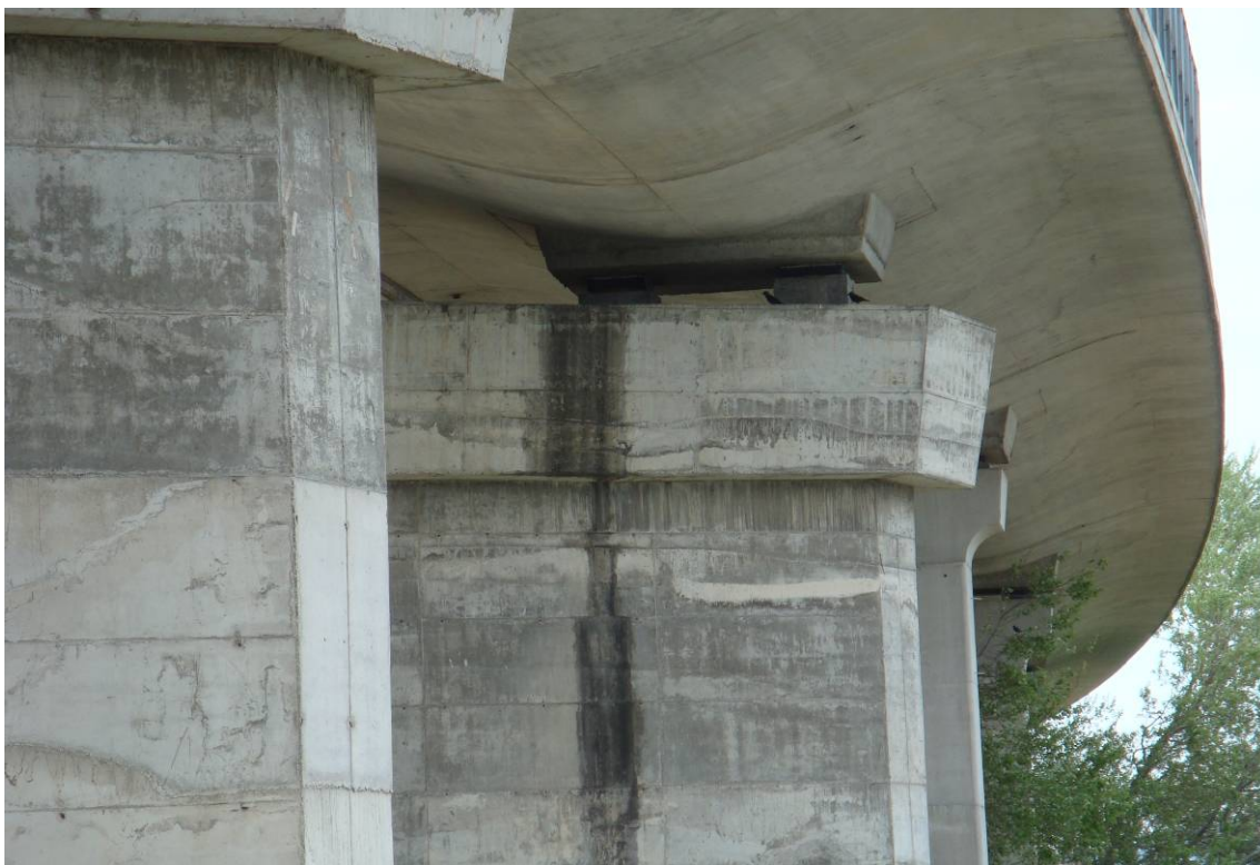
Foto 19 – Scolature delle acque meteoriche sulla pila
