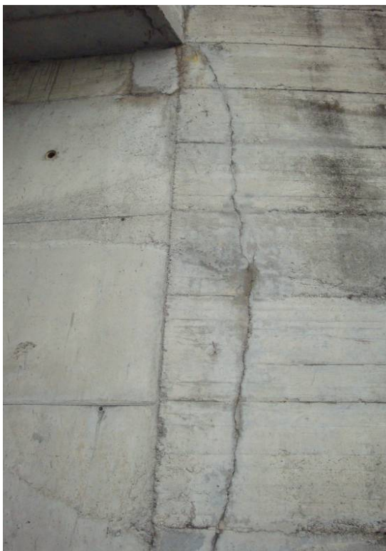
Foto 5 – Particolare lesione muro d'ala
