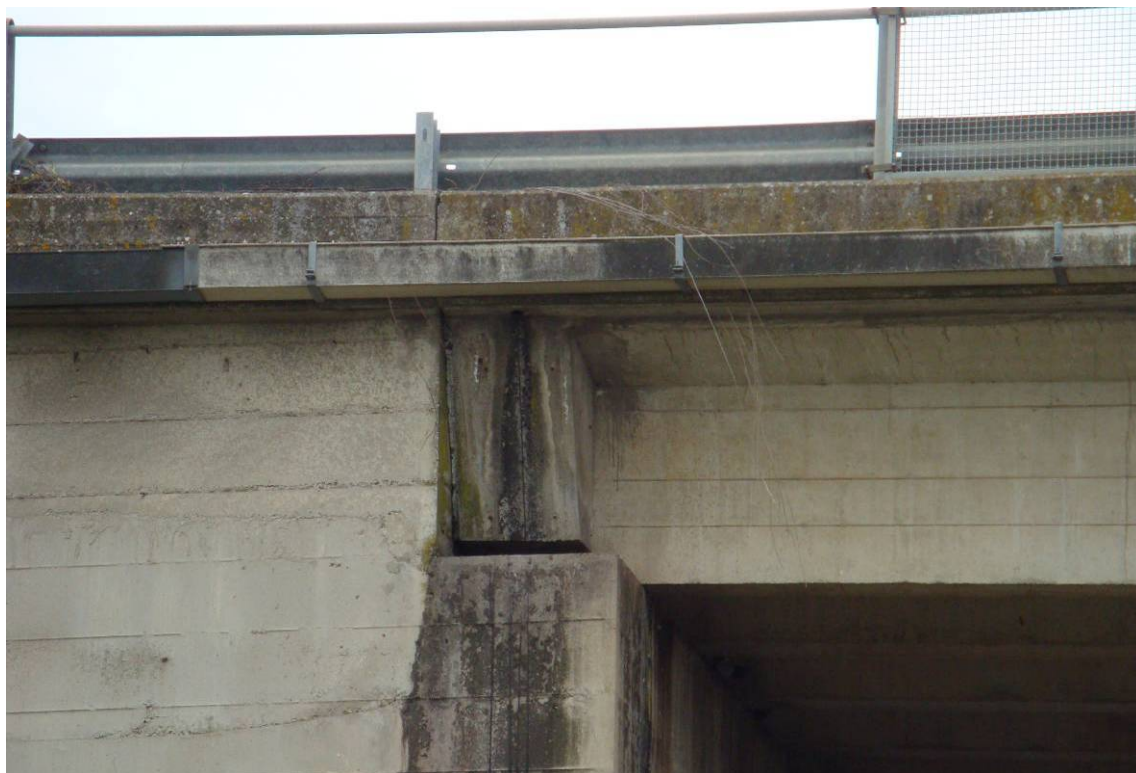
Foto 5 – Cls. umido e dilavato sui traversi e sulla spalla
