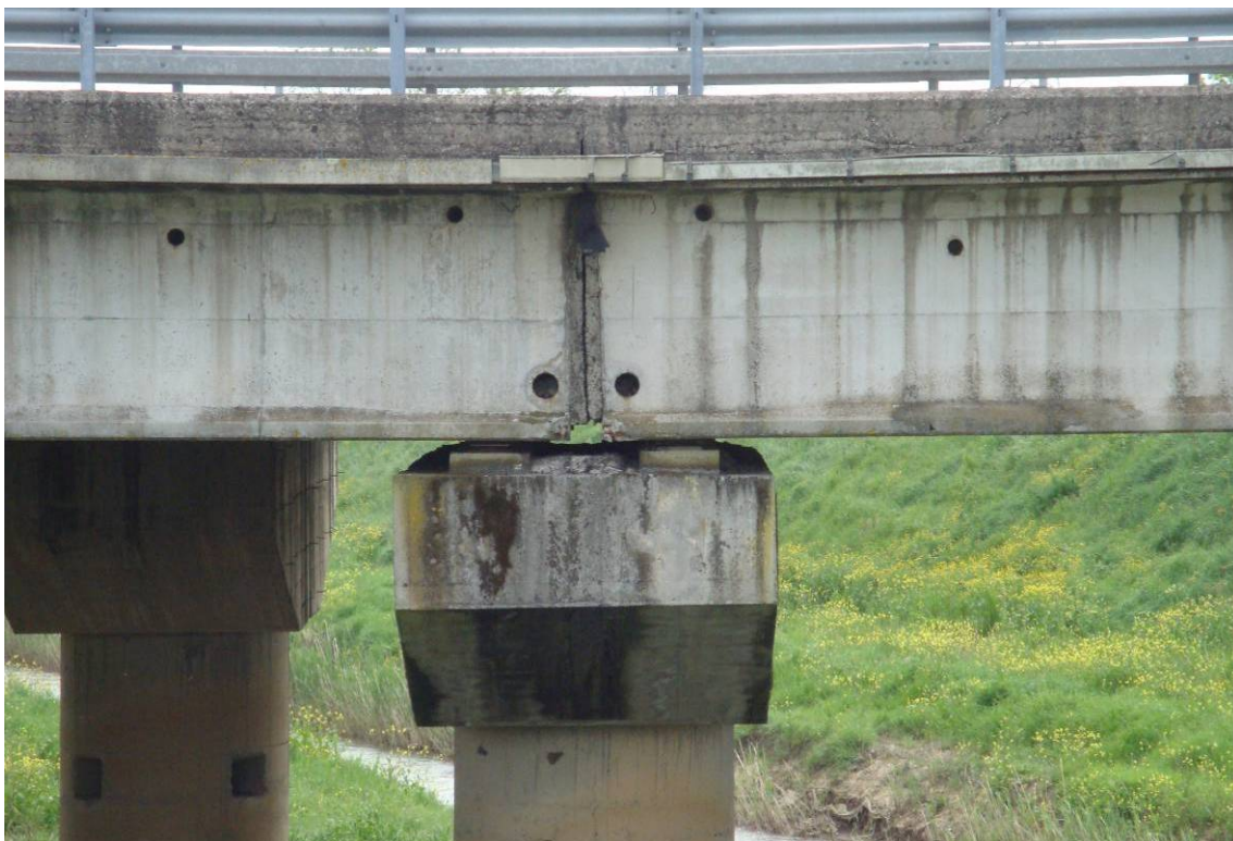
Foto 11– scolature e cls. dilavato su pulvini, testate travi e cordoli
