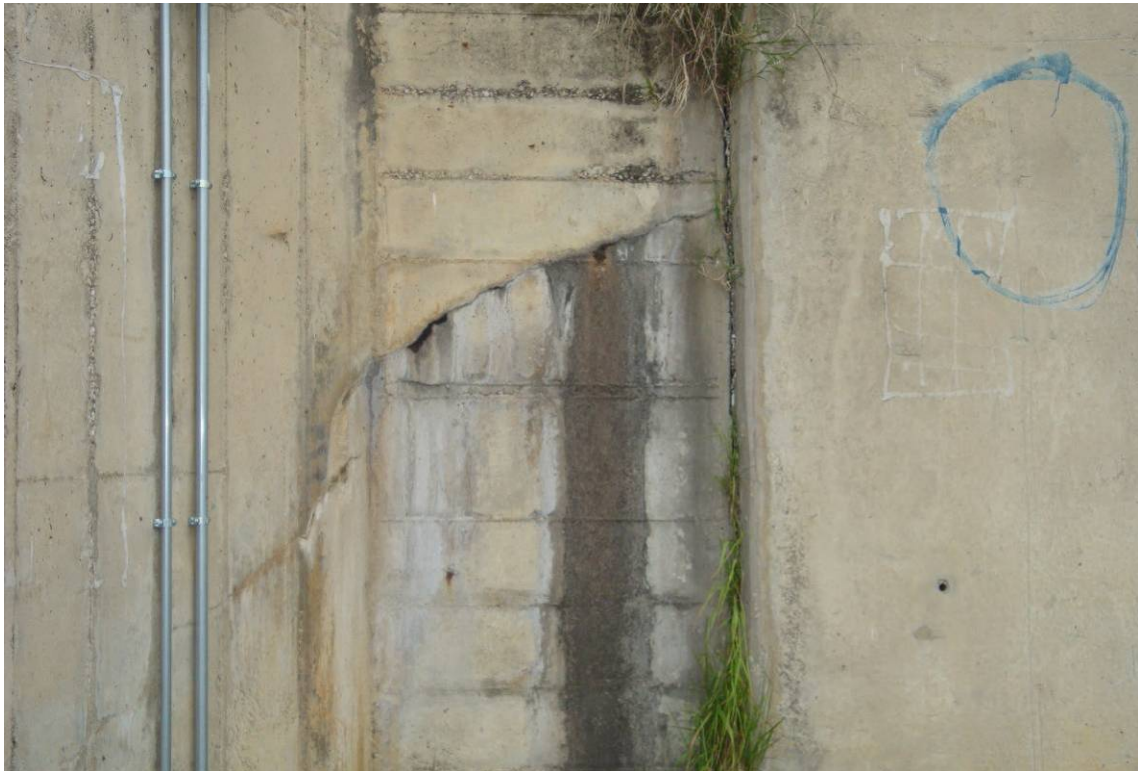
Foto 9 – Lesione sul muro andatore della spalla
