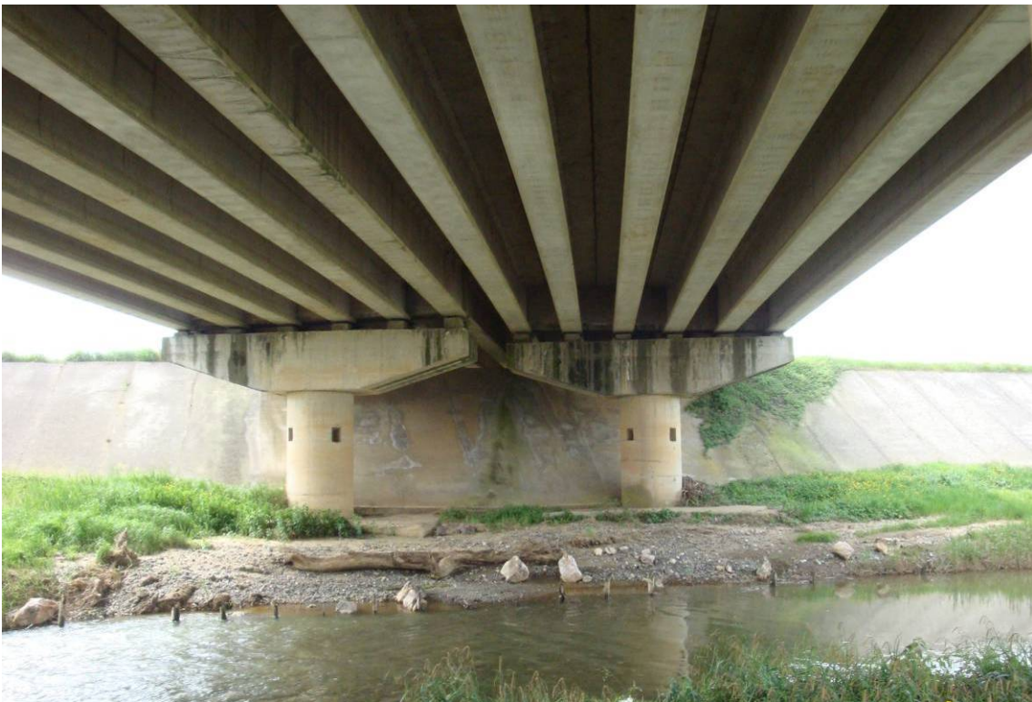
Foto 4 – Vista intradosso – scolature sui pulvini e intradosso trave di bordo
