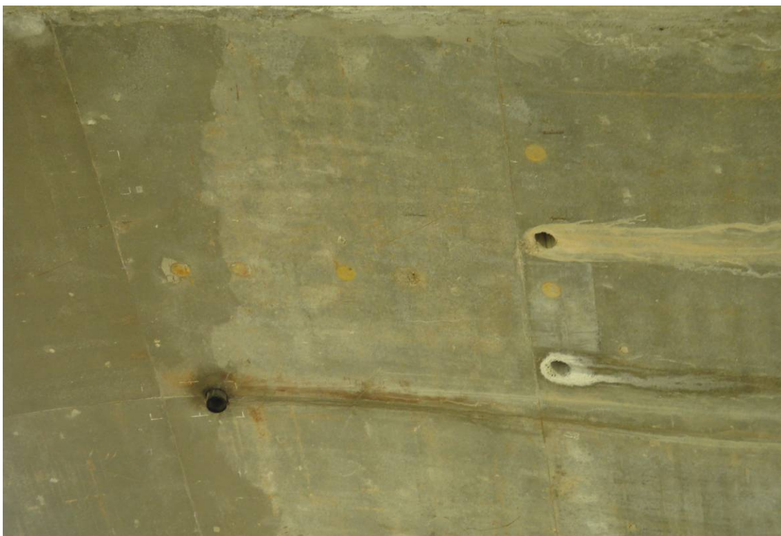
Foto 20 – Vista intradosso impalcato – scolature dai pluviali
