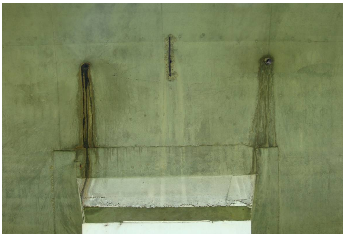
Foto 24 – Vista intradosso – scolature dai pluviali
