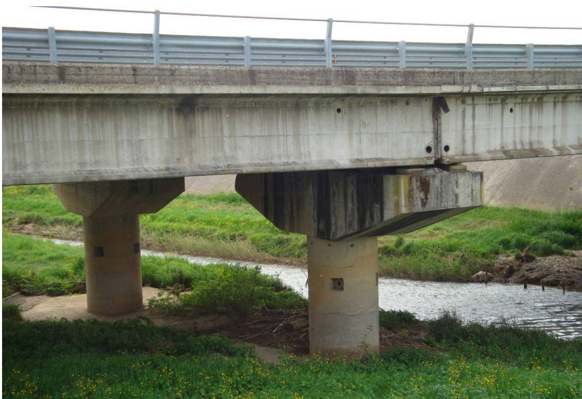
Foto 10 – scolature e cls. dilavato su pulvini, testate travi e cordoli
