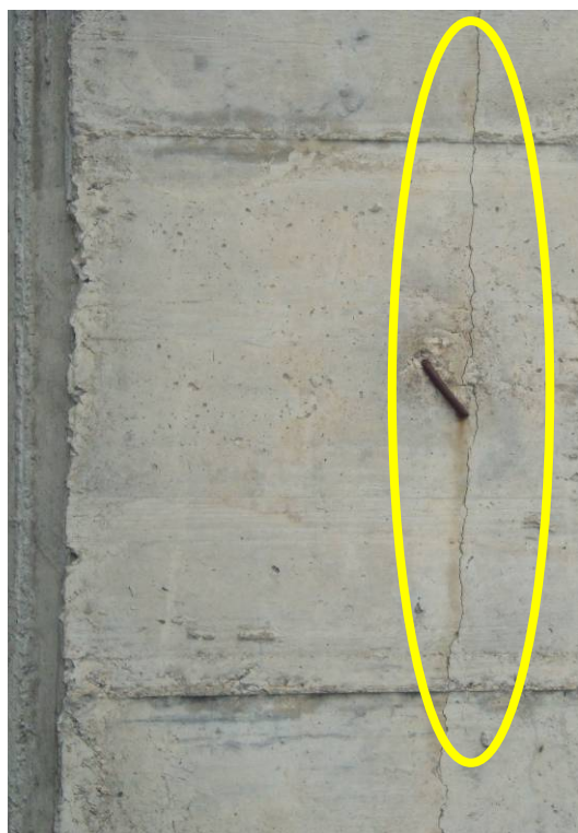
Foto 6 – Particolare lesione muro d'ala
