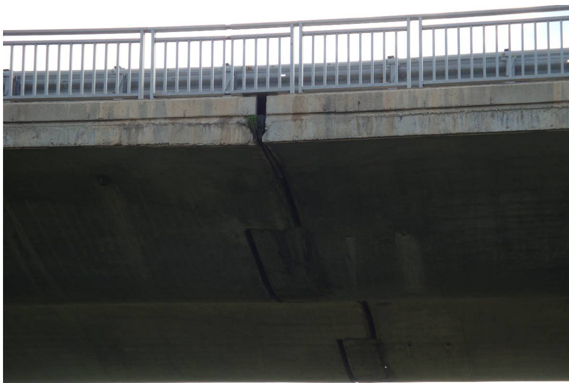
Foto 16 – Vista intradosso – particolare della seggiola Gerber
