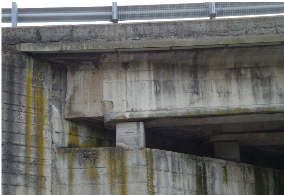
Foto 4 – Dilavamento del cls. nelle zone esposte agli agenti atmosferici
