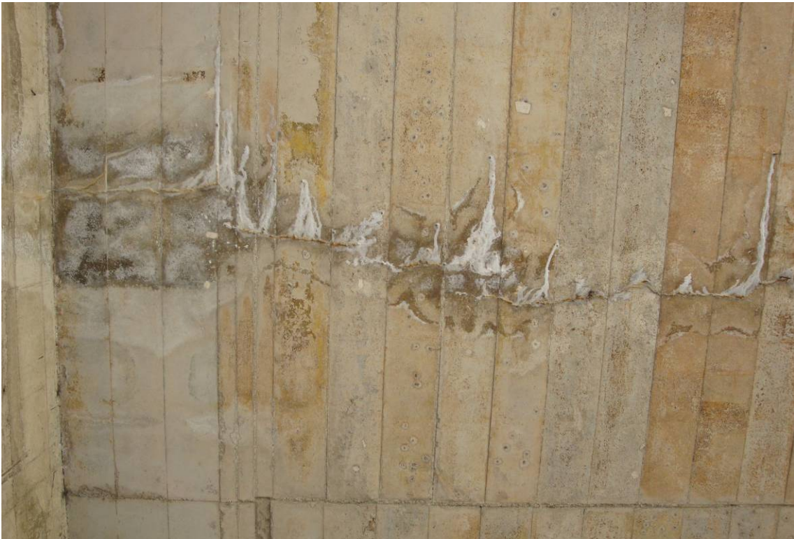
Foto 8 – Lesioni trasversali, infiltrazioni e efflorescenze sull'intradosso del solettone
