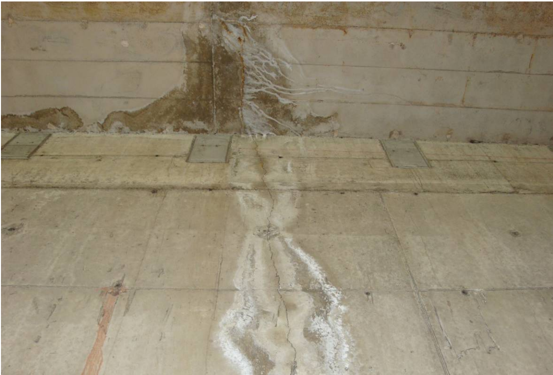
Foto 10 – Lesione sul solettone e sulla spalla, con infiltrazioni ed efflorescenze
