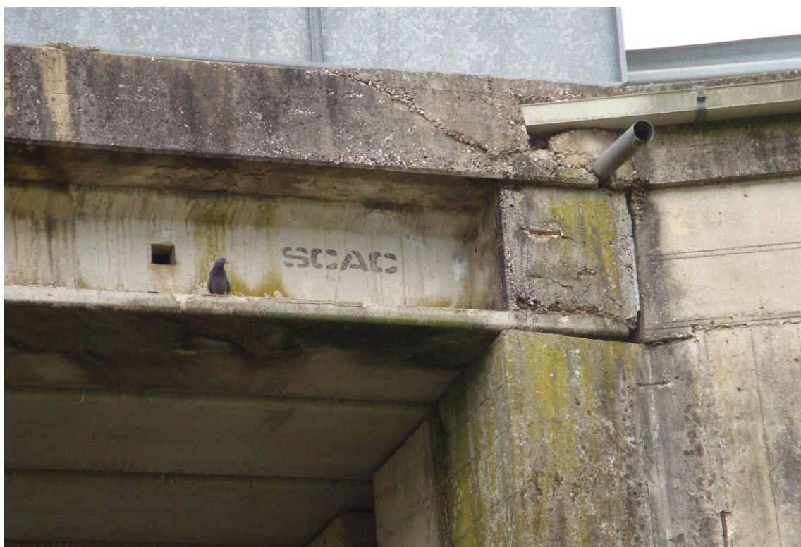
Foto 4 – dilavamento del cls. dei cordoli, delle testate dei traversi e della spalla
