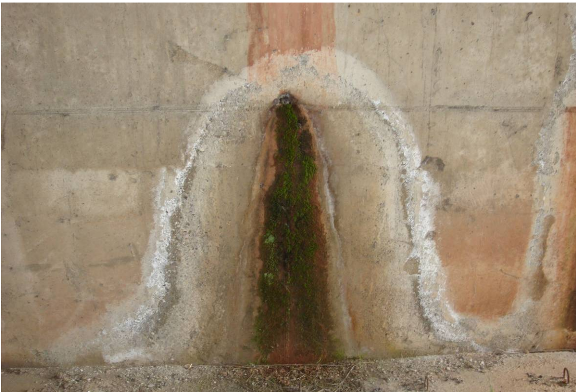
Foto 11 – infiltrazioni ed efflorescenze sulla spalla
