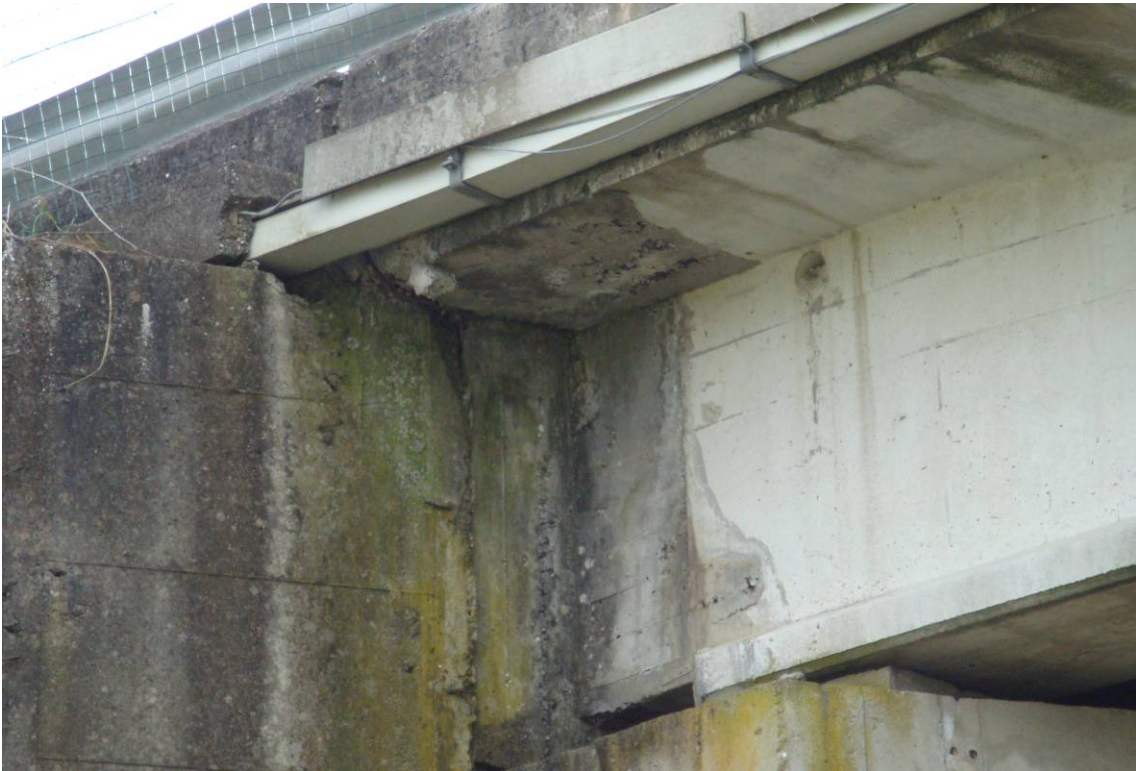
Foto 5 – Particolare degrado trave e del muro d'ala della spalla
