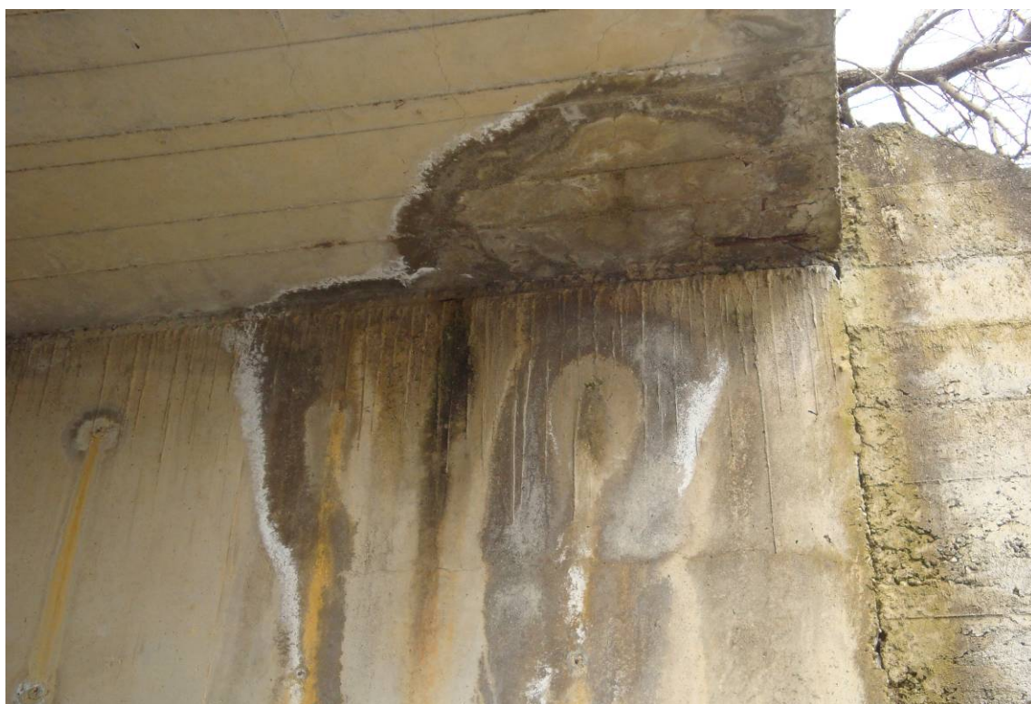
Foto 3 – Infiltrazione sul solettone e sulla spalla
