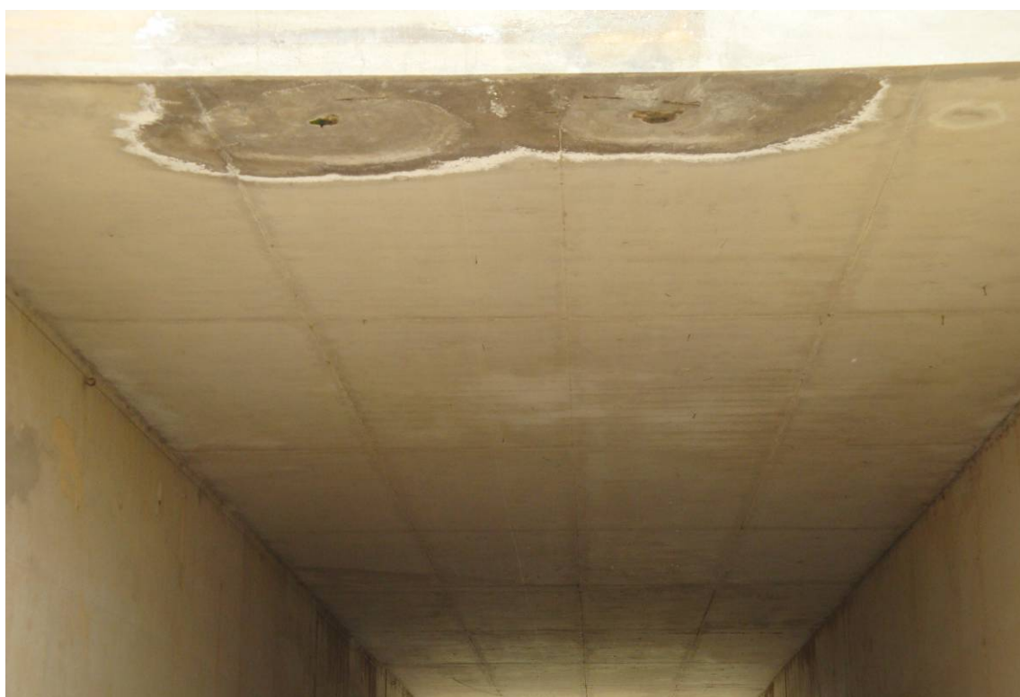
Foto 2 – Vista intradosso – infiltrazioni ed efflorescenze
