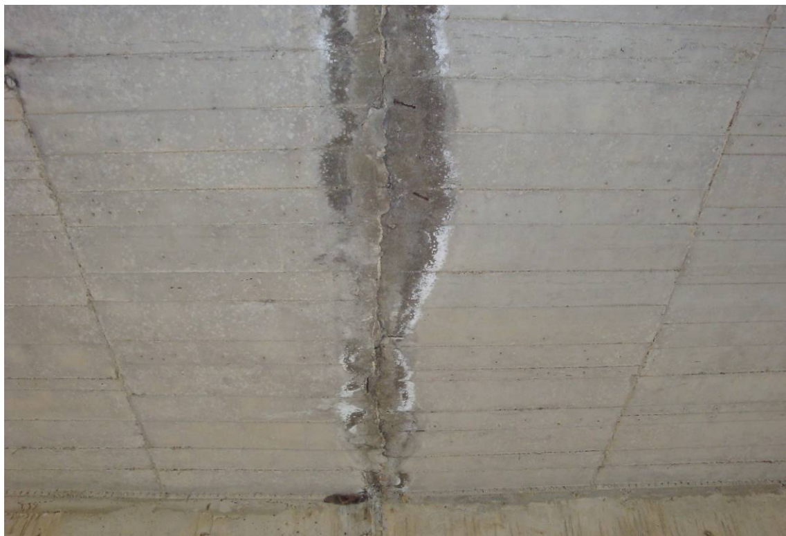
Foto 2 – Infiltrazione lungo il giunto trasversale del solettone
