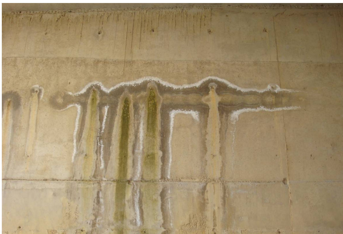
Foto 4 – Infiltrazione sulla spalla
