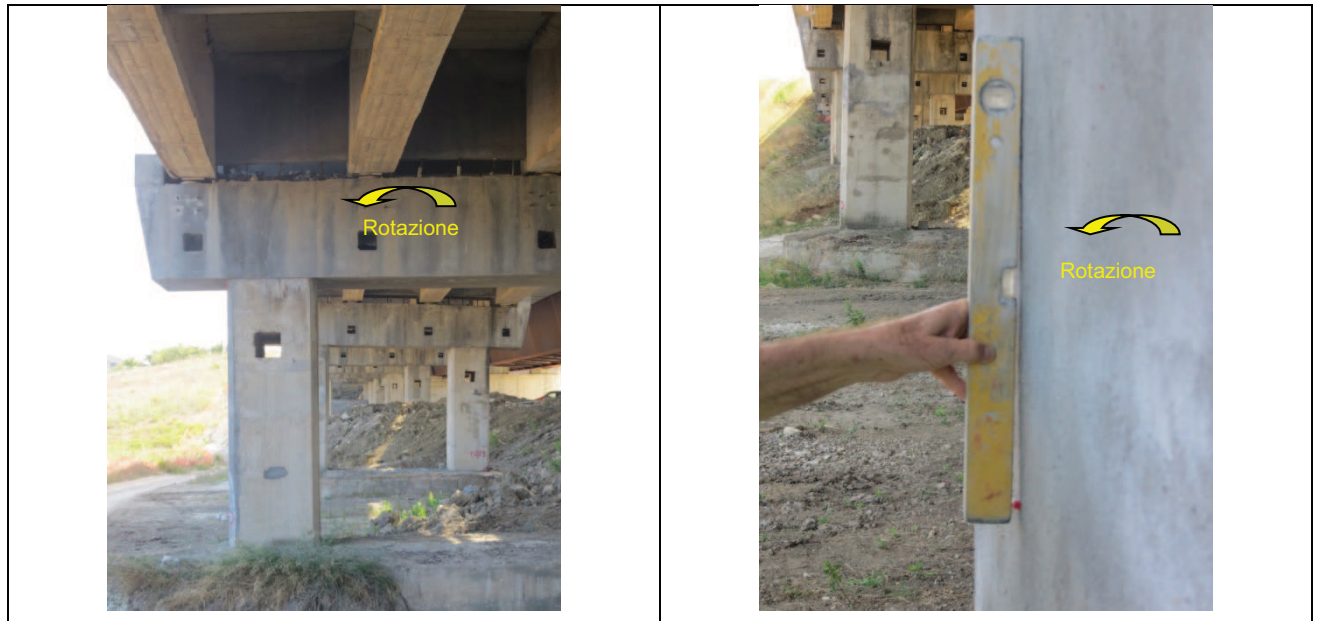
Figura 55: PK 32+474, VIADOTTO ESISTENTE VE15 – MONTAGNOLA 1 E NUOVO VIADOTTO VN05. Vista della pila 2 ruotata verso valle
