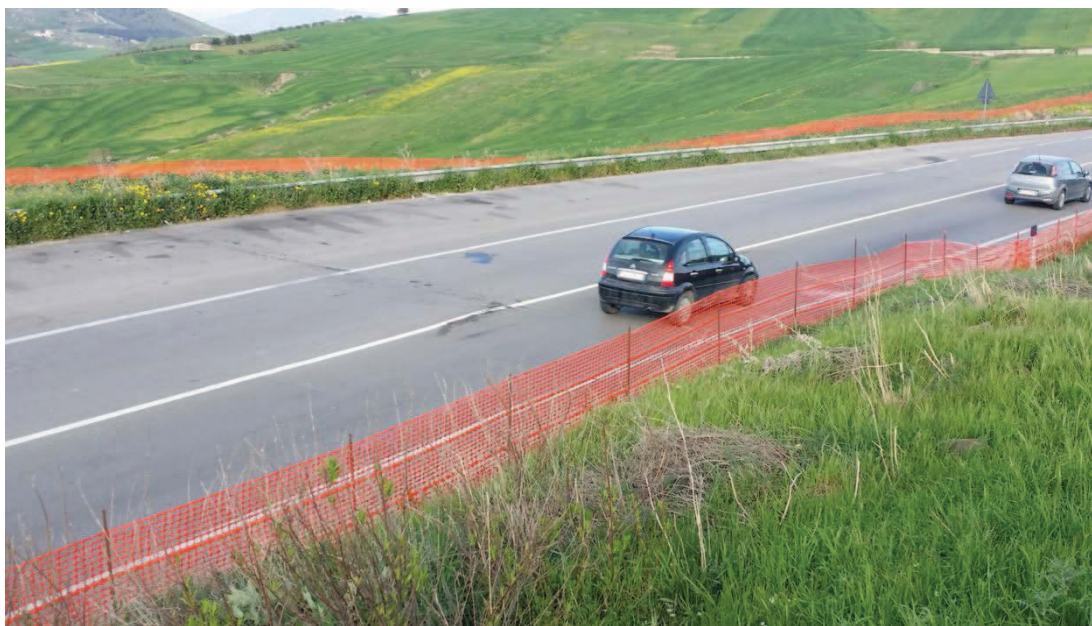
Figura 59: PK 33+077. Evidenti lesioni ed avvallamenti della pavimentazione stradale.
