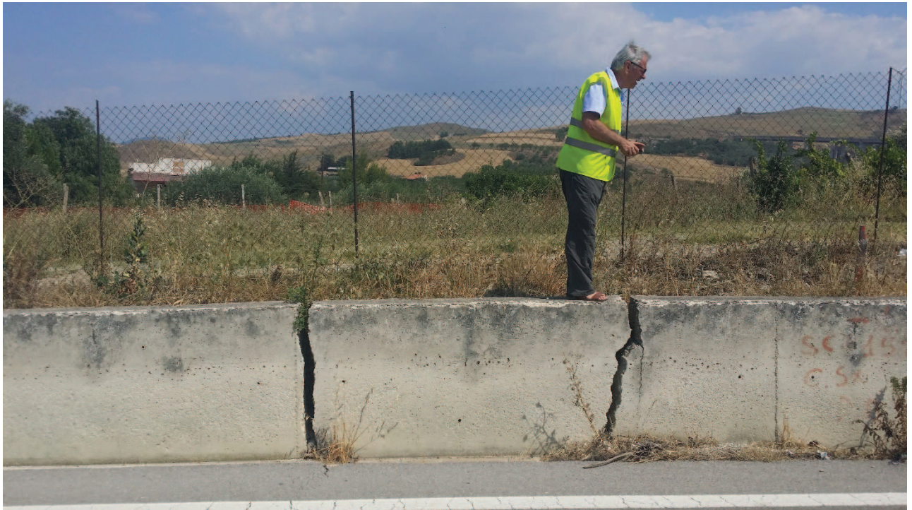
Figura 27: PK 30+357. Evidenze di dissesto sul muro di valle del tracciato stradale attuale.
