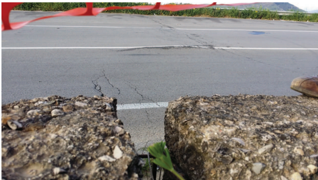
Figura 60: PK 33+077. Evidenti lesioni ed avvallamenti della pavimentazione stradale, con distacco di cordoli e muretti.
