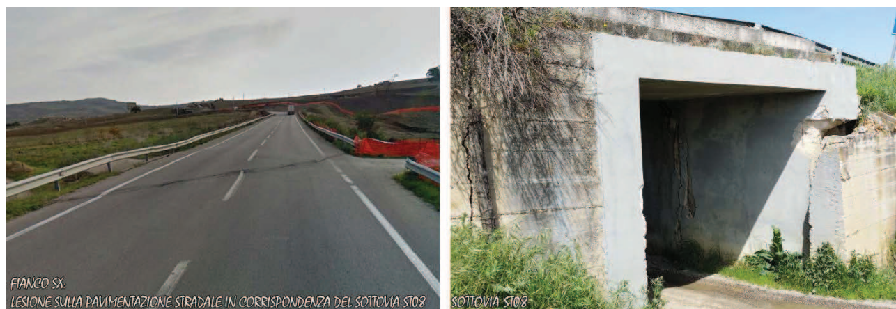
Figura 15: PK 27+730. Evidenze di dissesto in corrispondenza del fianco sinistro del movimento
