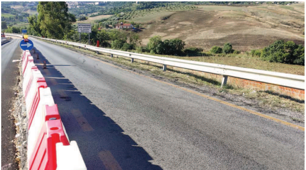
Figura 3: PK 12+657, SVINCOLO MEZZOJUSO. Versante a valle della viabilità.
