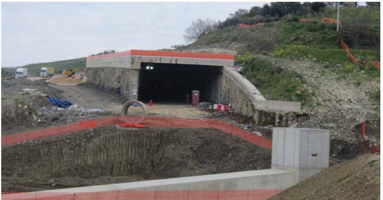
Figura 44: PK 31+518, OPERE OS45B, GALLERIA SAN GIORGIO GA01 E OS46. Vista generale in direzione Agrigento
