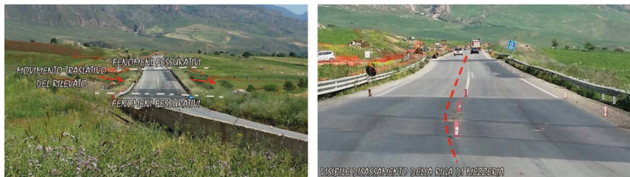
Figura 14: PK 27+730. Traslazione in blocco verso valle del rilevato stradale (1 mt. ca.)
