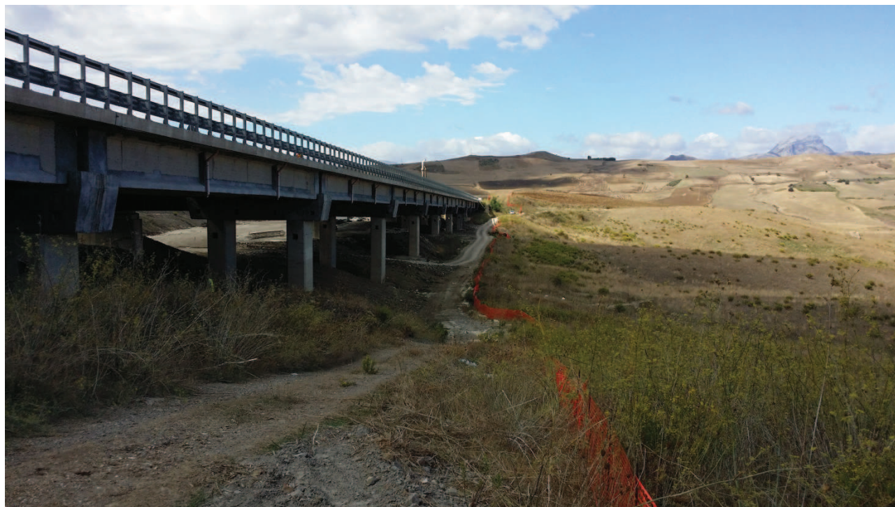
Figura 51: PK 32+474, VIADOTTO ESISTENTE VE15 – MONTAGNOLA 1 E NUOVO VIADOTTO VN05. Area di imposta del viadotto esistente
