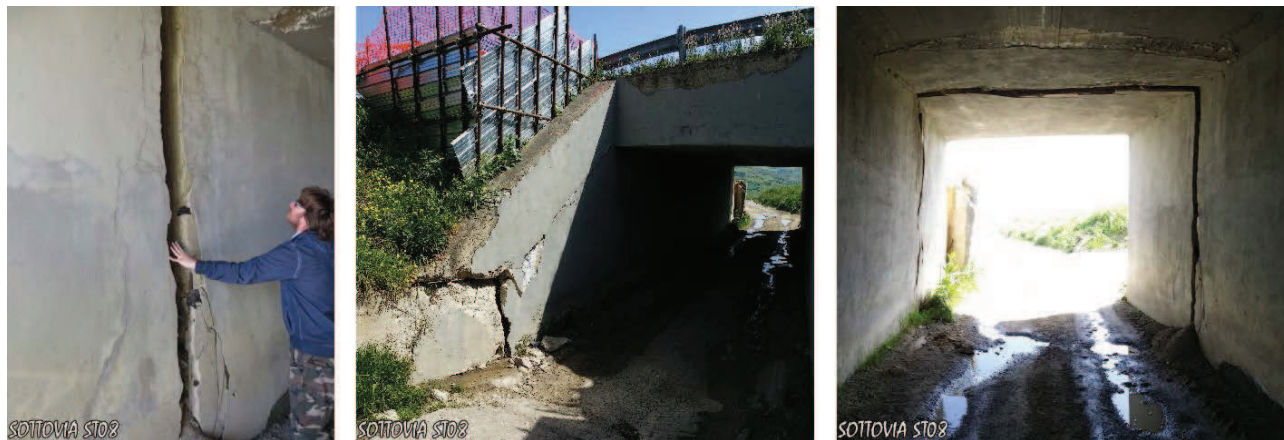
Figura 16: PK 27+730. Evidenze di dissesto in corrispondenza del fianco sinistro del movimento
