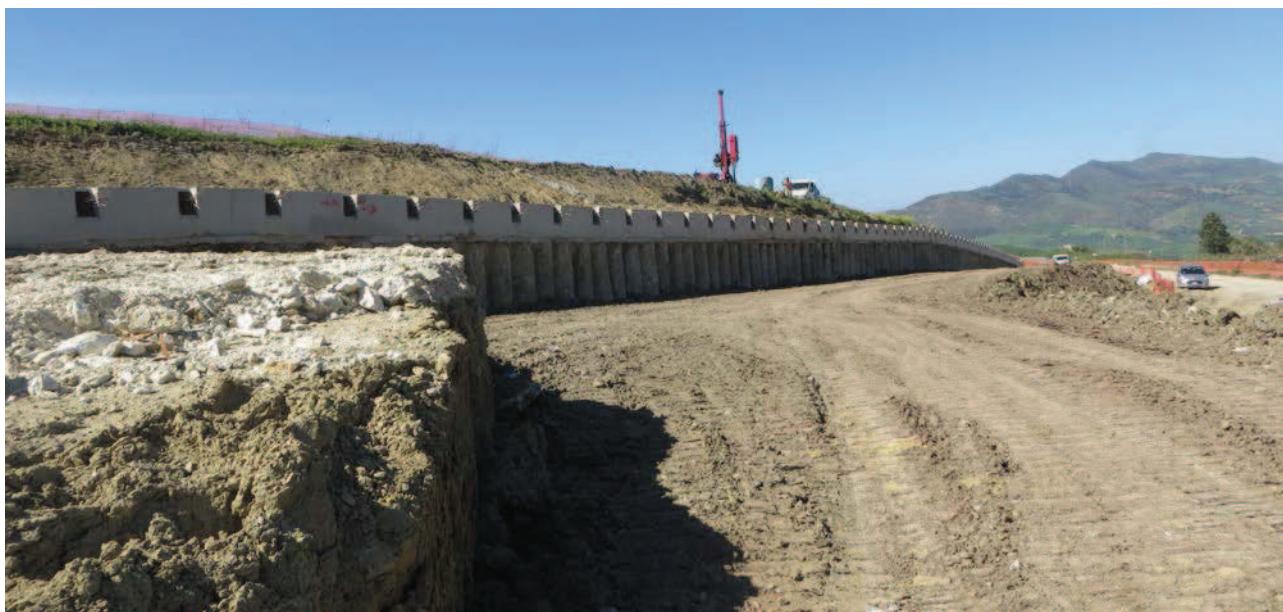
Figura 33: PK 30+550, OPERA OS44 DI PEA E SUCCESSIVA VARIANTE. Vista frontale dell'opera OS44.
