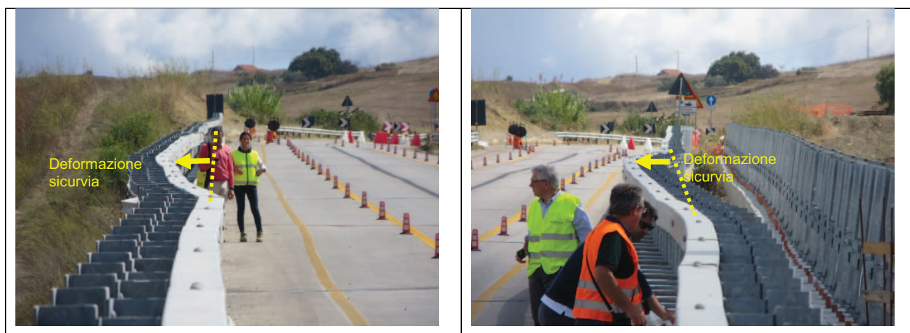
Figura 53: PK 32+474, VIADOTTO ESISTENTE VE15 – MONTAGNOLA 1 E NUOVO VIADOTTO VN05. Deformazione sicurvia
