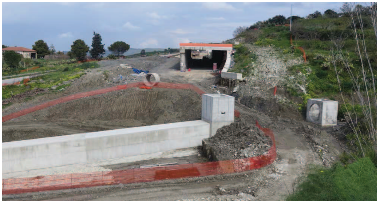
Figura 45: PK 31+518, OPERE OS45B, GALLERIA SAN GIORGIO GA01 E OS46. Vista generale in direzione Agrigento
