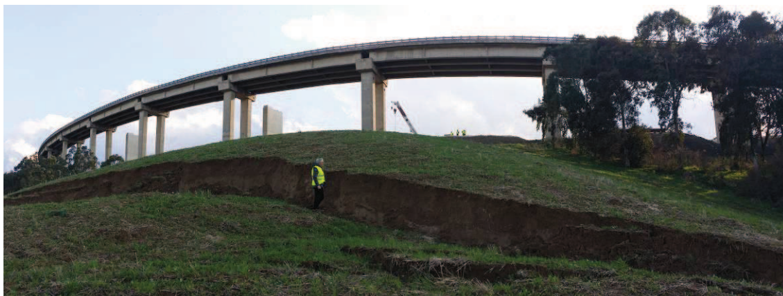
Figura 7: PK 25+917, VIADOTTO ESISTENTE VE10 – FERRUZZE 1. Evidenze di dissesto a valle del viadotto.
