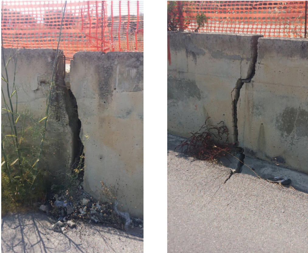
Figura 29: PK 30+357. Evidenze di dissesto sul muro di monte del tracciato stradale attuale.
