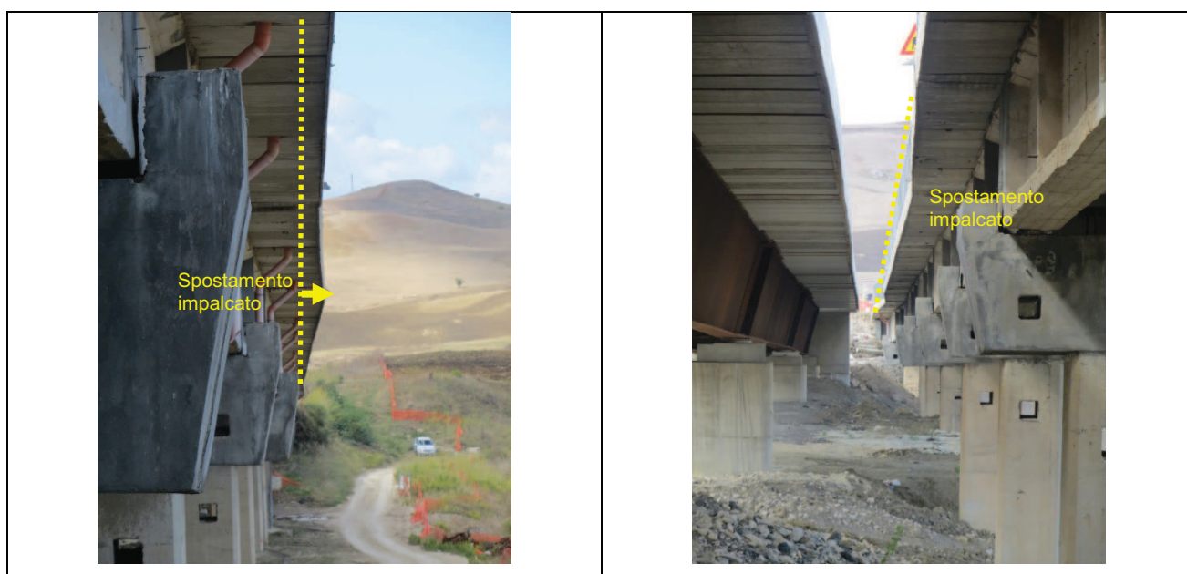
Figura 54: PK 32+474, VIADOTTO ESISTENTE VE15 – MONTAGNOLA 1 E NUOVO VIADOTTO VN05. Deformazione impalcato
