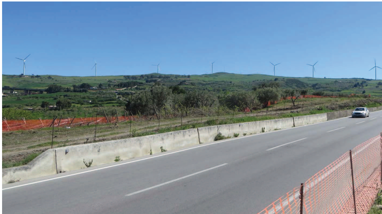
Figura 25: PK 30+357. Evidenze di dissesto sul muro di valle del tracciato stradale attuale.
