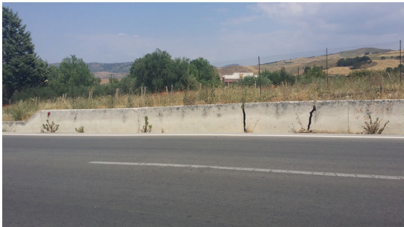
Figura 26: PK 30+357. Evidenze di dissesto sul muro di valle del tracciato stradale attuale.
