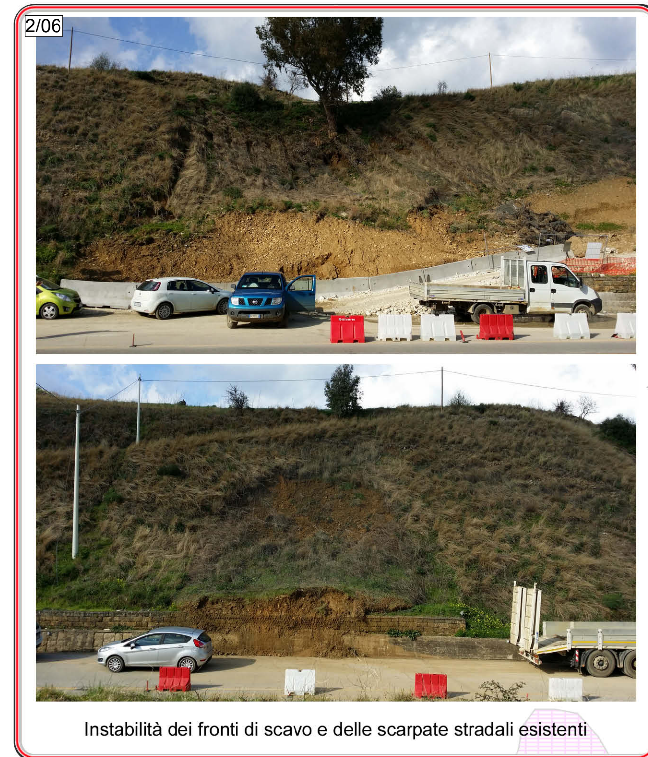
2/06 Fenomeni erosivi sul corso d'acqua con conseguente instabilità del versante e potenziale coinvolgimento della sede stradale in progetto
