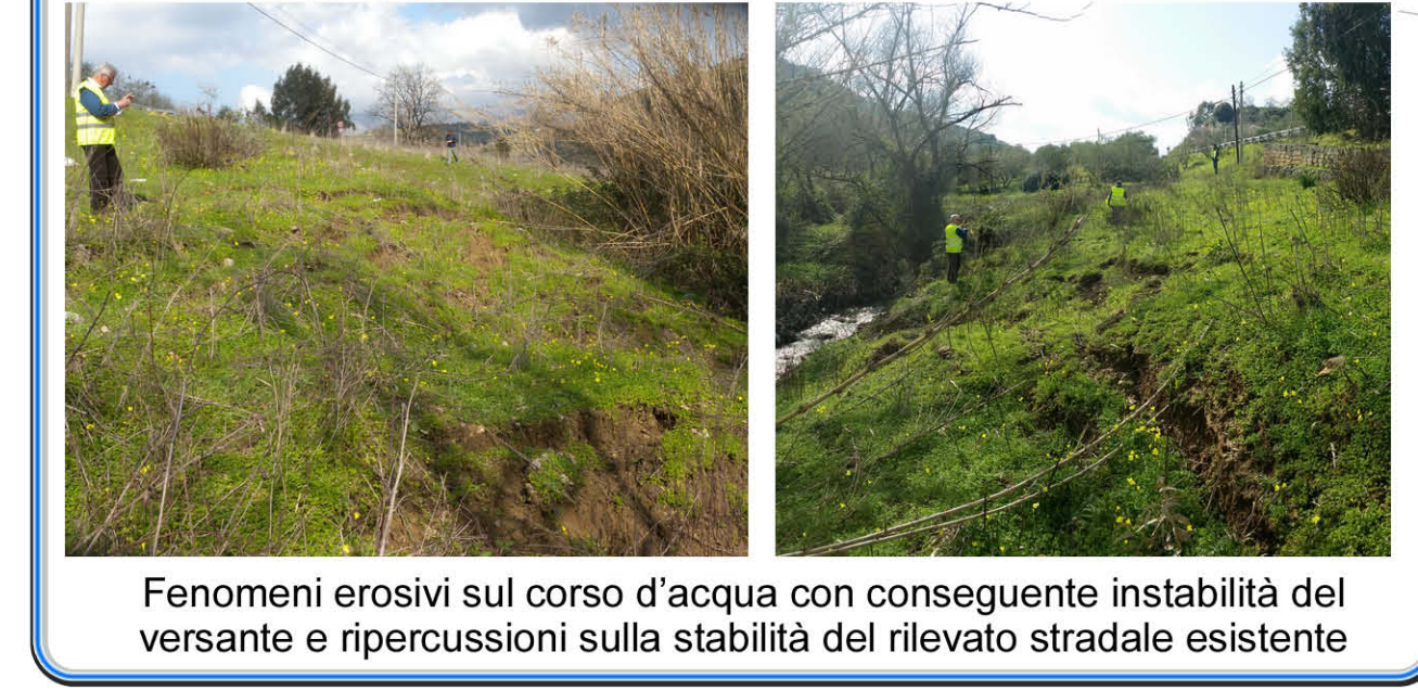
2/05 Fenomeni erosivi sul corso d'acqua con conseguente instabilità del versante e ripercussioni sulla stabilità del rilevato stradale esistente
