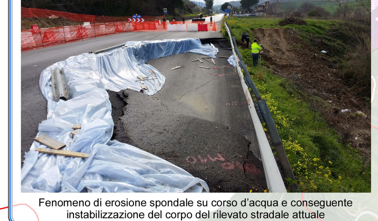
2/11 Fenomeni erosivi su corso d'acqua in prossimità del tracciato stradale in progetto
