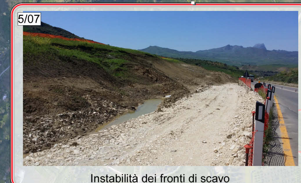
5/06 Instabilità dei fronti di scavo
