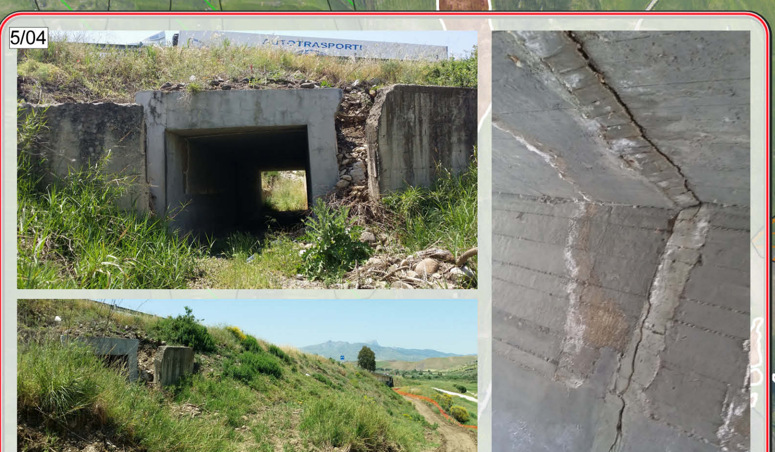
5/04 Fenomeni di instabilità di versante con ripercussioni sulla stabilità del rilevato stradale ed evidenti lesioni e dissesti sui manufatti esistenti
