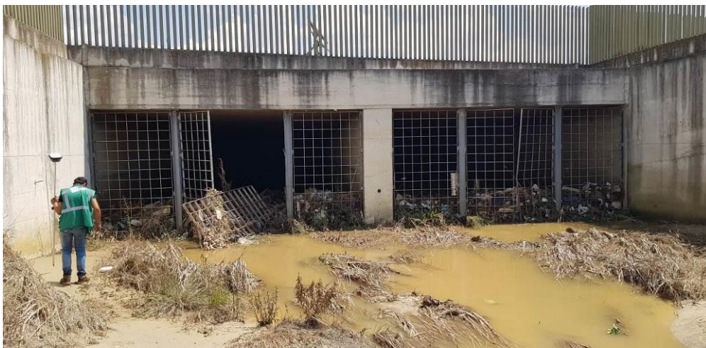
Figura 42 - Fosso delle Monache: Cancellate di sicurezza a monte del tombino di attraversamento
