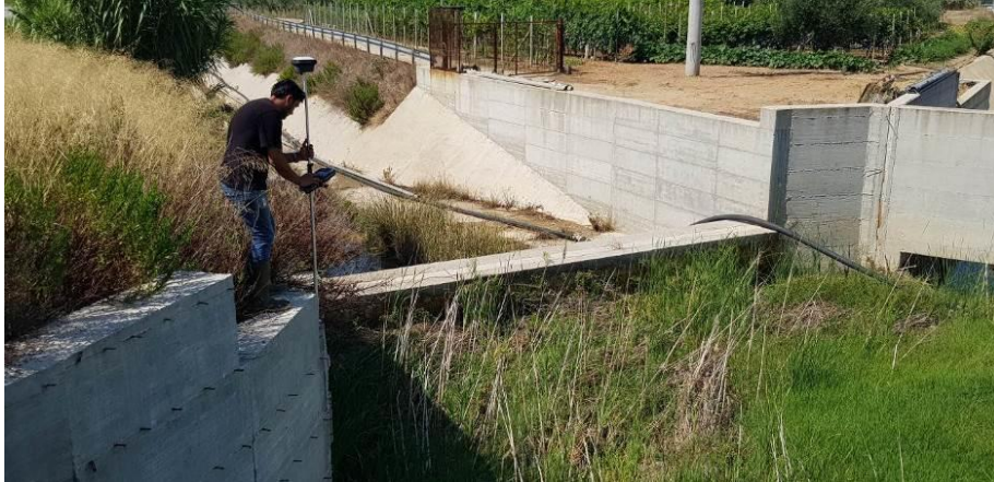
Figura 27 - Partitore a monte del Fosso Madonna del Prato (vista verso valle canale deviatore)
