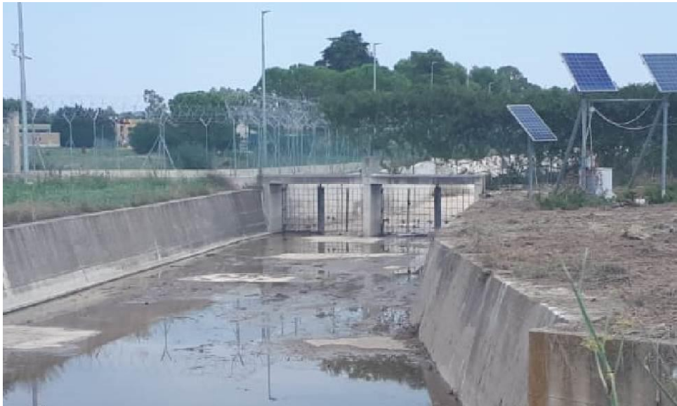
Figura 41 - Fosso Madonna del Prato: Cancellate di sicurezza a monte del tombino di attraversamento
