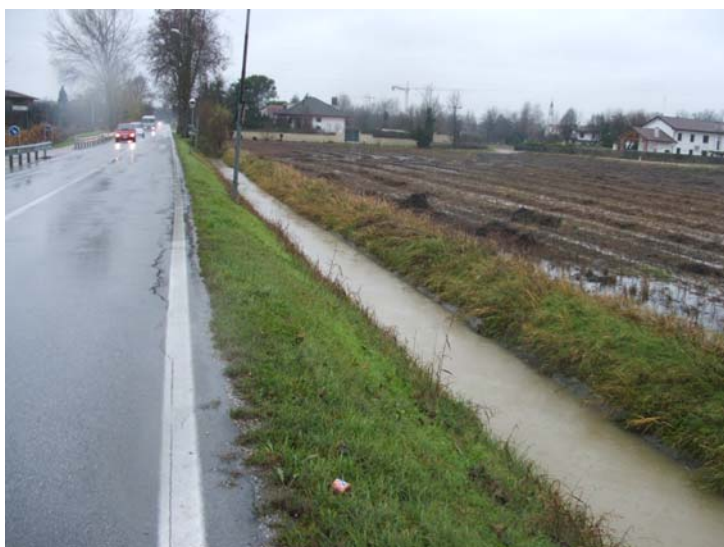
Figura 12- Collettore Bazzera a sud del ponte sul Dese in via Ca' Nove (11 dicembre 2008)
