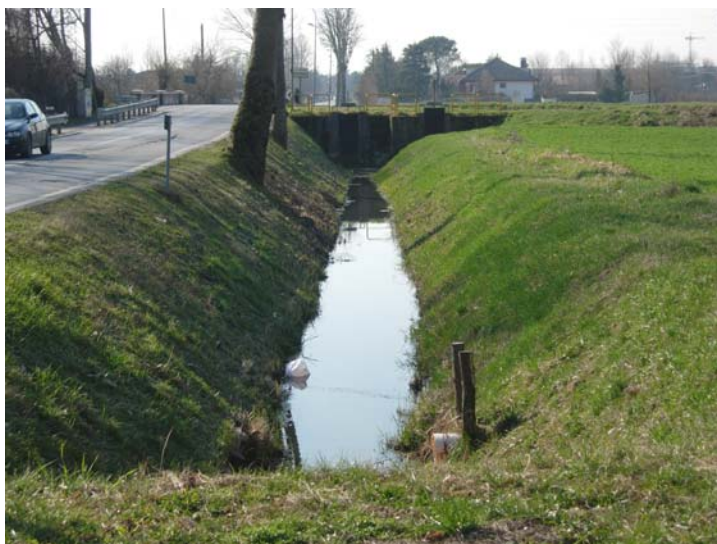
Figura 4-Collettore di Via Ca'Nove nel tratto a monte della botte a sifone che sottopassa il fiume Dese
