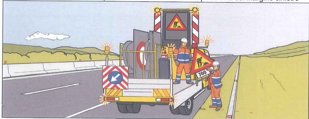
Chiusura della corsia di sorpasso: scarico e installazione del segnale lavori sul margine destro
