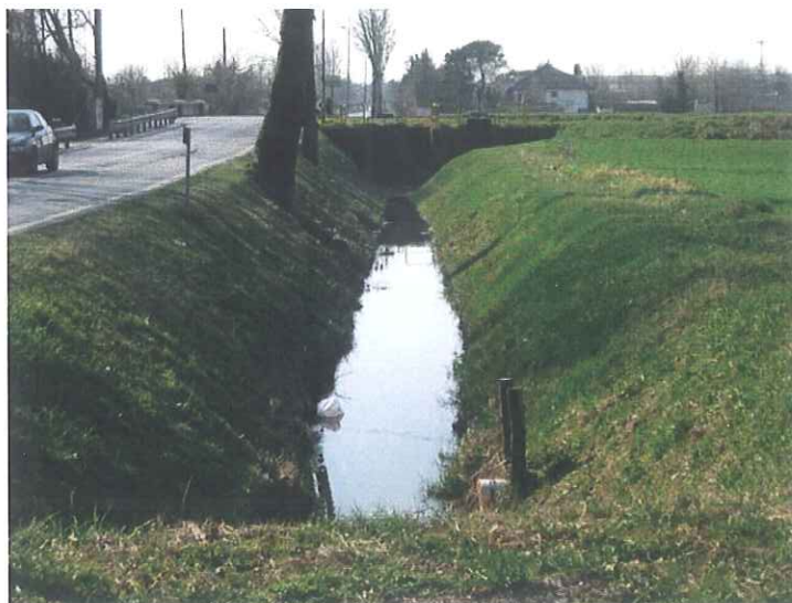
Figura 4-Collettore di Via Ca'Nove nel tratto a monte della botte a sifone che sottopassa il fiume Dese
