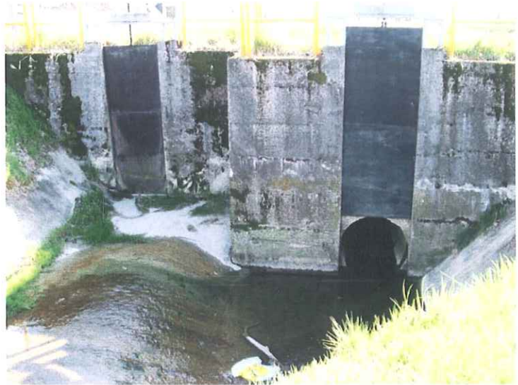
Figura 5- Collettore di Via Ca' Nove e ingresso nella botte a sifone
