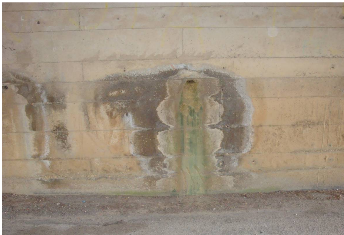
Foto 4 – Vista spalla – infiltrazioni
