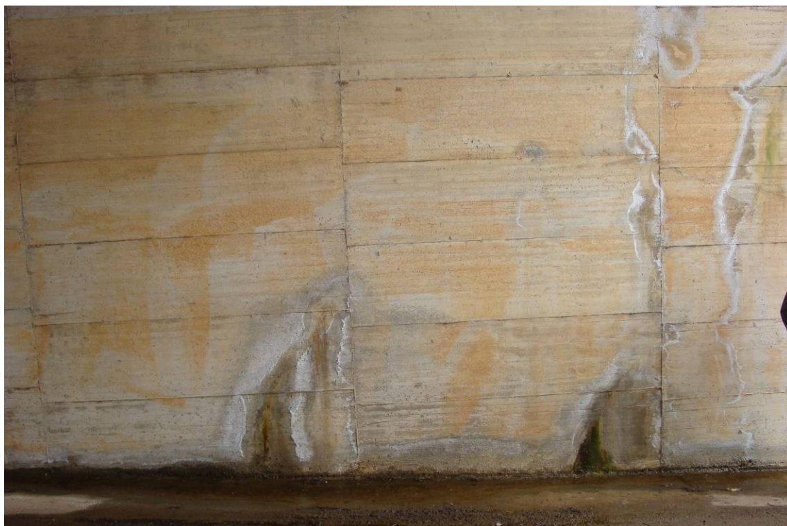
Foto 3 – Vista spalla - infiltrazioni
