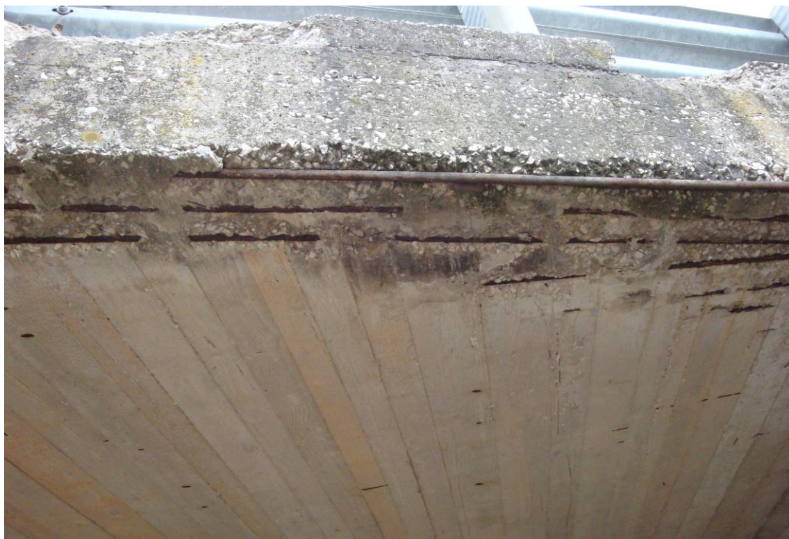
Foto 3 – Vista intradosso – armature scoperte
