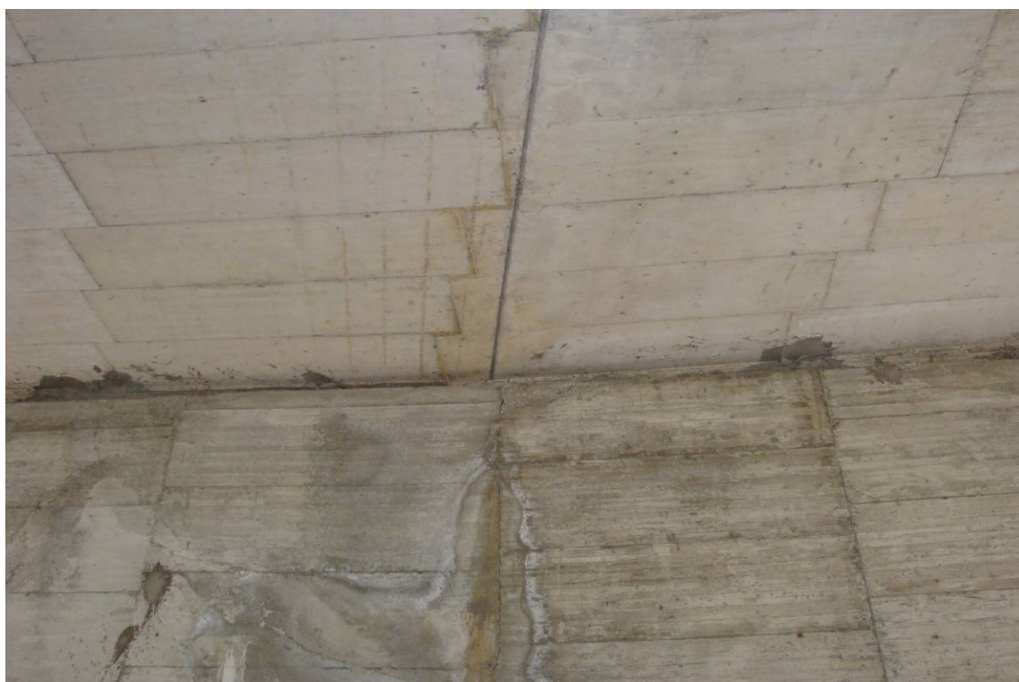
Foto 4 – Vista attacco solettone – spalla: infiltrazioni
