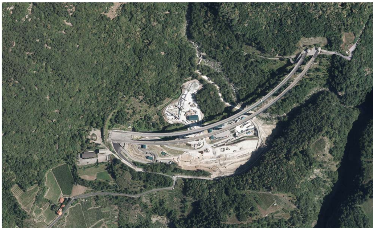
Figura 13 – Foto aerea dell'area de La Maddalena attualmente interessata dal cantiere per la realizzazione del Cunicolo Esplorativo
