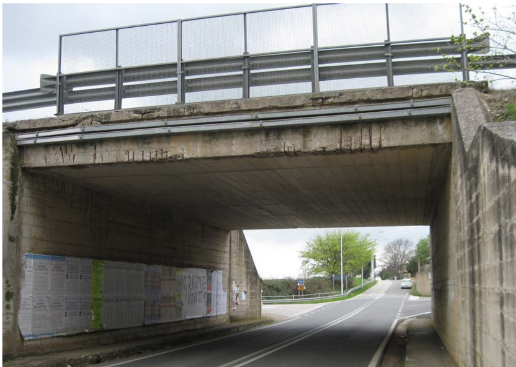
Vista laterale: armatura scoperta
