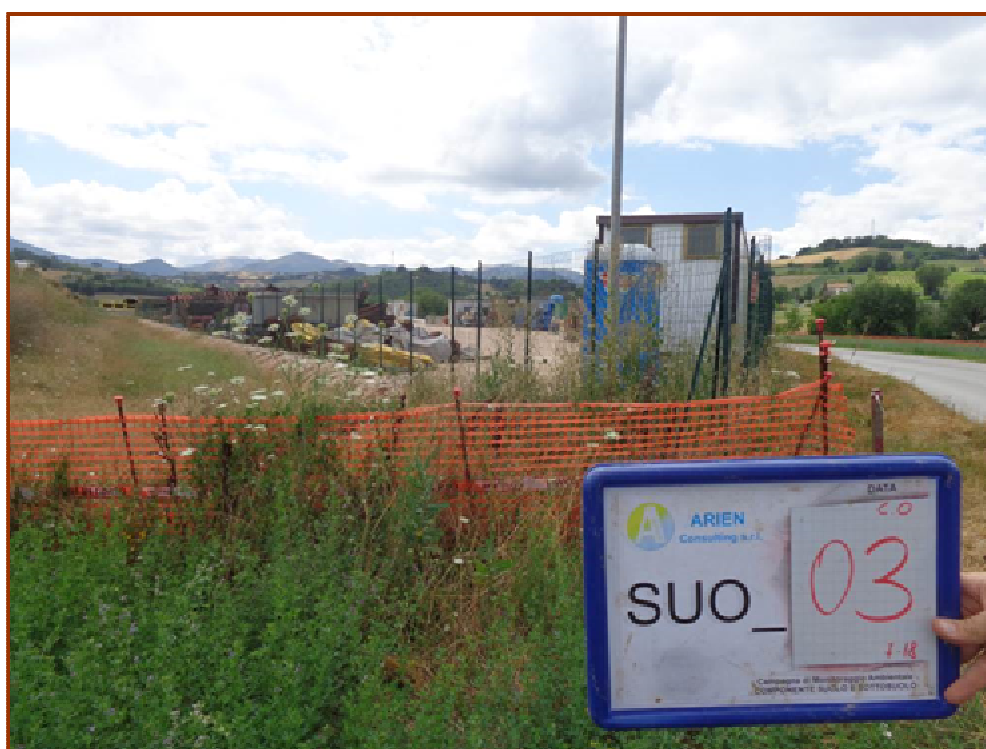
Stazione di campionamento SUO_03 Area di cantiere e cantiere base "Cerreto D'Esì"
