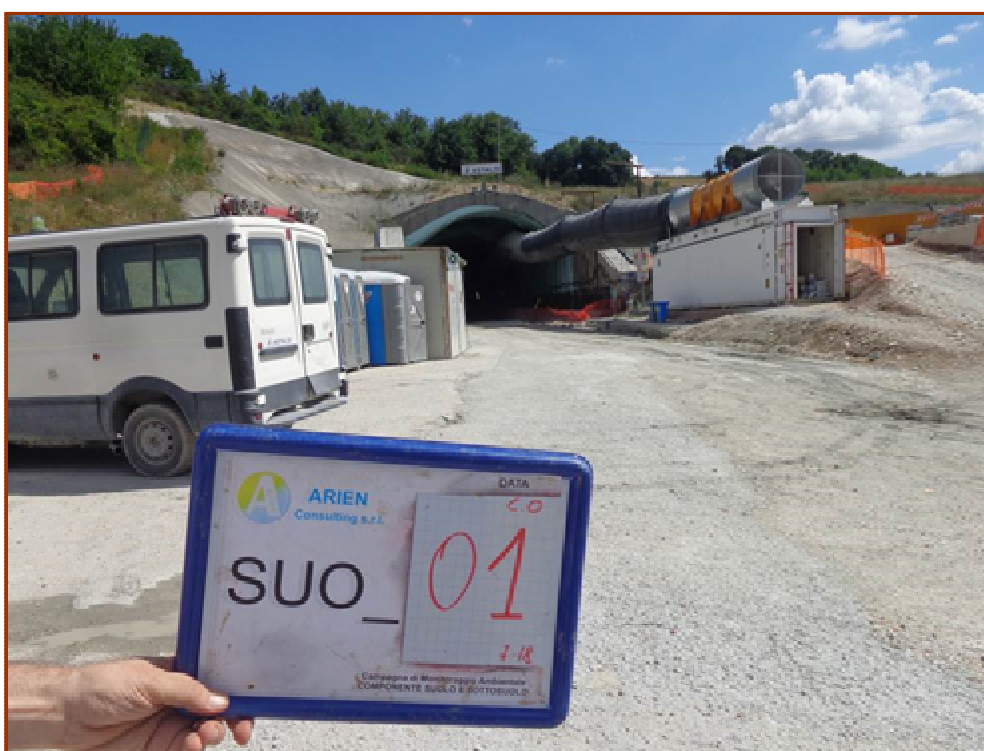
Stazione di campionamento SUO_01 Area di cantiere per lo scavo galleria "Le Serre"
