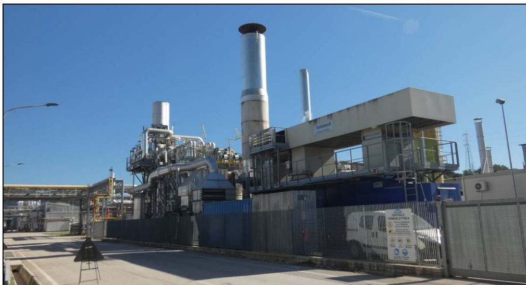
Figura 4.7.4/1 Stabilimento Alcantara - Impianto già in esercizio presso la Centrale Engie ed analogo a quello di prevista realizzazione
