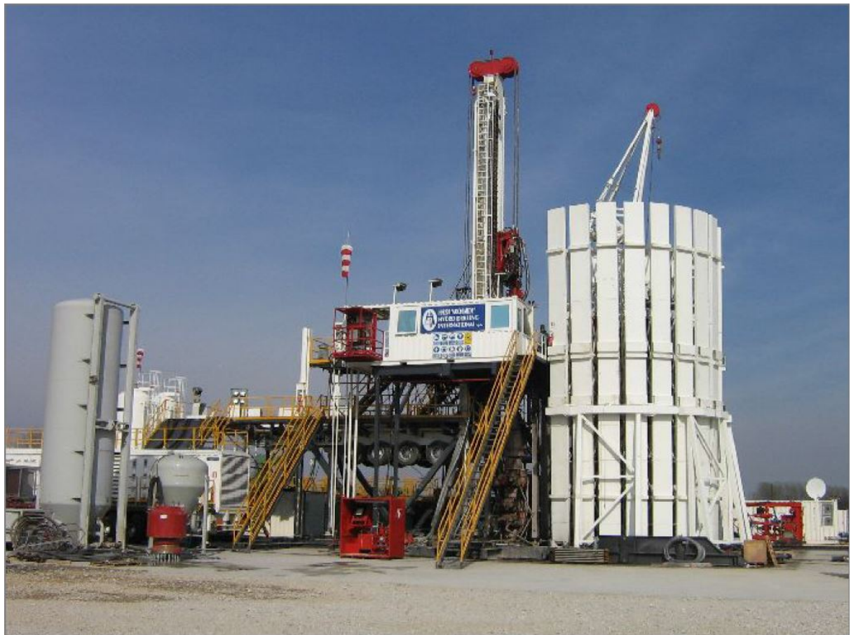
Fig. 6 L'impianto HH 220 FA
